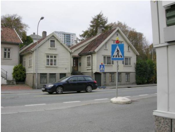
Disse to husene i Strandgata 22 og 24 begynner å bli merket av manglende funksjon. Særlig er taket dårlig. Norestraen er regulert til spesialområde bevaring. (1102-001-019,-021)
