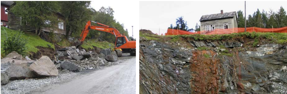
1401-0115-003. Til venstre vegarbeid på Rv. 5 ved Eikefjorden. Det gamle våningshuset må vel betegnes som sterkt truet. Til høyre vegarbeid på Rv. 5 vest for Storebru. Vegen rettes her ut, driftsbygningen var allerede revet og våningshuset (1401-0102-030) står trolig for tur.
