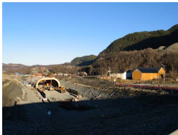
Fra arbeidet med ny E6 sør for Melhus kirke høsten 2003. Den valgte traséen for ny E6 går parallelt med den gamle, og berører sentrale kulturmiljøer i Melhus. Gården til høyre er Hofstad, som har flere gamle hus, men de er ikke registrert i SEFRAK.
