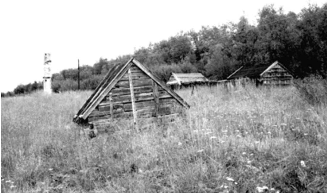
Stabbur (2011-007-001-003) på fraflytta boplass i Máze på østsida av Kautokeinoelva. Til venstre pipa etter bolighuset. To av stabbura er i dårlig stand og må betegnes som sterkt truet.
