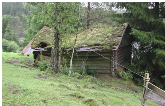
0420-003-056. Torvtaket på kjellerbua over potetkjelleren er i dårlig forfatning. Flere av de registrerte kjellerbuene har gått tapt, og mange av de gjenstående er trua av forfall.
