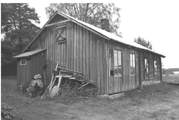
0420-013-036. Smia på Repseth ble etter hvert utvidet med et snekkerverksted. Ved SEFRAK-registreringen var taket var dårlig, og i 2002 var huset borte. Hus tilknyttet håndverk har blant de høyeste tapsprosentene.
