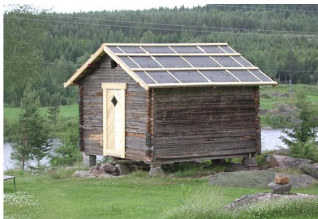
0420-009-009. Stabburet som står på et opprinnelig småbruk var under oppussing i 2002. Taket er under omlegging, kledningen på fronten er fjernet og ny dør satt inn. Bolighuset og kjellerbua står fremdeles, stallen var revet og tunområdet planert og plen anlagt.
