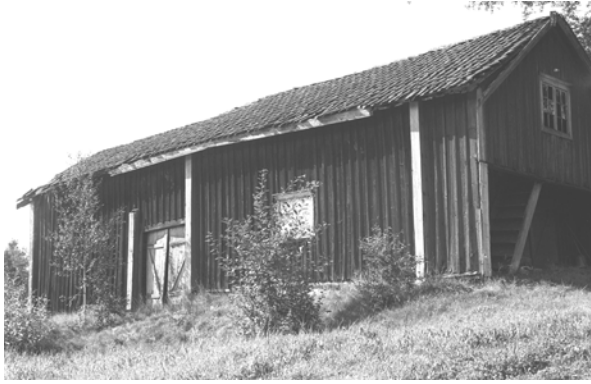
0420-018-053. Den store kjellerbua hadde vært lite i bruk over år, og var i dårlig stand da den ble revet. Kjellerbuene er ei utsatt gruppe, også på de større gårdene.
