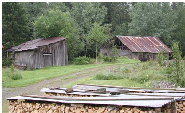
0420-001-002. Driftsbygningen på Vangen, plass under Saugbruksforeningen, var i dårlig stand ved SEFRAK-registreringen. Siden har låvedelen (i midten) rast sammen, tilbake står stall og skåle.
