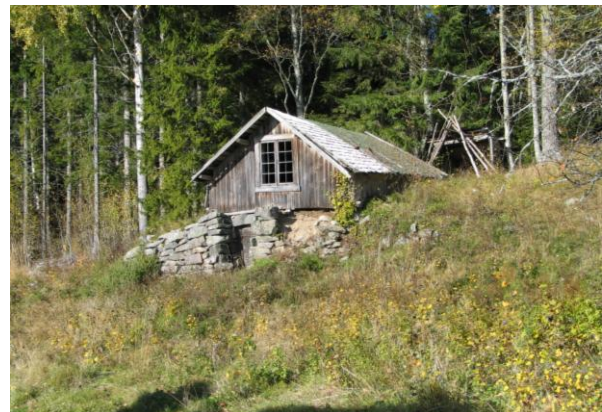
Utkjellere er også en utsatt gruppe. Huset har rester av dårlig flistak og murene sklir ut. Utkjellere er en karakteristisk hustype i Eidskog.(0420-005-008)
