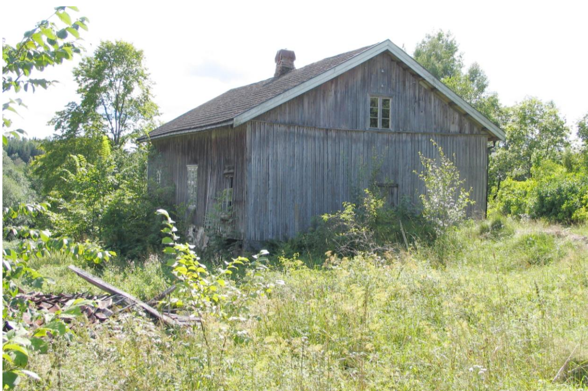
Våningshuset på Hillestad var skysstasjon og vertshus, noe huset bærer preg av. Det var bebodd ved registreringen i 1991, men har nå stått tomt i flere år og bærer preg av det. Den meste kritiske delen av huset gjelder hjørnet nærmest i bildet med bryggerhus og bakerovn. Situasjonen er omtrent som i 2004, men det er nå bestemt at huset skal settes i stand. (0702-310-006) Huset er del av et miljø som markerer Hillestad gamle sentrum og som sammen med kirken og Hillestad Landhandleri, er framhevet i kommunedelplanen for Hillestad 2008–2020 som et område av stor kulturhistorisk verdi.
