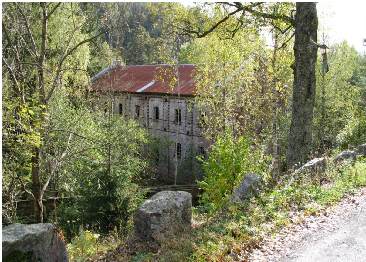
Sliperbygningen ved Stifoss i nedre del av Gjerstadvassdraget er den siste gjenværende av de store eldre industribygningene i Gjerstad. Driften tok slutt i 1949. Den preges av lekkasjer fra tak og knuste vinduer. (0911-102-037)
