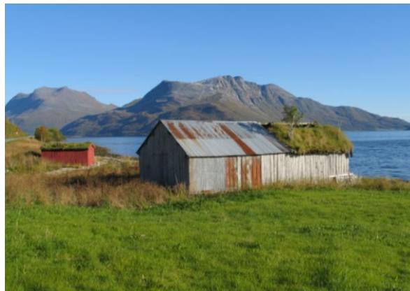
1902-4001-024. Fembøringsnaust ytterst i Straumsfjorden. Huset sto også med en liten del av taket torvtekt ved registreringen i 1989. I 2006 var denne delen i svært dårlig stand.
