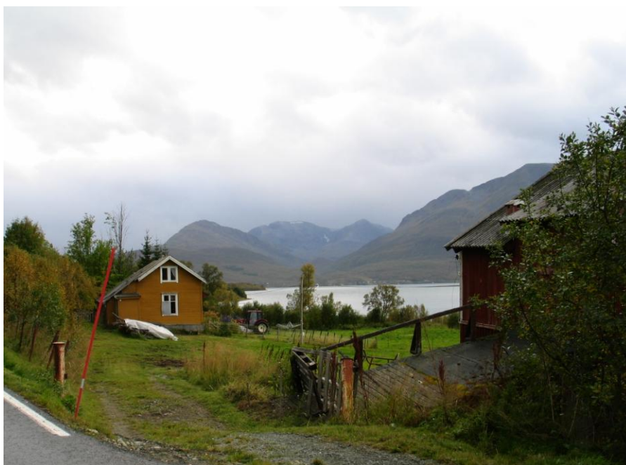
1902-3302-001. Stuebygning ved Sør fjorden i Ullsfjord. Huset var først skolestue i Lakselvdalen, men ble flytta hit før 1900 og tatt i bruk som bolig. Den var ikke i bruk ved registreringen i 1993, og tilstanden bar alt da preg av at den hadde vært uten funksjoner ei tid.
