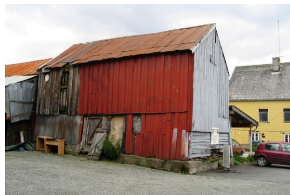
1902-107-032. Bakgårdshus i Tromsø sentrum som har preg av dårlig vedlikehold. Det tilhørte en kjøpmann og var i bruk som lager ved registreringen. Tidligere har det rommet flere funksjoner.
