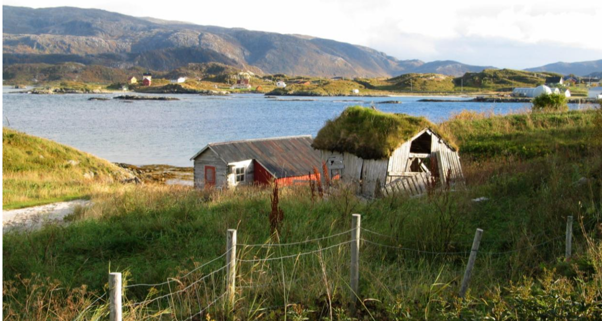
1902-4104-024. Anemark på Sommarøy. Ved registreringen i 1989 var huset i bruk som vedsjå, men det skal være bygd som småkrøtterfjøs på 1880-tallet. Det begynner nå å bli merket av manglende funksjon over tid.
