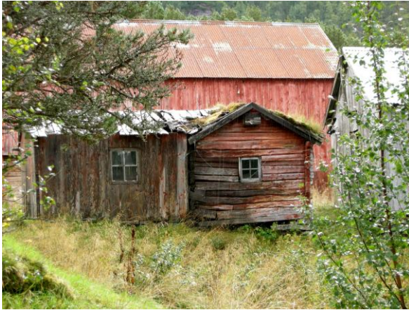
1840-110-009. Eldhus som etter hvert har fått funksjon som uspesifisert lagerhus. Særlig taket er dårlig. Den tømra delen er opprinnelig ei gammel bekkvern som er flyttet hit.
