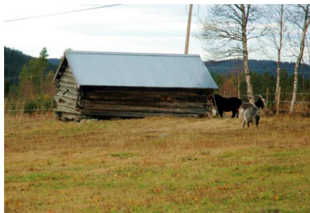
Sommerfjøset på Klokkargarden på Krokstad i Hølonda var i bruk til 1958. Det er nå merket av råte i flere stokker og i ferd med å sige sammen. Det er registrert relativt få hus i denne kategorien i Melhus, og andelen i dårlig stand ligger over gjennomsnittet. (1653-027-054)
