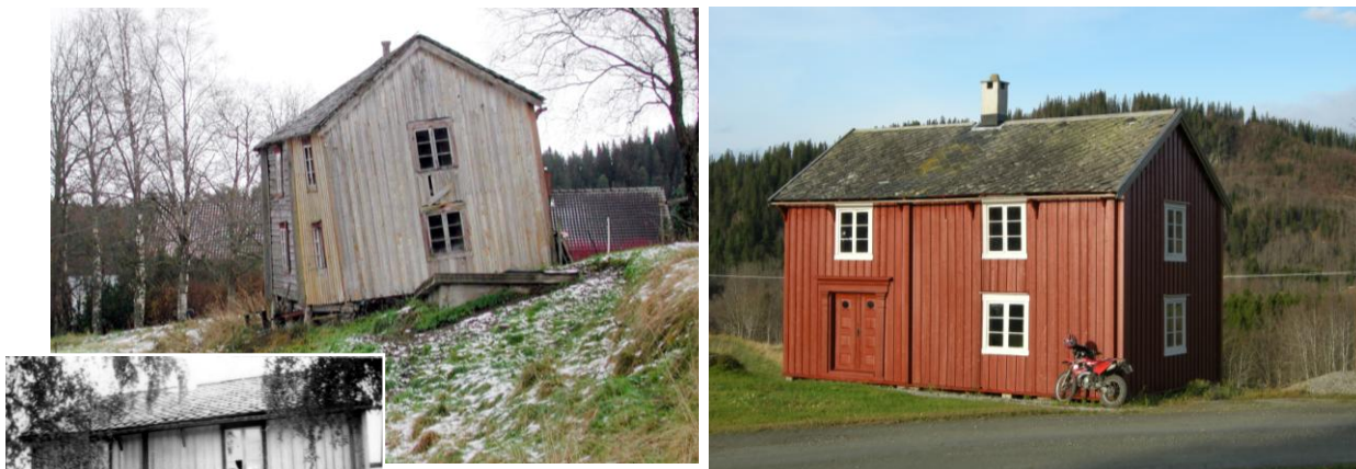
Masstua på Engan i Flå sto utsatt til på skakke ved 1. omverv. Den er nå jekket på plass og satt i stand. Situasjonen ved SEFRAK-registreringen i 1979 til venstre. (1653-015-034)
