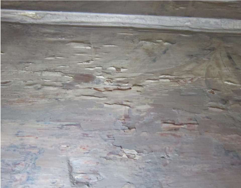
Foto: Detalj av østvegg i kor. Løs maling
