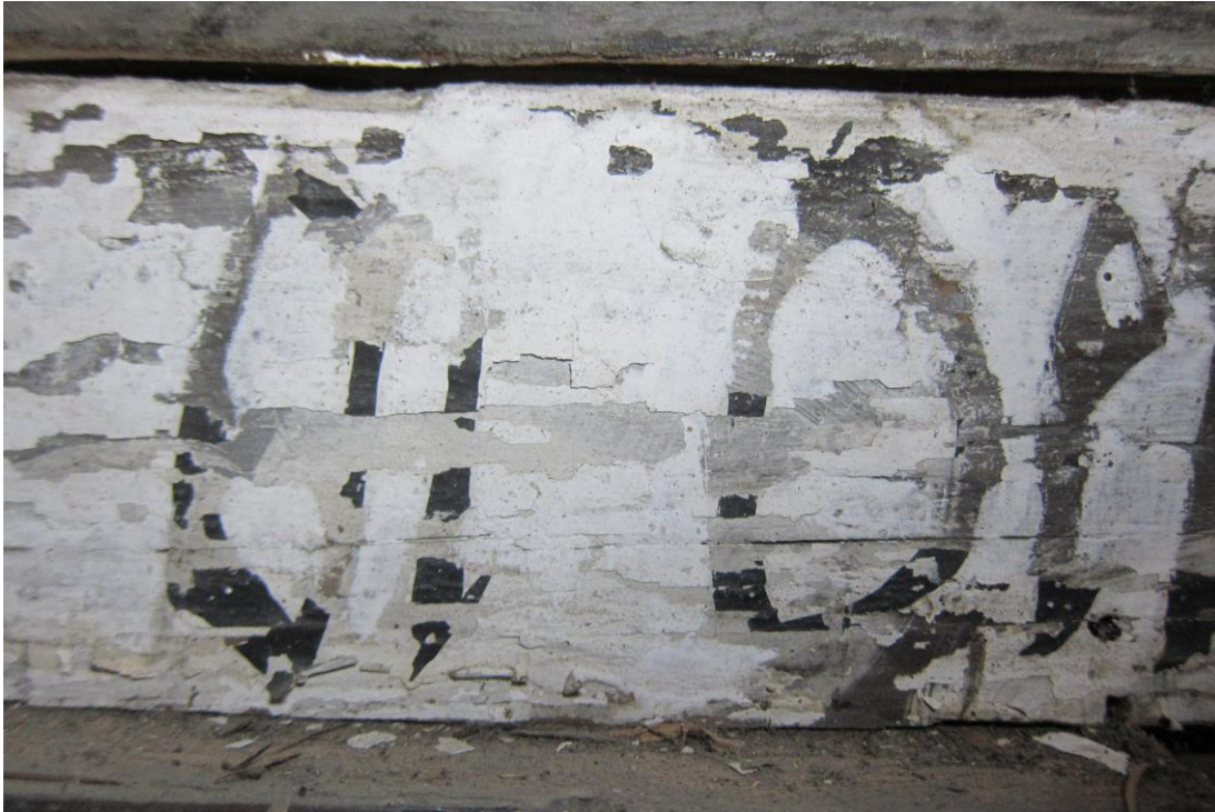
Foto: Detalj av skriftfeltet fra korbuen i skipet. Skriftfeltet ser ut til å være malt over en annen dekor. Gamle utfall ser ut til å være retusjert med hvitt, slik at den grå fargen fra dekoren under, danner resten av bokstavene.
