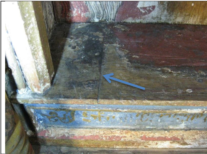
Bildet viser venstre side av bunnen i alterskapet med den påskjøtte delen. Skjøten er markert med pil.
