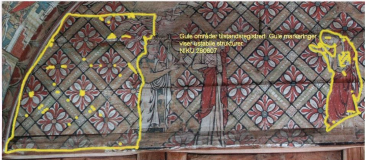
Fig.3. Torpo stavkirke, limfargedekor i baldakinen. Tilstandsregistrering (løs maling merket med gult) på baldakinens gavl. NIKU 260607.
