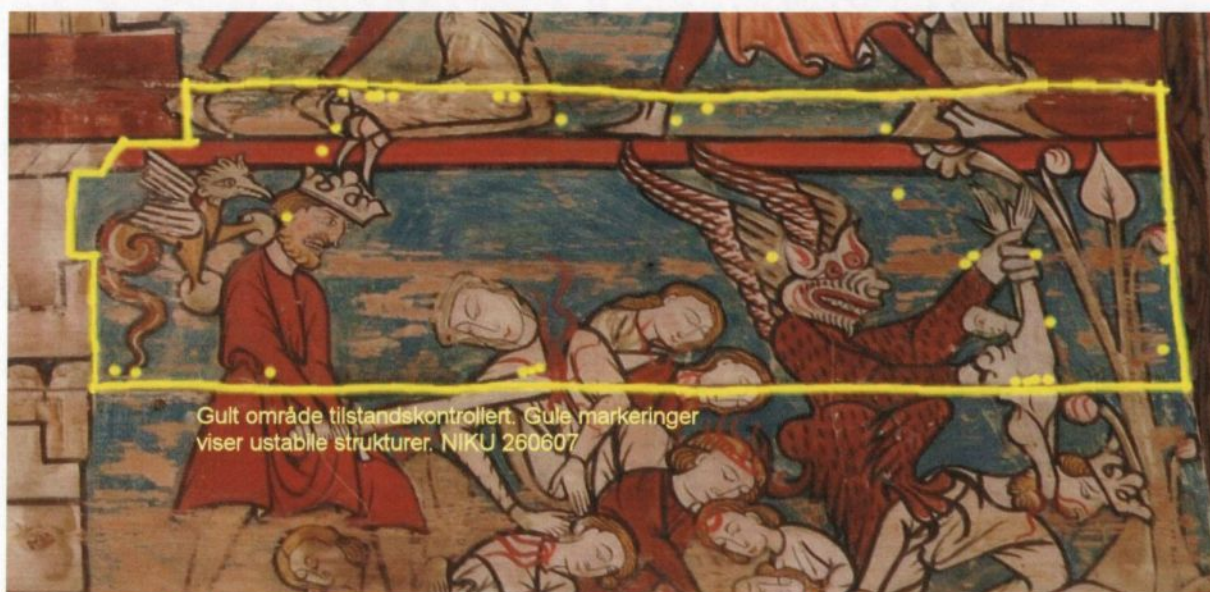
Fig. 2. Torpo stavkirke, limfargedekor i baldakinen. T tilstandsregistrering (løs maling merket med gult) på baldakinens sydvegg. NIKU 260607.
