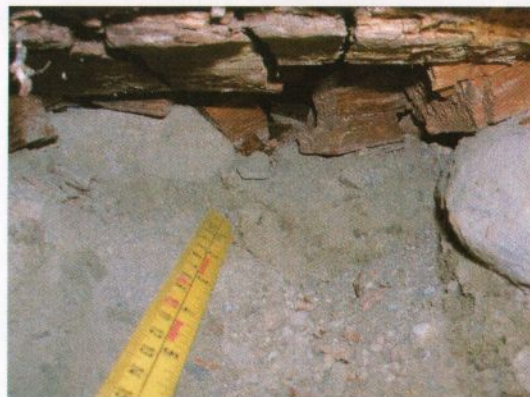
Fig. 8 Underkant av del av østre syllstokk med klare råteskader
