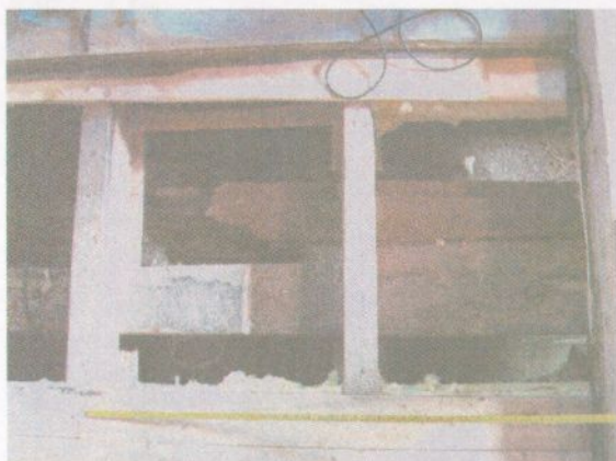
Fig. 10. Vestre grunnstokk har store råteskader.
