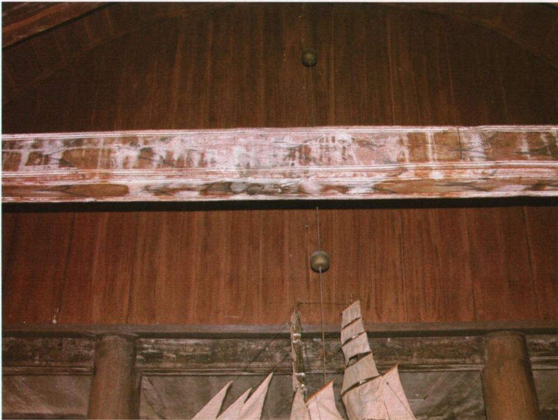
Figur 4. Takbjelke i bakre del av skipet. Bjelken har vannskadet limfargedekor som bør renses og konsolideres. Foto: KSo - 2006
