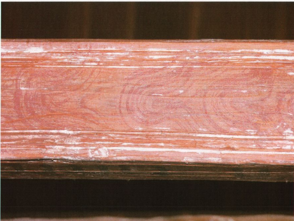
Figur 10. Undersidene til de to bjelkene med innskrift har en ådring i limfarge på undersiden. Rester av hvit overmaling ses særlig i profilene langs kantene. Foto: KSo -2006
