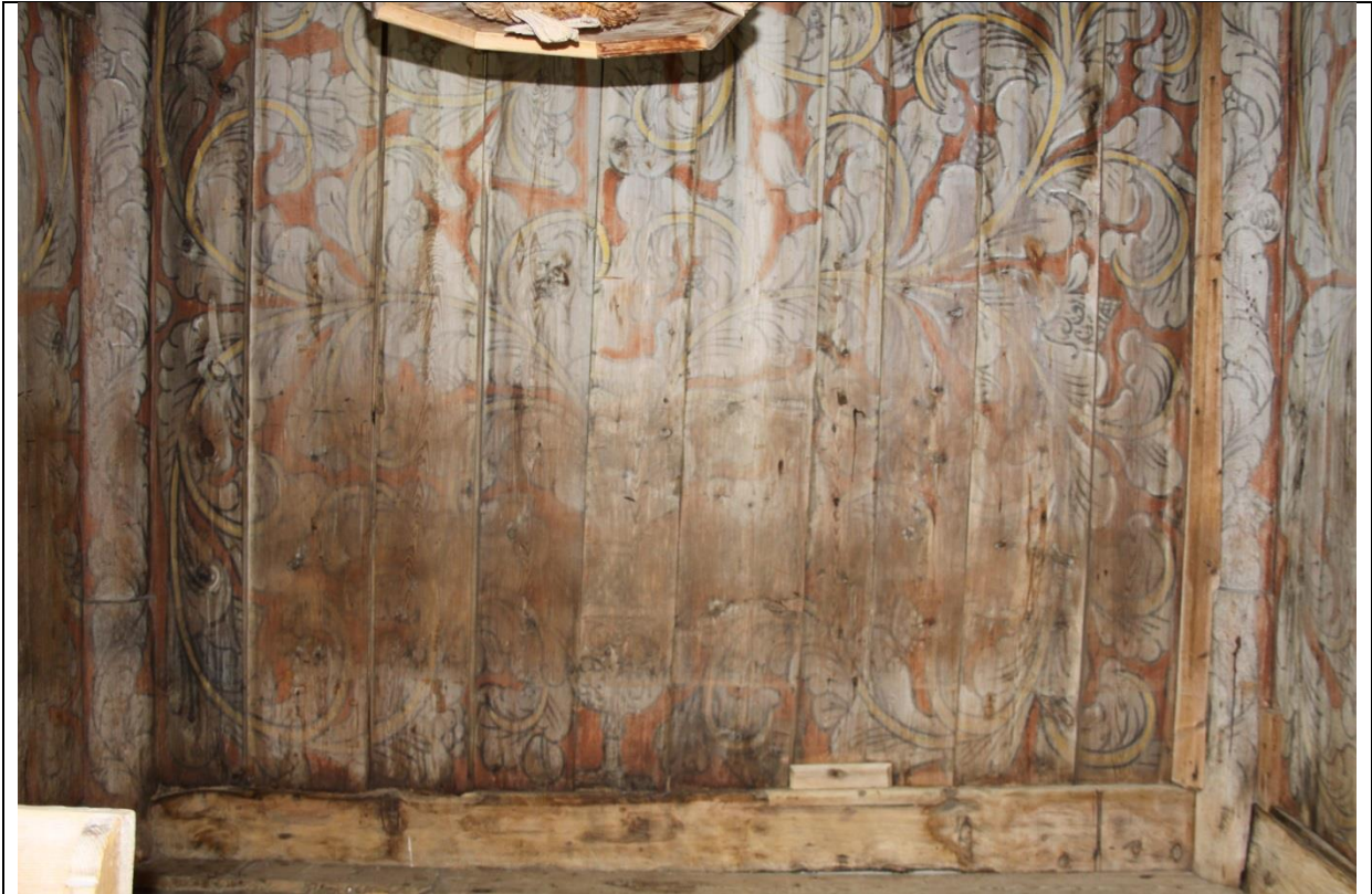
Vestvegg i koret med tydelig slitasje etter tidligere benk langs veggen.
