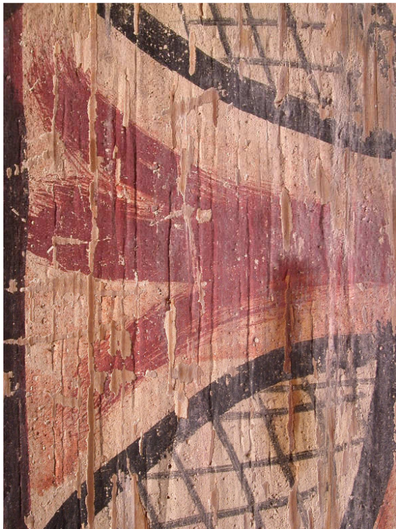
Figur 15. Detalj av panel 2 før konsolidering. Bildet viser rygger av oppskallet maling i treverkets fiberretning.
