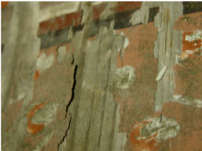
Figur 6. Detalj før konsolidering, fra partiet like ovenfor figur 5, med avskallinger og løs maling, samt store mengder støv og skitt. Foto: NIKU, KSo 2007
