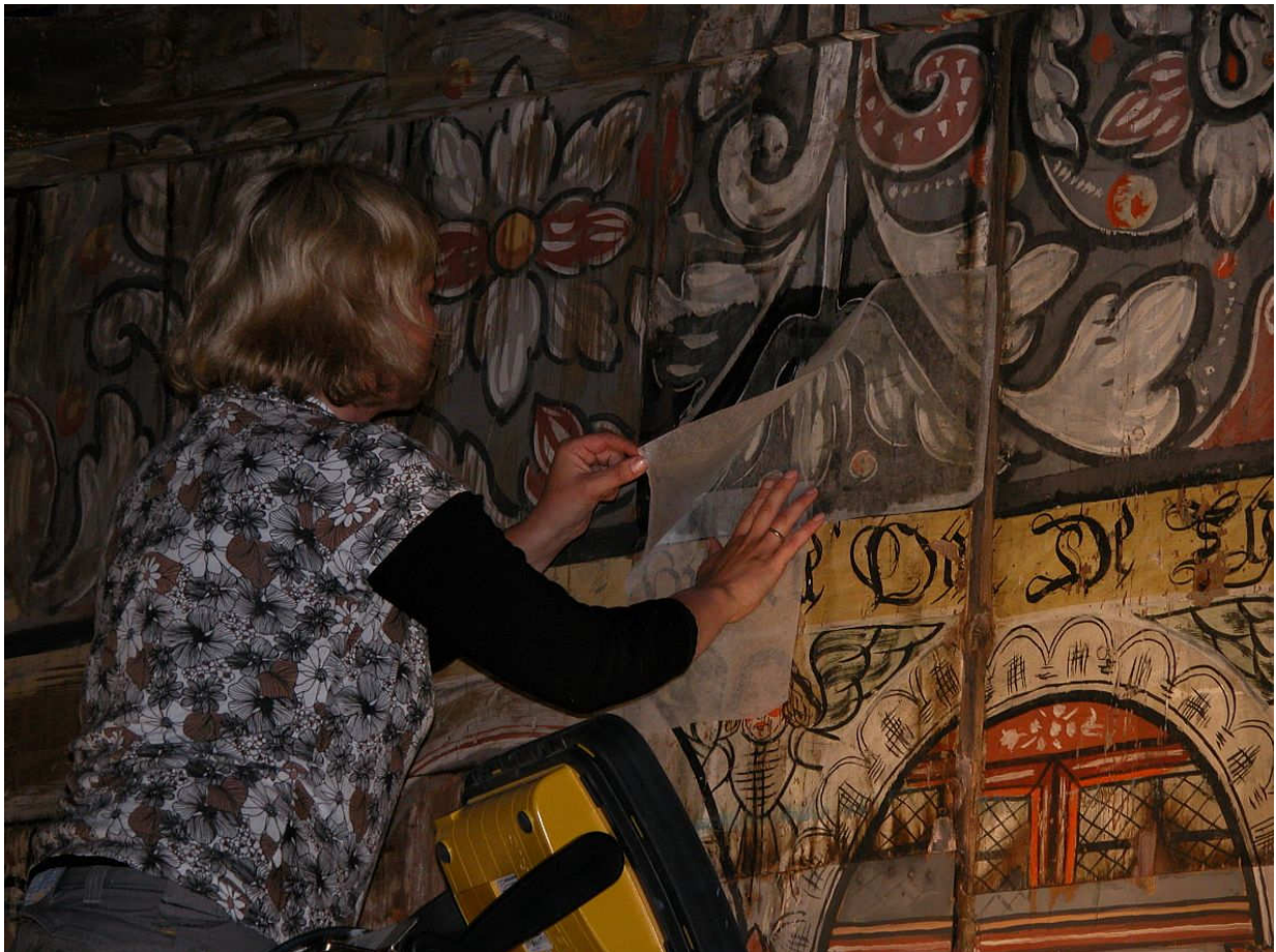
Figur 1. Konsolidering av limfargedekor på sørveggen i den eldste delen av skipet. Konservator Hilde Berntsen fjerner forsidebeskyttelse av japanpapir etter at overflødig lim er fjernet fra overflaten. Foto: NIKU, KSo 2007.
