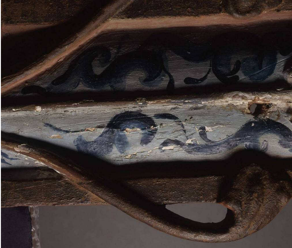
Figur 45. Hedalkrusifikset, korsarm, detalj. Eksempel på tilstanden på korset: malingen har løsnet og falt av slik at den hvite grunderingen synes, andre steder er malingen presset opp i teltformasjon. Foto: Birger Lindstad, 2005.
