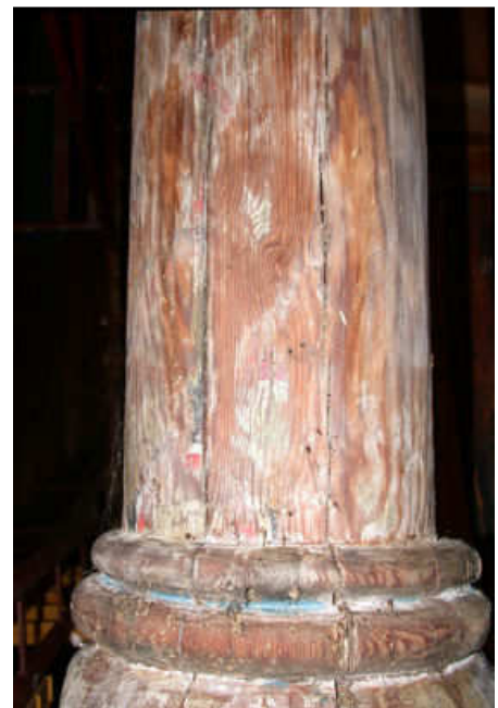
Rester av maling på lektoriets søyle mot nord. Foto: NIKU, 2009
