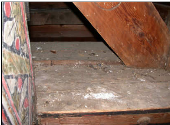
Støv og smuss på bærebjelke på utsiden av lektoriet mot syd. Foto: NIKU, 2009
