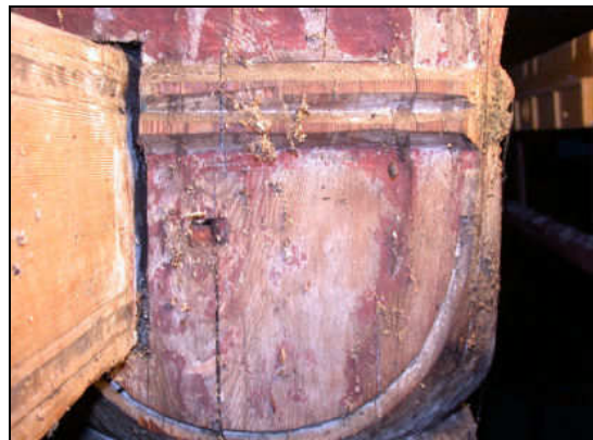
Støv og smuss på søylen mot nord. Foto: NIKU, 2009
