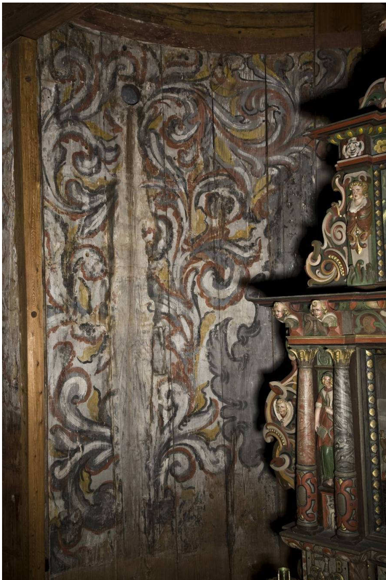
Fig. 17: Apsis, nordside. Malingen er løst opp av vann som har kommet inn gjennom en liten, rund glugge på veggen. Foto: B. Lindstad, 2008.
