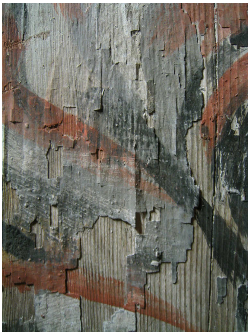
Fig. 16: Oppskallinger på nordvegg i koret. Foto: N. Kjølsten, NIKU 2008.
