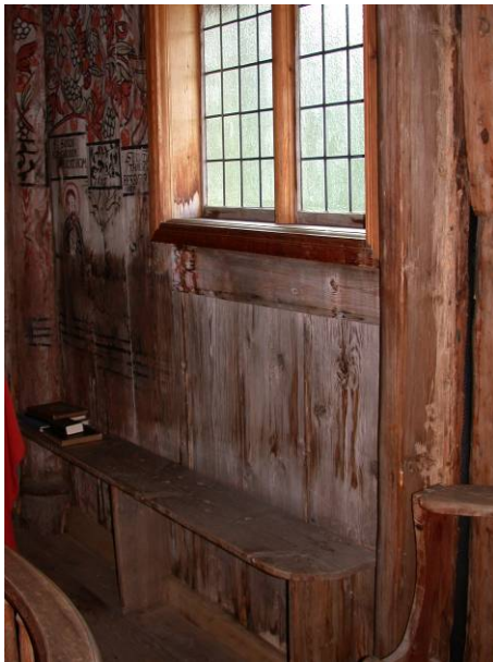
Fukt- og vannskader på sydveggen.
