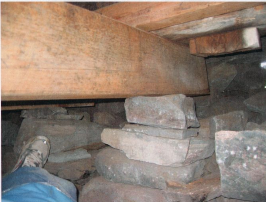
Sørsiden av rommet under gulvet i skipet med sekundær gulvbjelke og grunnstokk. OS 08
