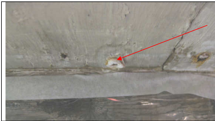
Detalj fra himlingen som viser saltkrystaller i ring rundt et naglehodet. Saltet har trukket ut i limfargen og dannet den mørke sirkelen i malingen rundt naglehodet.
