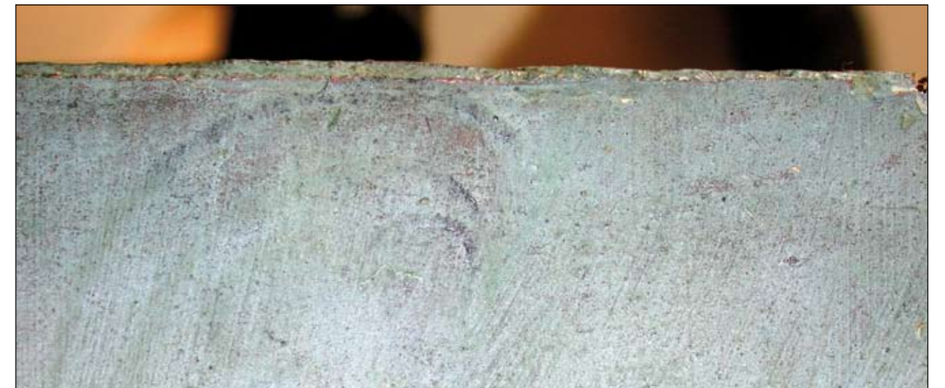
Figur 10. Øverst på bakveggen avsluttes den originale malingen litt innenfor kanten og i et litt tykkere lag enn nedenfor. Penselen har støttet mot en kant e.l. da bakveggen ble grundert og malt. Under den blå overmalingen – som fortsetter ut over øvre kant – skimtes et rødt malinglag. Foto: Mille Stein, NIKU, 2007.
