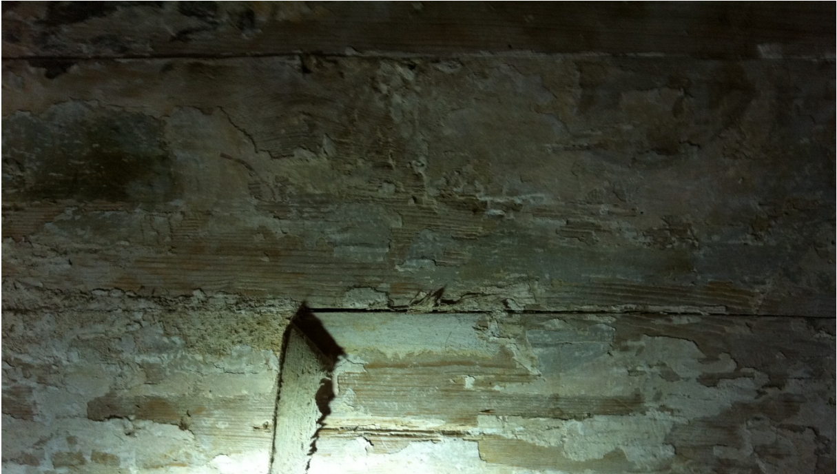
Figur 27. Sprekker i tømmeret ble dekket med lerretsstrimler før veggene ble malt. Enkelte av lerretsstrimlene løsner (sydvegg).
