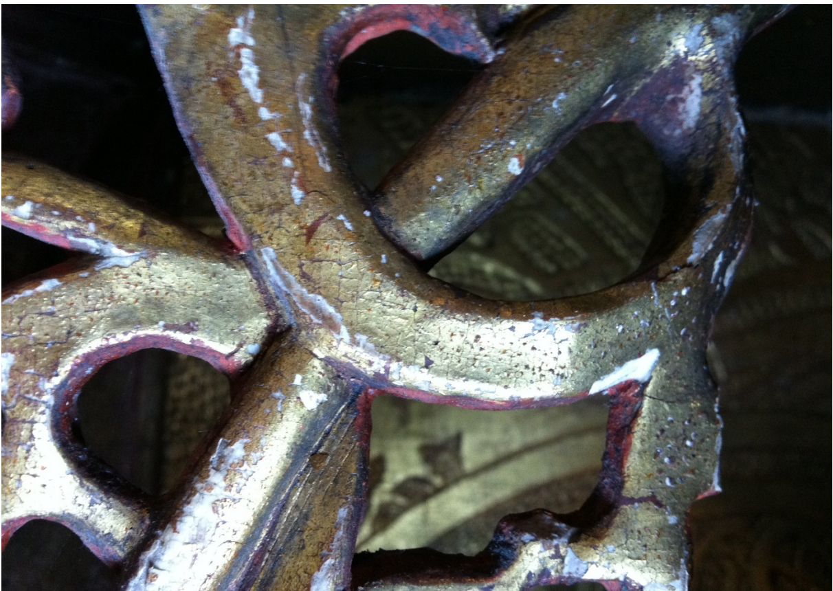
Figur 5. Løs maling på arkitekturelementer i middelalderdelen
