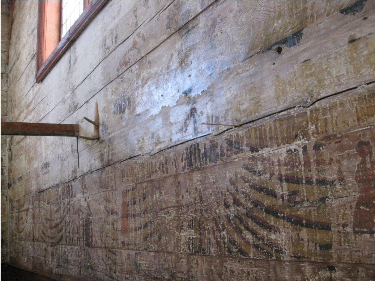
Figur 24. I forbindelse med at overkalkingen ble fjernet på 1980-tallet ble veggdekoren konsolidert med Calaton (Soluble Nylon). Calatonen sees på enkelte steder som blanke skjolder.
