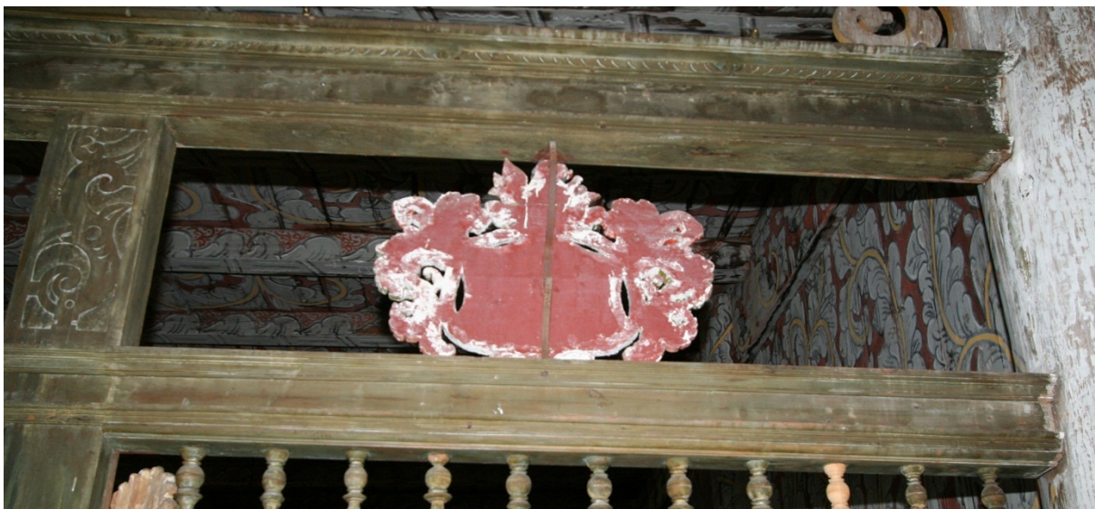
Figur 17. Løs maling på baksiden av våpenskjoldet på korsskillet, nord
