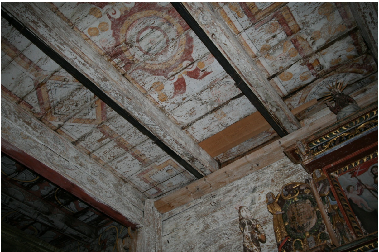
Figur 35. Limfargedekoren i taket bør tilstandvurderes fra stillas.
