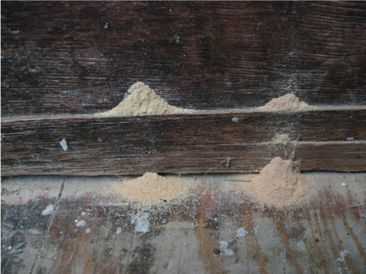
Figur 44. Det ble observert boremel fra treborende insekter i sydøstre hjørne i koret. Dette bør holdes under oppsikt og tiltak vurderes dersom det utvikler seg til et større angrep.
