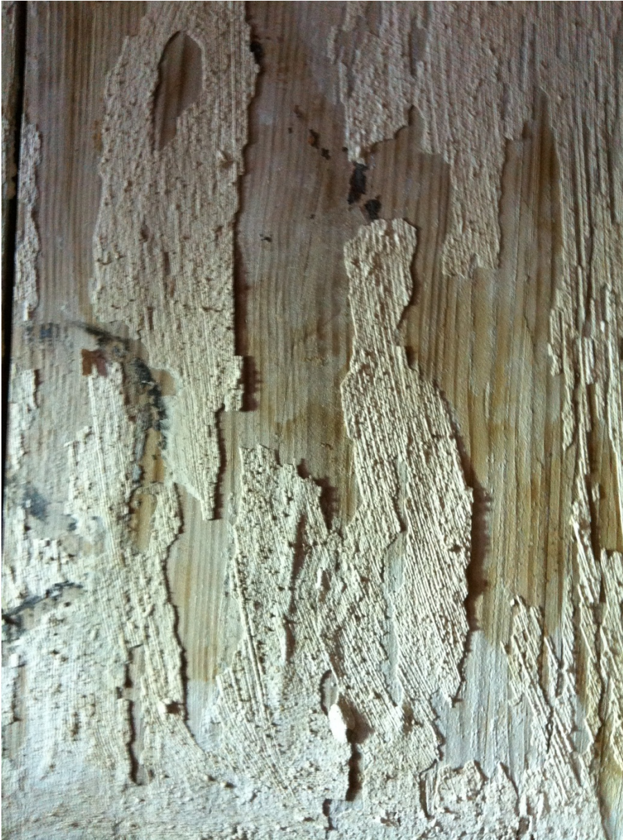
Figur 2. Løs maling på dør i skip. Bør konsolideres eller fjernes for å vise underliggende limfargedekor.
