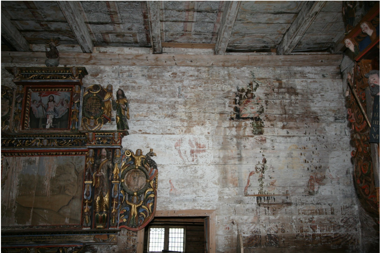
Figur 20. Veggdekoren i koret har partier med løs maling, nordvegg.
