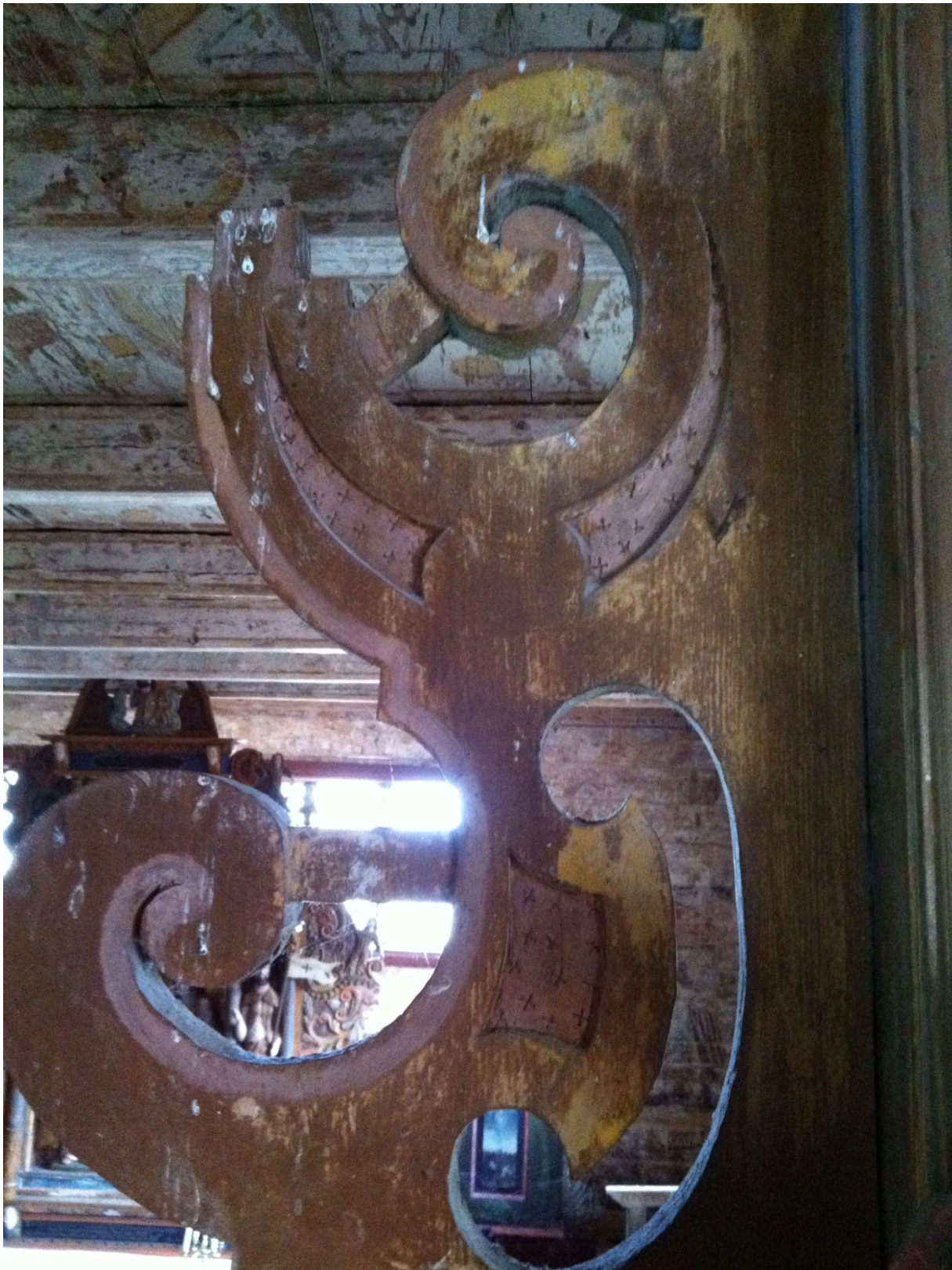
Figur 43. Det er lett for fugler å fly inn i kirken, bl.a. i overgang mellom tak og vegg. Man bør vurdere tiltak for å hindre fugler å komme inn. Det er mye fugleskitt på inventaret, her eksemplifisert med en detalj av altertavlens bakside.
