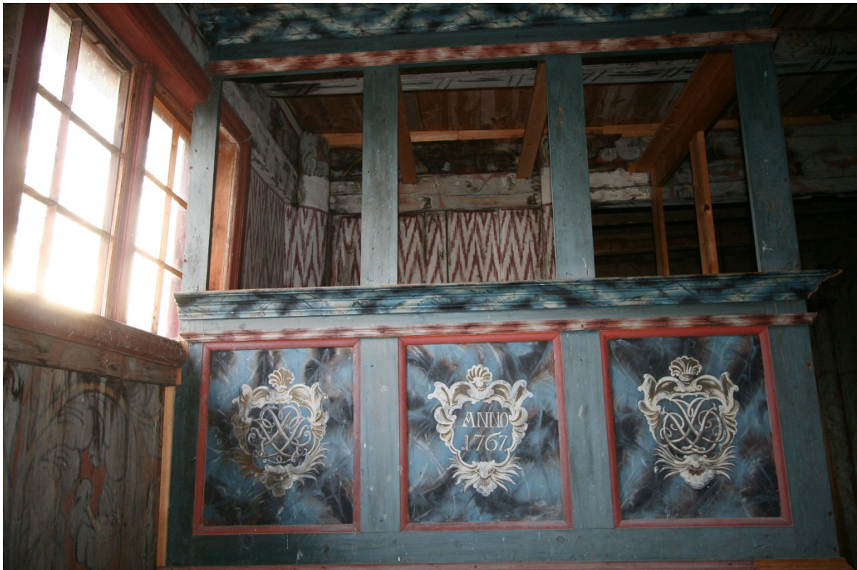
Figur 36. Ikatvevimitasjonen på veggen i prestestolen i skipets sydvestre hjørne bør kontrolleres jevnlig mht. løs maling.
