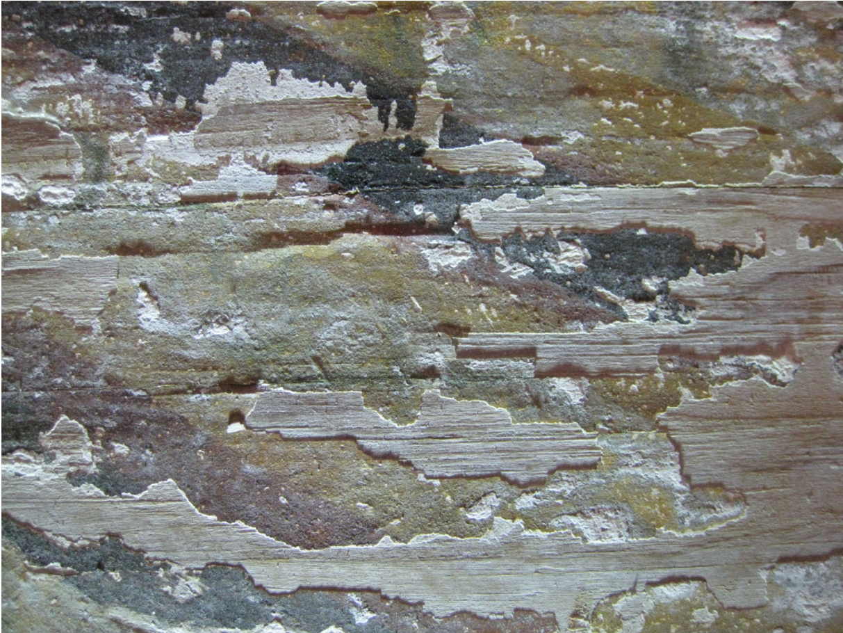
Figur 25. Område med løs maling på veggdekoren i koret (sydvegg).
