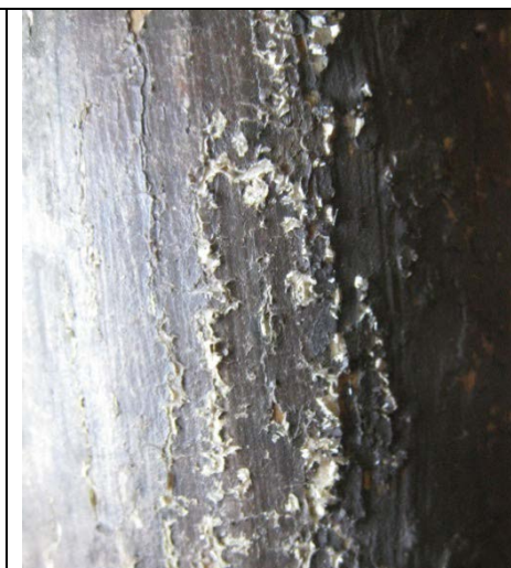
Detalj som viser typiske skader på de nedre søylene
