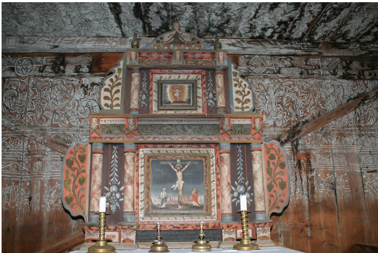
Fig. 1. 1600-talls limfargedekor i koret er slitt helt bort i nedre del av vegg, og har omfattende vannskjolder i himlingen. Enkelte områder må konsolideres.
