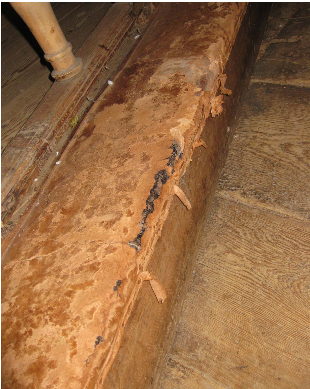
Fig. 11. Skinnen på knefallet er meget slitt og løsner. Det må repareres/skiftes, løsning er bl.a. betinget av bruken.
