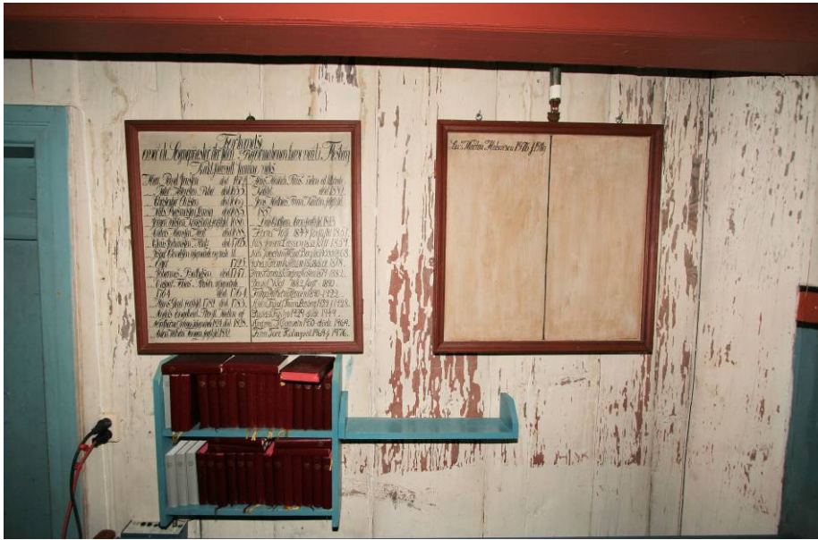
Fig.3: Vestveggen i vestre korsarm med store skader i form av avskallinger og partier med løs maling. Foto: NIKU 2006.
