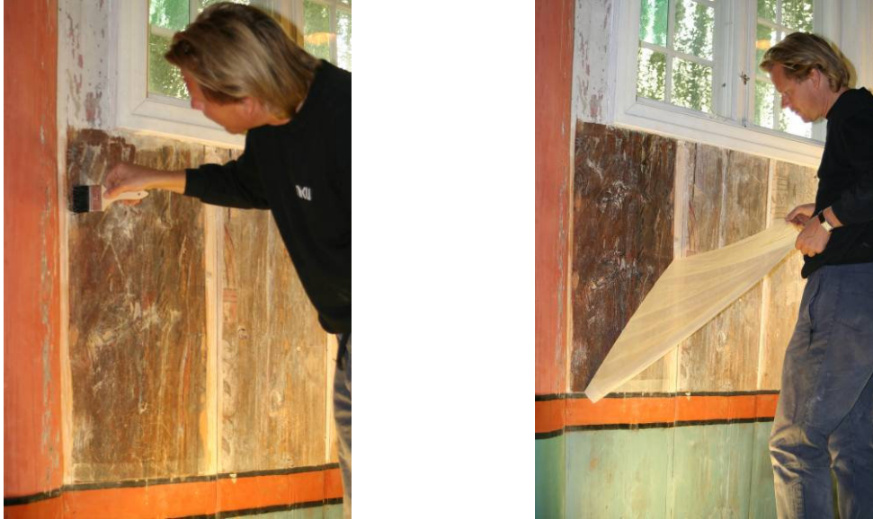
Fig.8: Konsolidering med 1% størlim av et ferdig avdekt felt på sydveggen. Foto: NIKU 2006.
