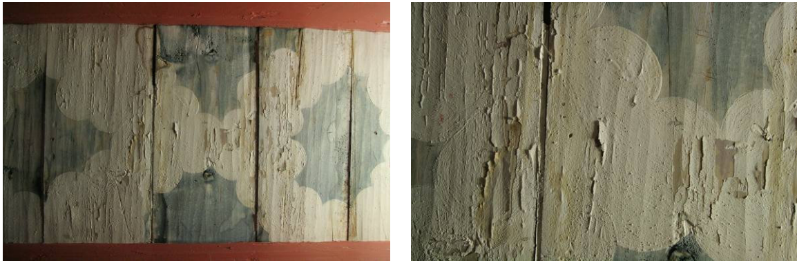
Fig.12: Detaljer av himlingsdekoren før behandling som viser store områder med avskallinger og løs maling. Foto: NIKU 2008.
