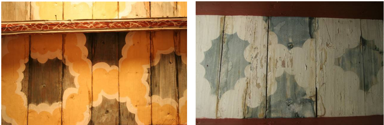
Fig.13: Detalj av himlingsdekoren i Nore stavkirke til venstre og Flesberg til høyre. Materialbruk, teknikk og motiv er så sammenfallende at man med stor sannsynlighet kan gå ut fra at det er samme maler som har utført arbeidet i 1730-årene. Foto: NIKU 2008.
