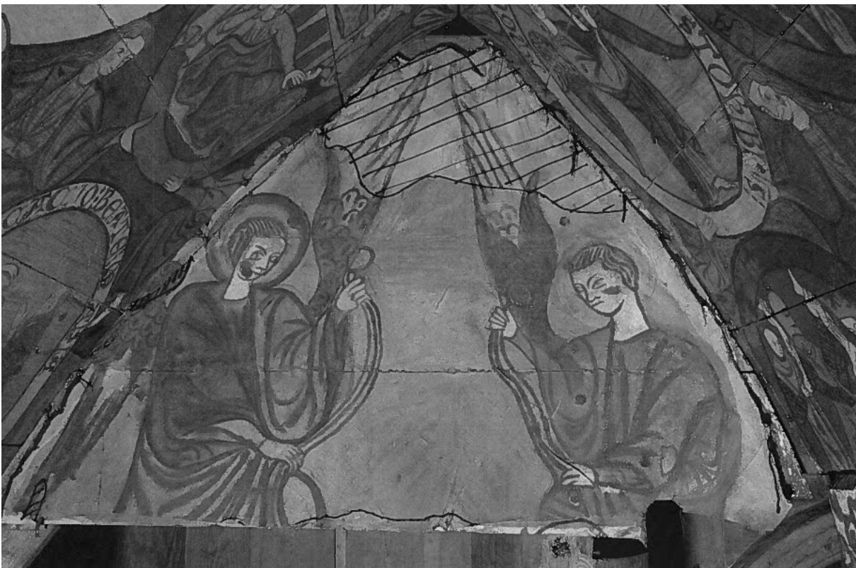
Fig 10. Områder på gavlfeltet hvor lerretet har revnet og båndet rundt sidekantene er løsnet fra lerretet er merket med sort strek, områder med løst lerret merket med skravert sort strek. NIKU, 17.6. 2010.
