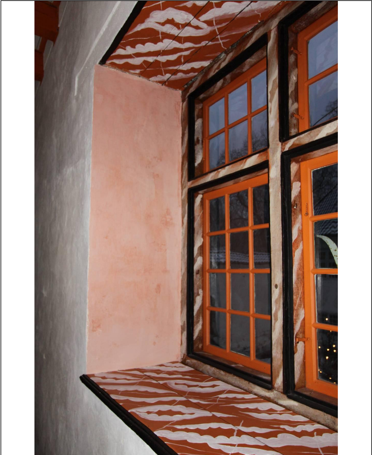
Vindusnisjen i vinduet ut mot borggården. Sideveggene i vindusnisjen ble restaurert i 2010, og ble da malt med pigmentert limfarge. På grunn av den høye fuktigheten i rommet etter vannlekkasjen, har den nye malingen fått skjemmende skjolder. (Sammenlign på stedet med sideveggene i vindusnisjene i rom 201, Gangen, som ble restaurert i 2006 og 2007.) Foto: JB. 3.1.2011
