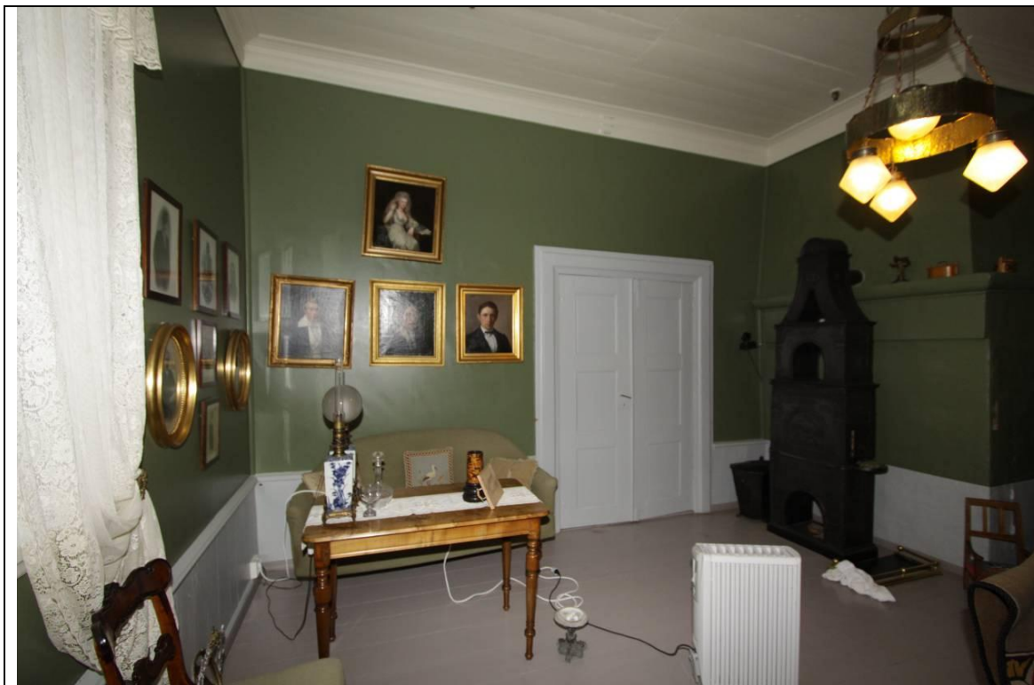
Veggen mot rom 215, Baronens sovekammer. Hele denne veggen var nedfuktet. Størst vannpåvirkning var det i takets nordside, området rundt døra og i gulvet. Det er ikke synlige skader i gulvet, men det må ha vært nedfuktingen i golv og stubbloftet, idet det er vesentlig vanninntrenging i hvelvkonstruksjonen i rommet under, Vinkjelleren. Foto: JB. 3.1.2011
