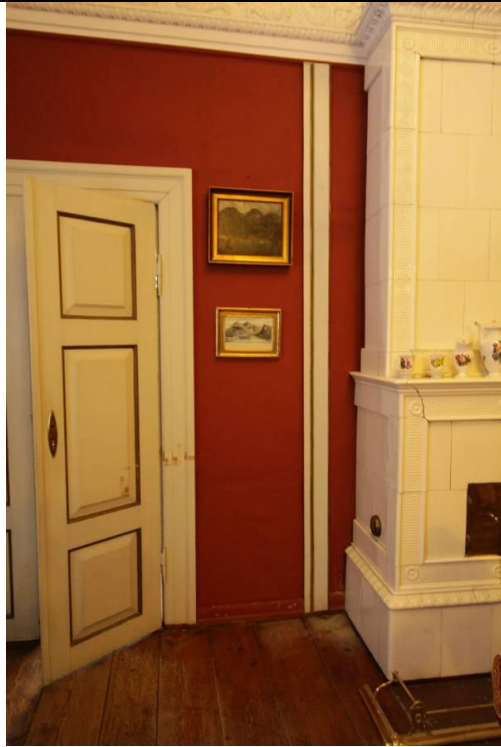
Det var nedfukning under gesimsen, langs brannmuren og på gulvet på begge sider av kakkelovnen. Rester av leire, sand og fint støv ligger igjen på gulvet etter at vannet er tørket bort. Området var fremdeles fuktig. Foto: JB. 3.1.2011
