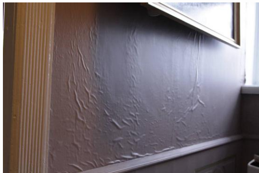
Rosendal. Rom 115. Baronens soverom. Vannskade på sydveggenes veggtrekk over brystningen. Foto: J. B. 3.1.2011.
