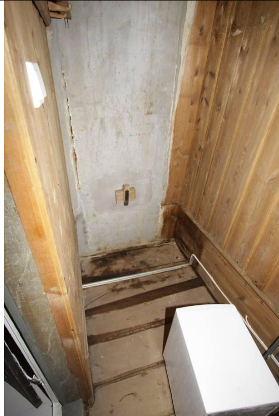
Sett mot vest. Rommet var fullstendig nedfuktet, med ca. 5 cm vann på gulvet. Tak, vegger, pipeløp og gulv var fremdeles vått. Loftstrommet over kottet var fremdeles meget vått. Foto: JB. 3.1.2011
