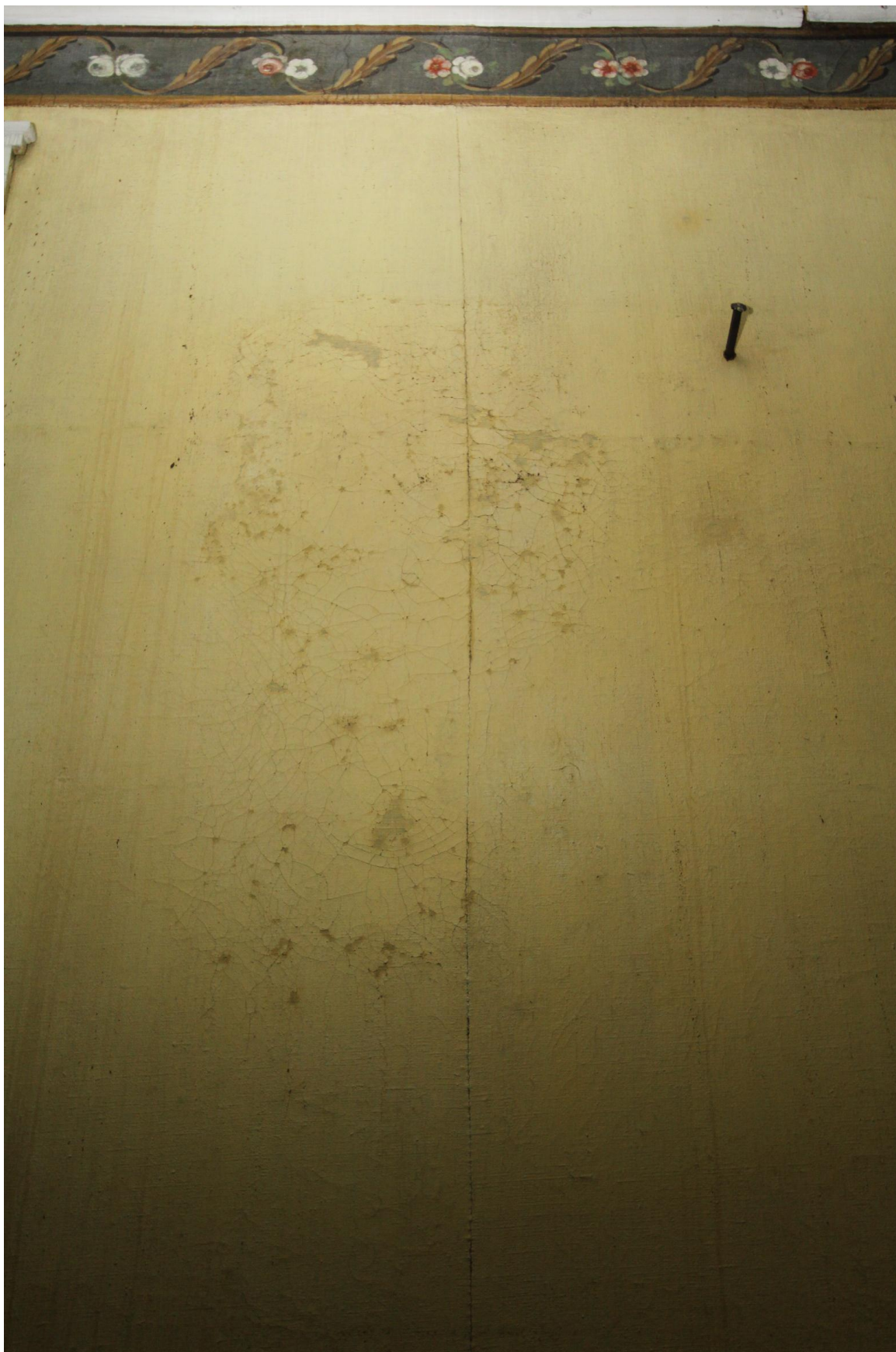
Rom 218 Den Gule sal. Detalj av det skadete originale veggtrekket på sydveggen. På grunn av den kraftige nedfuktingen er det blitt nye skader. Malinglaget er i partier løsnet fra lerretet, det er nye opp- og avskallinger og utfall i malinglagene og retusjene fra 2004 har blitt misfarget. Foto: JB. 26.10.11
