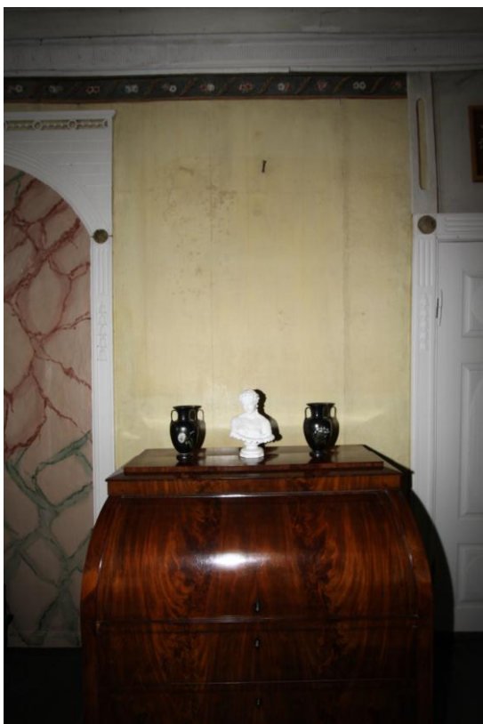
Rom 218 Den Gule sal, det skadete veggtrekket på sydveggen. Foto: JB. 26.10.11
