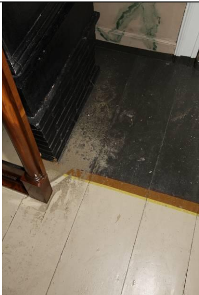
Rester av leire, sand og fint støv ligger igjen på gulvet, på østsiden av ovnen etter at vannet er tørket bort. Området var fremdeles fuktig. Foto: JB. 3.1.2011
