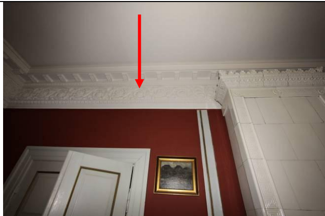
Til venstre: Vestveggen syd for kakkelovnen. Området til høyre for pilen var nedfuktet. Takflaten og gesimsen må holdes under oppsikt i dette området på grunn av mulighet for nye skader. Foto: JB. 3.1.2011
