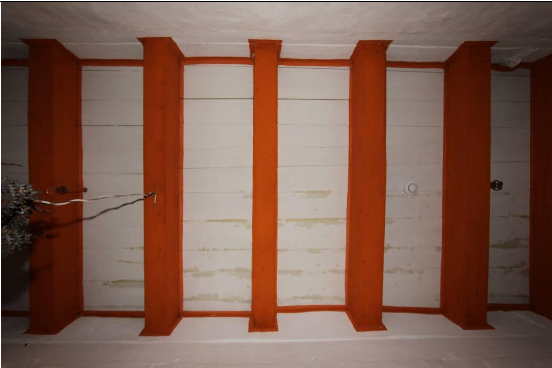
Takets midtdel. Over hele gangen er det kun et enkelt bordtak, som også fungerer som loftsgulv. Takbordene er malt med limfarge med kritt som pigment. Bjelkene er malt med limfarge med mønje og sinober som pigment. Gulvet på loftet ble kraftig nedfuktet, men på grunn av at gulvbordene var pløyd, og at gulvet trutnet raskt ble skadene i den vannløselige malingen begrenset til en rekke vannskjolder, misfarget og løs maling. Foto: JB. 3.1.2011
