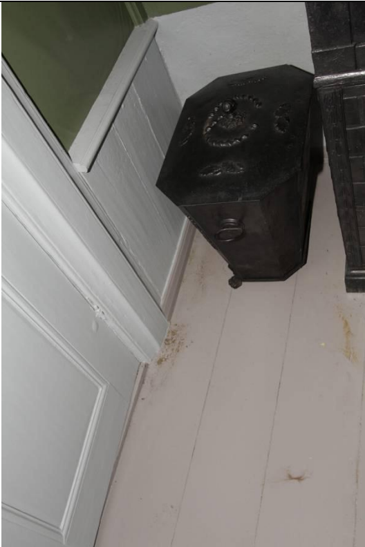
Området øst for dør 214/215 var fremdeles svært fuktig. Både listverk, brystning og gulv var gjennomfuktet. Rester av fritt vann sees som fukt skjolder på gulvet. Foto: JB. 3.1.2011
