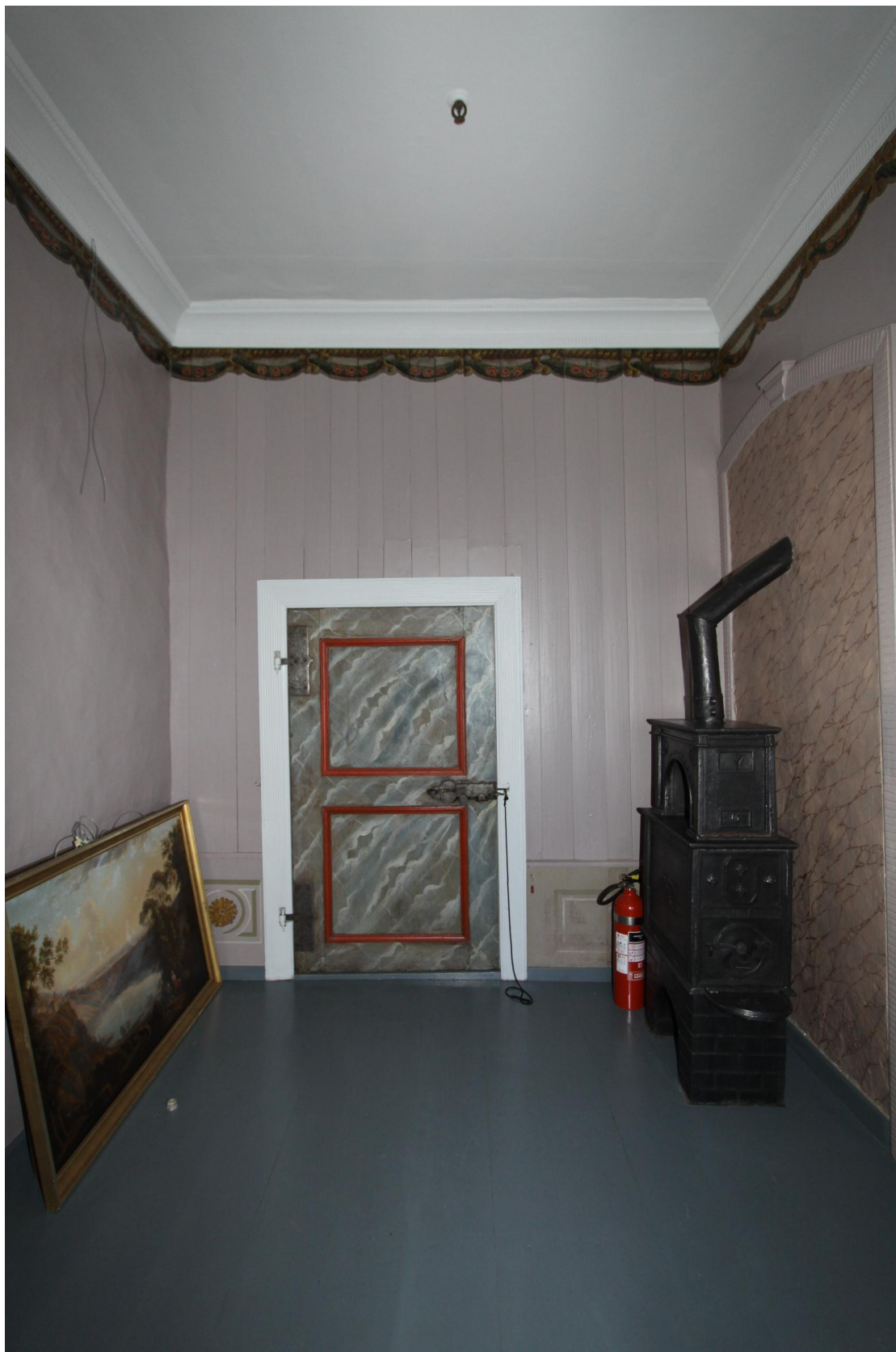
Baronens sovekammer sett mot øst. Rommet er nå gjennomtørt, og det kan ikke observeres skader i de områdene som tidligere var kraftig nedfuktet.
