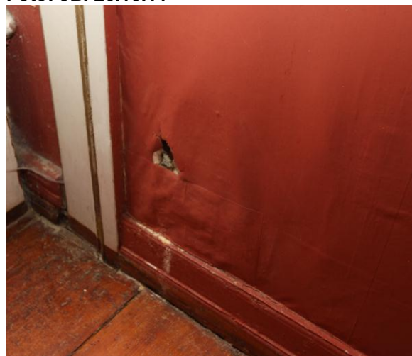
Vestveggen. Feltet nord for kakkellovnen. Detalj av skader i lerret og papptrekket. Foto: JB. 26.10.11
