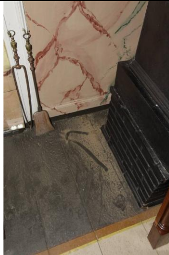
Vanngjennomtrengingen var over- og på begge sider av brannmuren. Det var nedfukting på og under gesimsen, langs brannmuren og på gulvet på begge sider av kakkellovnen. Rester av leire, sand og fint støv ligger igjen på gulvet, på østsiden av ovnen etter at vannet er tørket bort. Området var fremdeles fuktig. Foto: JB. 3.1.2011
