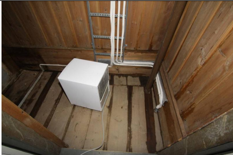
Gulvet og litt av nordveggen. Rommet var fullstendig nedfuktet, med ca. 5 cm vann på gulvet. Tak, vegger, pipeløp og gulv var fremdeles vått. Sikringsskapet på nordveggen var fullt av vann. Foto: JB. 3.1.2011
