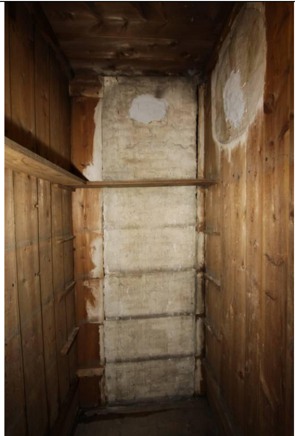
Sett mot øst. Pipeløpet. Rommet var fullstendig nedfuktet, med ca. 5 cm vann på gulvet. Tak, vegger, pipeløp og gulv var fremdeles vått. Foto: JB. 3.1.2011
