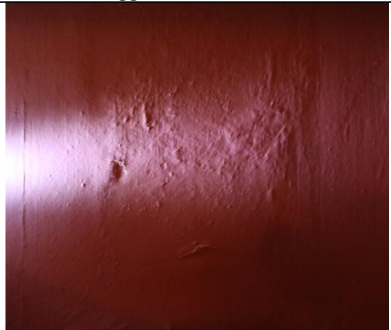
Vestveggen. Feltet nord for kakkellovnen. Detalj av skader i lerret og papptrekket. Foto: JB. 26.10.11
