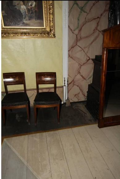
Veggtrekk og brannmur på sydveggen ble nedfuktet ved lekkasjen. Det var fremdeles fuktig i dette området. Foto: JB. 3.1.2011
