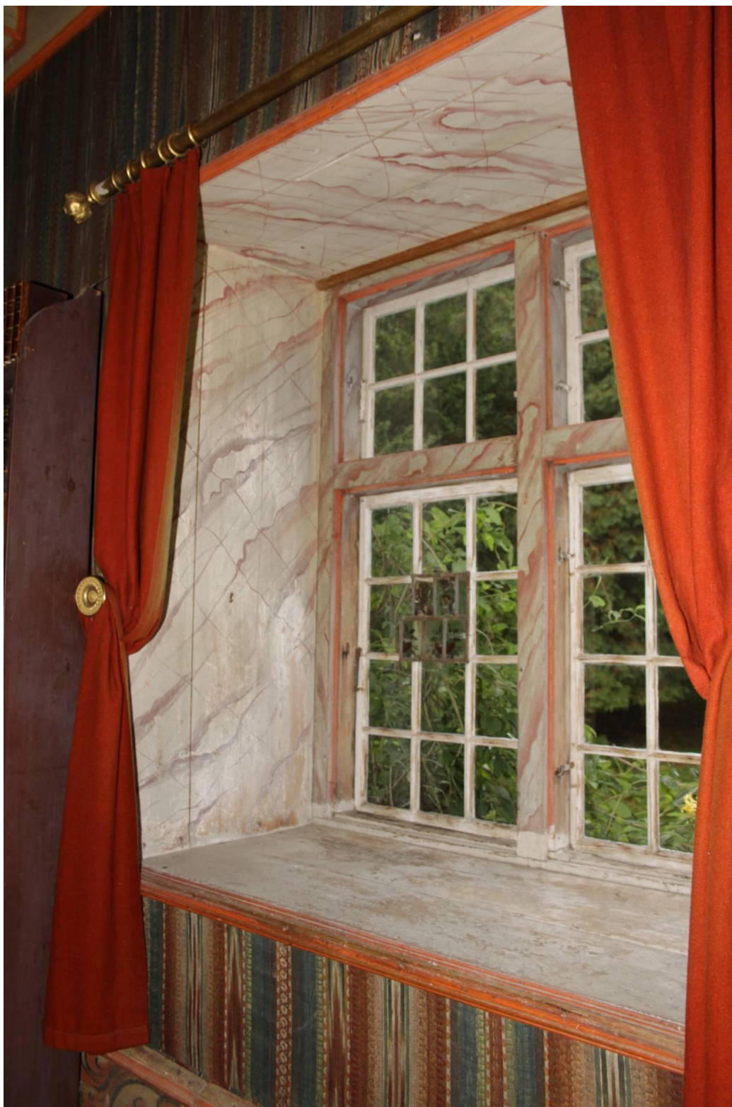
Figur 19. Nordøstre vindu. Mekanisk slitasje, nedbrutt- og manglende maling er lett synlig.
