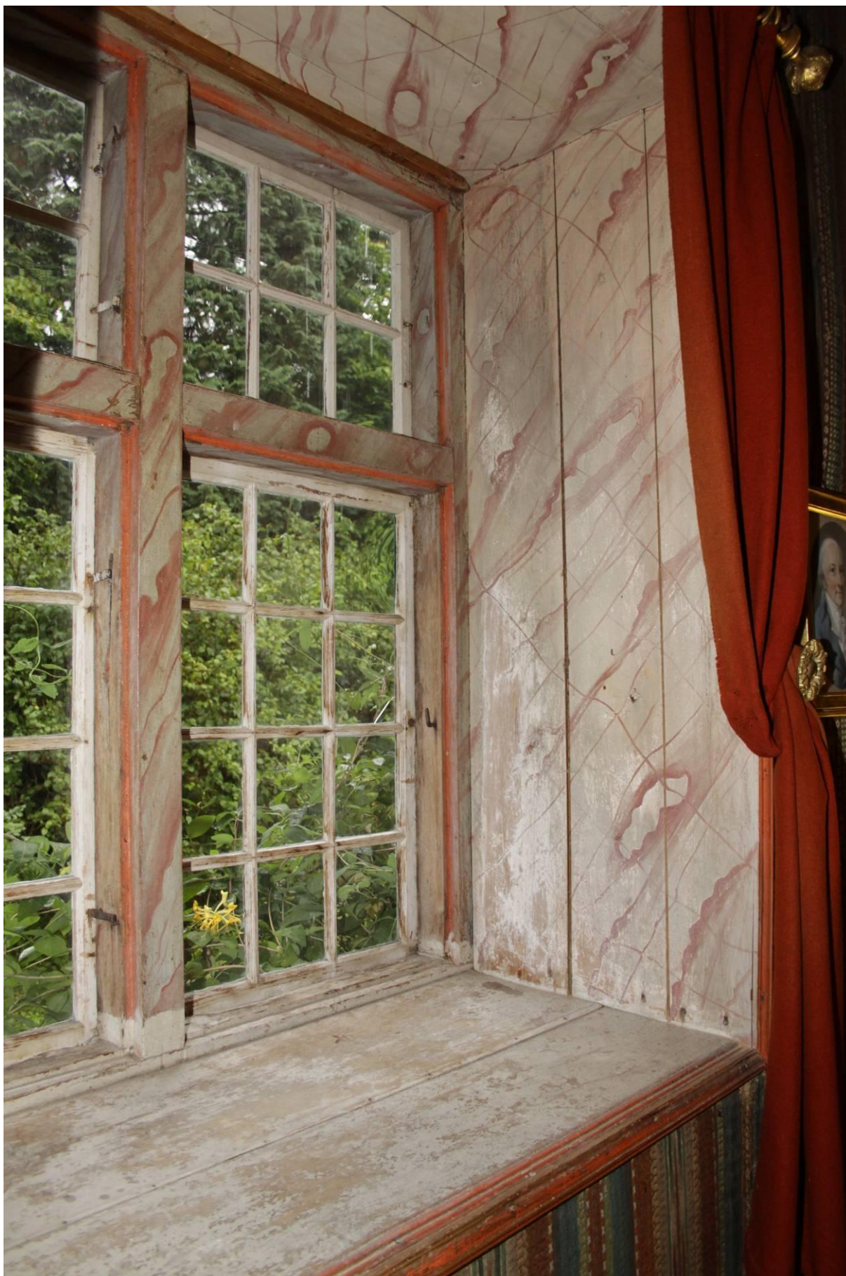
Figur 18. Nordøstre vindu. Mekanisk slitasje, nedbrutt- og manglende maling er lett synlig.
