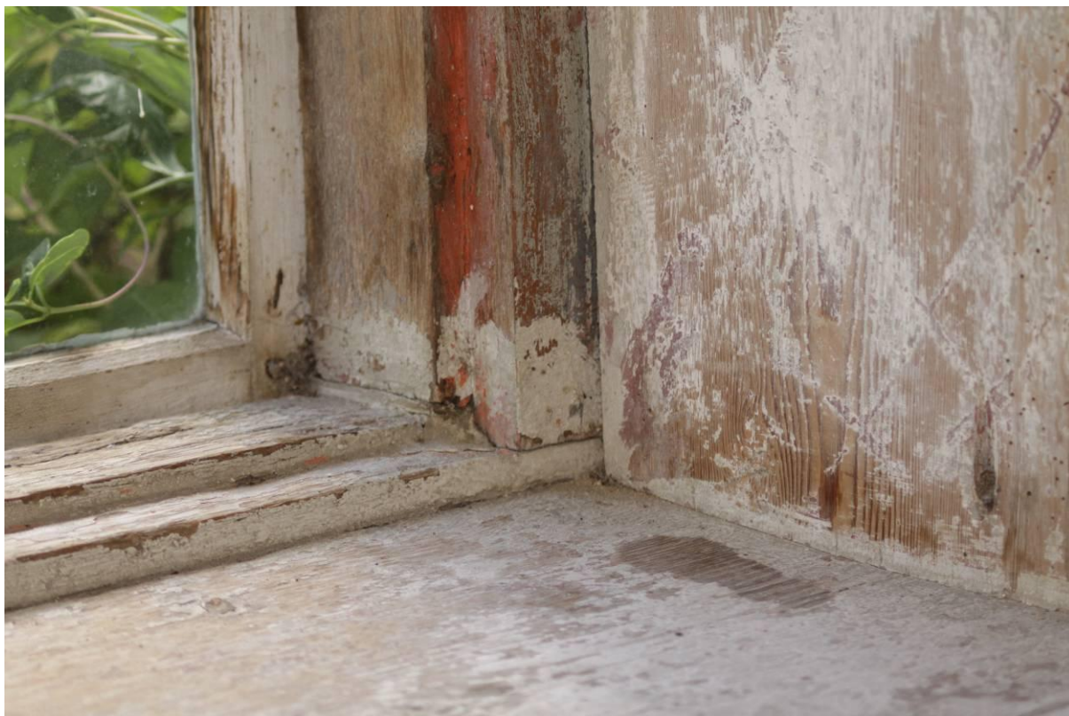
Figur 17. Detalj av nordøstre vindu som viser hvor nedbrutt maling og malt dekor er på deler av karm og vindusmyg. Bunnkarmen og nedre del av sidekarmene er overmalt.
