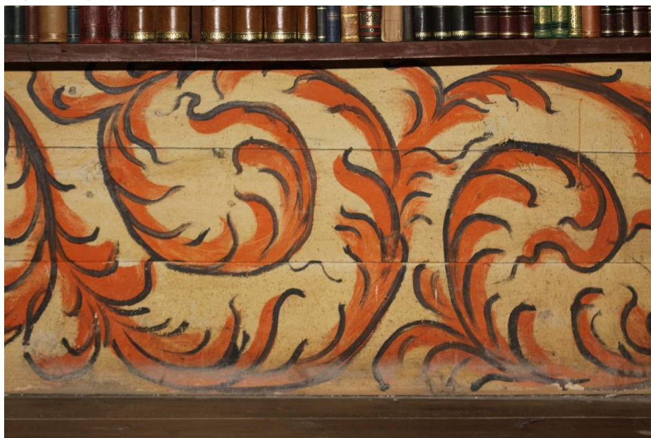
Figur 20. Detalj av brystningen på østveggen. Brystningen og den malte dekoren er samtidig med tekstiltapetet dvs. ca. 1665. Rankedekoren er malt i en mager lettløselig oljebasert maling. Overflaten er til dels meget skitten, og har mange fukt- og klimaskader. Skadene er dels forårsaket av direkte påvirkning av fukt og vann ved rengjøring, slik som det kan sees i nedre del av dekoren på dette bildet, hvor malinglaget er blakket og delvis ødelagt, dels nedmatting på grunn av høy relativ fuktighet gjennom lang tid.
