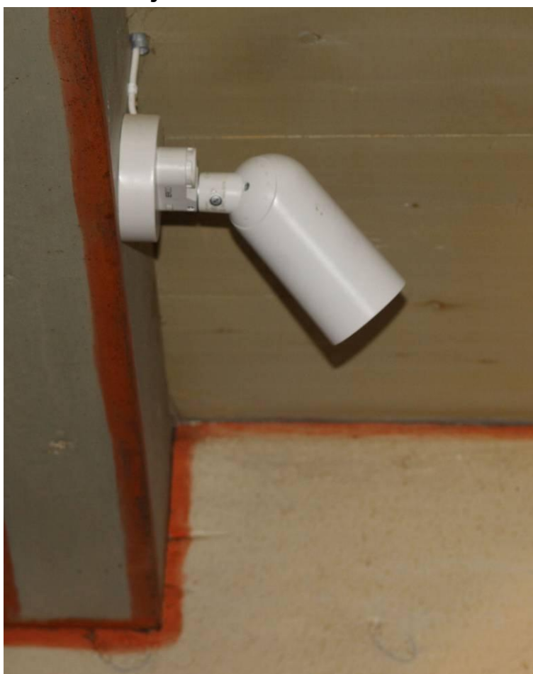
Figur 27. Det er installert flere spotlamper i rommet. Spotlyset er rettet mot portrettene som henger i rommet. Lyssettingen brukes i forbindelse med omvisningene i rommet. Alle disse lampene utvikler sterk varme. Varmeutviklingen kan medføre risiko for brann. Varmen fra lampene akselererer nedbrytingen av alle malte og umalte flater i nærheten av lyskildene. Lyset vil også forsterke nedbrytingen av tekstilene der lyset treffer disse.
