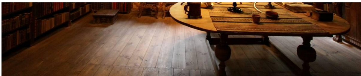
Figur 26. Rommet har et pløyd bordgulv som ligger øst/vest. Alderen er ukjent, men trolig er det lagt i løpet av 1800 – årene. Gulvbordene er skjøtt ca midt i rommet. Gulvet er ubehandlet.
