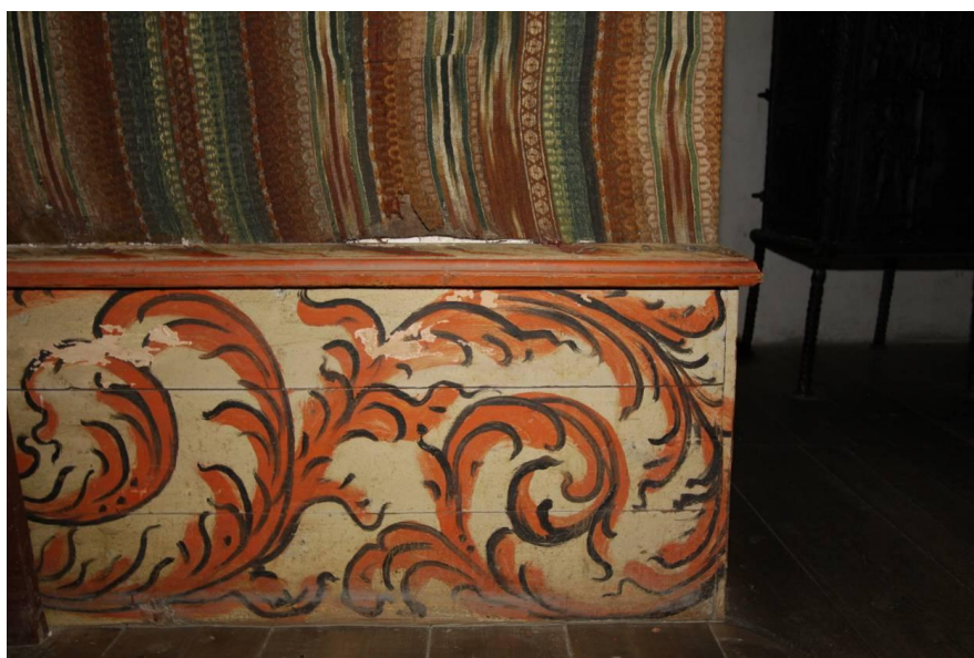
Figur 21. Detalj av brystningen på vestveggen. Overflaten er til dels meget skitten, og har mange fukt- og klimaskader. Skadene er dels forårsaket av direkte påvirkning av fukt og vann ved rengjøring, slik som det kan sees i nedre del av dekoren på dette bildet, hvor malinglaget er blakket og delvis ødelagt, dels nedmatting på grunn av høy relativ fuktighet gjennom lang tid. Videre har dekoren diverse opp- og avskallinger i malinglaget slik som det kan sees på dette bildet. Opp- og avskallingene skyldes dels mekaniske skader dels klimatiske forhold.
