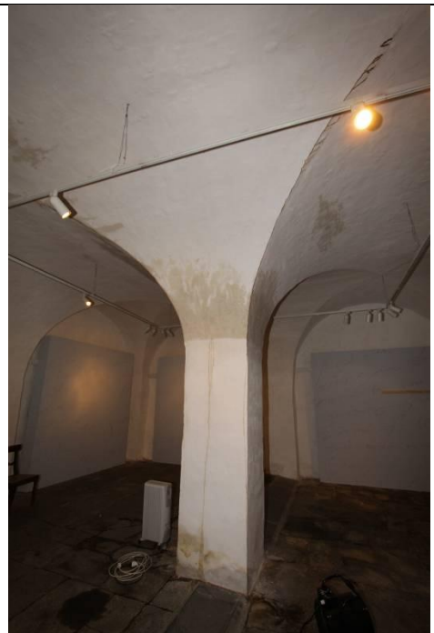
Vannskader på den nyrestaurerte bæresøylen i krysshvelvet i vinkjelleren. Nordsiden.
