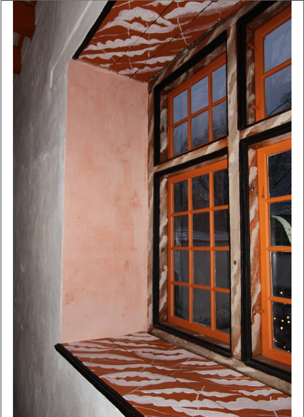
Vindusnisjen i vinduet ut mot borggården. Sideveggene i vindusnisjen ble restaurert i 2010, og ble da malt med pigmentert limfarge. På grunn av den høye fuktigheten i rommet etter vannlekkasjen, har den nye malingen fått skjemmende skjolder. (Sammenlign på stedet med sideveggene i vindusnisjene i rom 201, Gangen, som ble restaurert i 2006 og 2007.)
