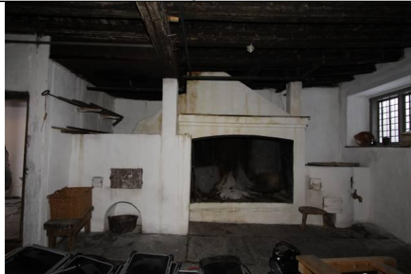
Skader på den nyrestaurerte gruen og bakerovnen. Kalklagene er kraftig misfarget av sot og skitt som har trukket inn i kalken.
