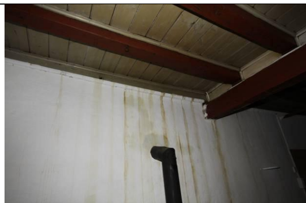
Skader på nordveggen. Kalklagene er kraftig misfarget av skitt og sot som vannet har tatt med seg ned fra bjelkelaget, og som har trukket inn i kalken.
