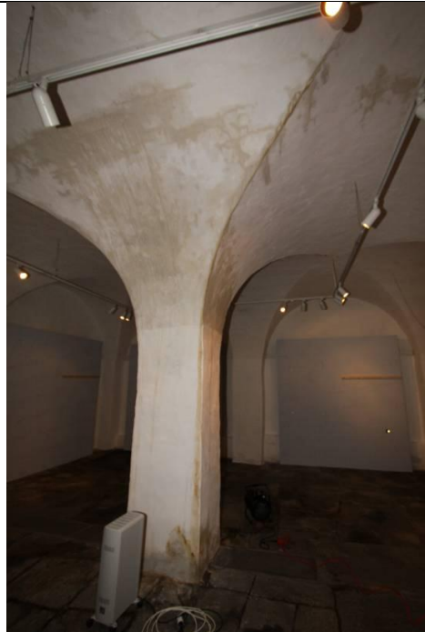
Vannskader på den nyrestaurerte bæresøylen i krysshvelvet i vinkjelleren. Østsiden.
