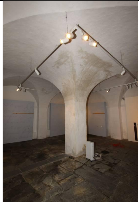
Vannskader på den nyrestaurerte bæresøylen i krysshvelvet i vinkjelleren. Sydsiden.
