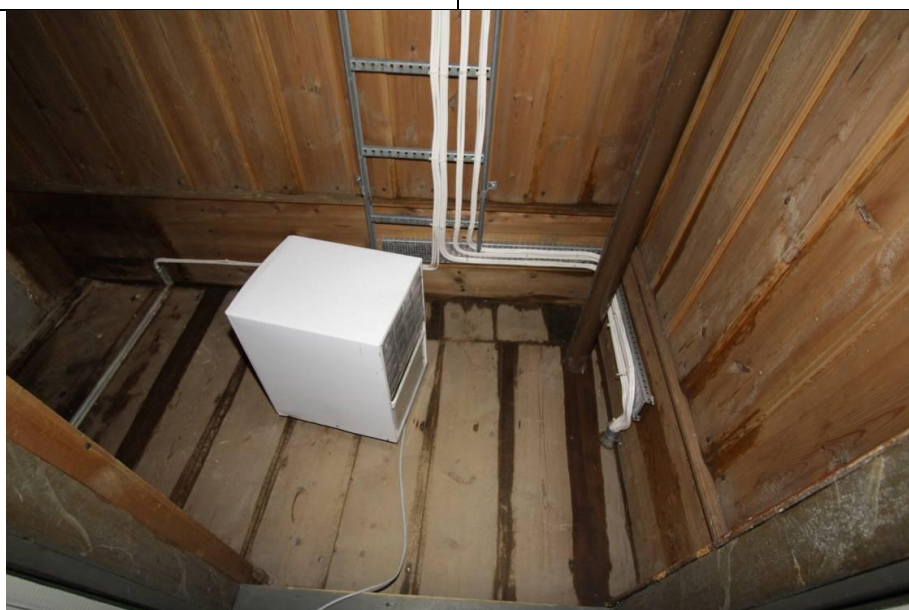
Gulvet og litt av nordveggen. Rommet var fullstendig nedfuktet, med ca. 5 cm. vann på gulvet. Tak, vegger, pipeløp og gulv var fremdeles vått. Sikringsskapet på nordveggen var fullt av vann.
