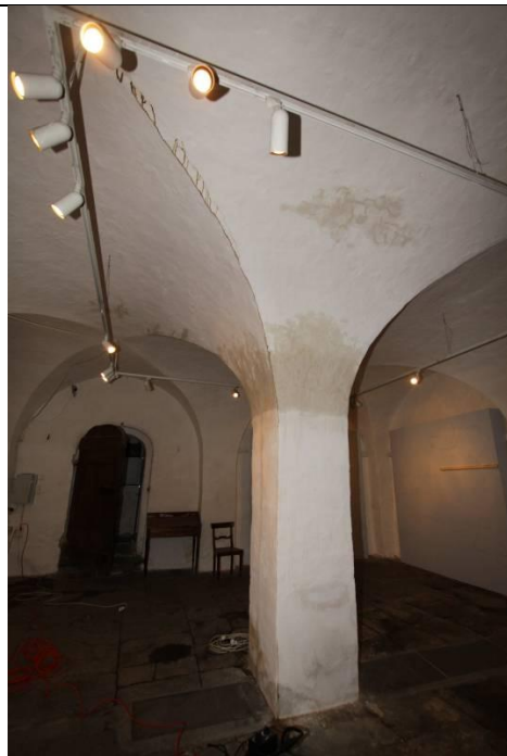
Vannskader på den nyrestaurerte bæresøylen i krysshvelvet i vinkjelleren. Vestsiden
