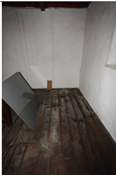
Skader på syd- og vestveggen. Kalklagene er kraftig misfarget av skitt og sot som vannet har tatt med seg ned fra bjelkelaget, og som har trukket inn i kalken. Gulvet langs sydveggen er nedfuktet, misfarget og bordene buler på grunn av fuktpåvirkning. Store deler av gulvet er dekket av et fint lag med fin sand, leire og humus som har fulgt med vannet fra stubbloftet.
