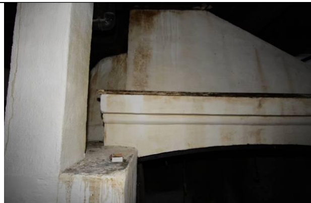
Skader på den nyrestaurerte gruen og bakerovnen. Kalklagene er kraftig misfarget av sot og skitt som har trukket inn i kalken. Detalj.
