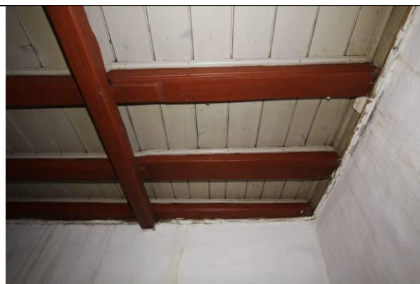
Skader på nordveggen. Kalklagene er kraftig misfarget av skitt og sot som vannet har tatt med seg ned fra bjelkelaget, og som har trukket inn i kalken. Skjolder og misfarging i taket.
