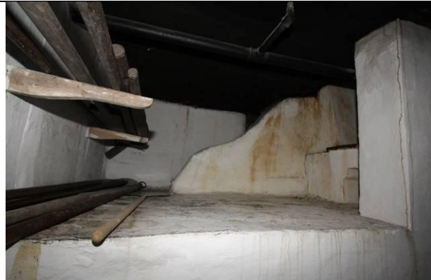
Skader på den nyrestaurerte gruen og bakerovnen. Kalklagene er kraftig misfarget av sot og skitt som har trukket inn i kalken. Detalj.
