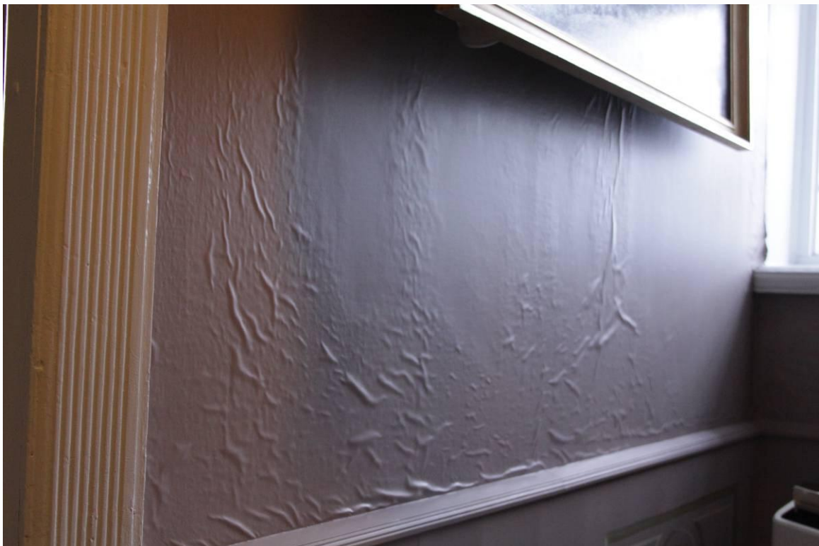
Rosendal. Rom 115. Baronens soverom. Vannskade på sydveggenes veggtrekk over brystningen. Foto: J. Brønne. 3.1.2011.
