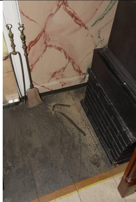
Vanngjennomtrengingen var over- og på begge sider av brannmuren. Det var nedfuktning på og under gesimsen, langs brannmuren og på gulvet på begge sider av kakkellovnen. Rester av leire, sand og fint støv ligger igjen på gulvet, på østsiden av ovnen etter at vannet er tørket bort. Området var fremdeles fuktig.
