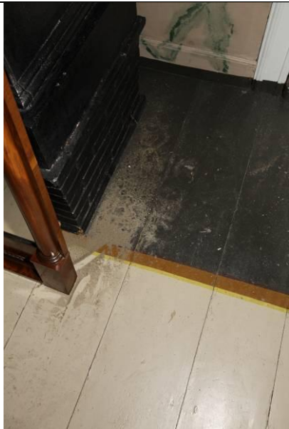
Rester av leire, sand og fint støv ligger igjen på gulvet, på østsiden av ovnen etter at vannet er tørket bort. Området var fremdeles fuktig.
