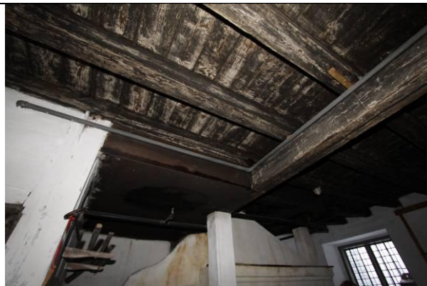
Skadene i taket er omvendt av de øvrige skadene. Her har vannet vasket ut soten i og på takbord og bjelker, og dette har resultert i at tak og bjelker har fått lyse skjolder.
