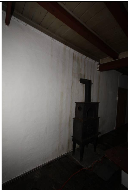
Skader på nordveggen. Kalklagene er kraftig misfarget av skitt og sot som vannet har tatt med seg ned fra bjelkelaget, og som har trukket inn i kalken. Jernovnen har fått nye rustskader. Den må demonteres, renses, overflatebehandles og monteres med ny kitting.
