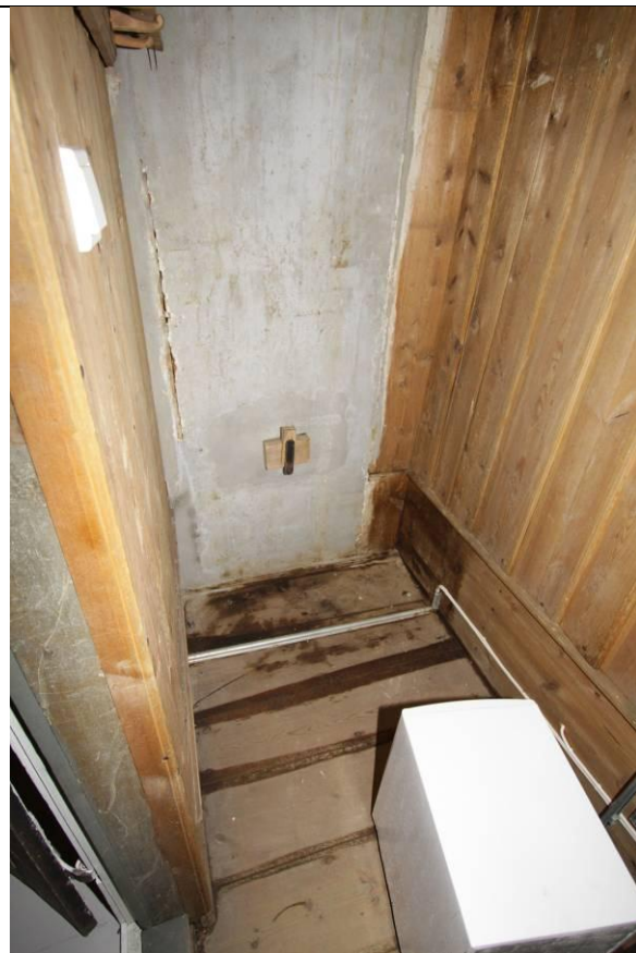
Sett mot vest. Rommet var fullstendig nedfuktet, med ca. 5 cm. vann på gulvet. Tak, vegger, pipeløp og gulv var fremdeles vått. Loftsrommet over kottet var fremdeles meget vått.
