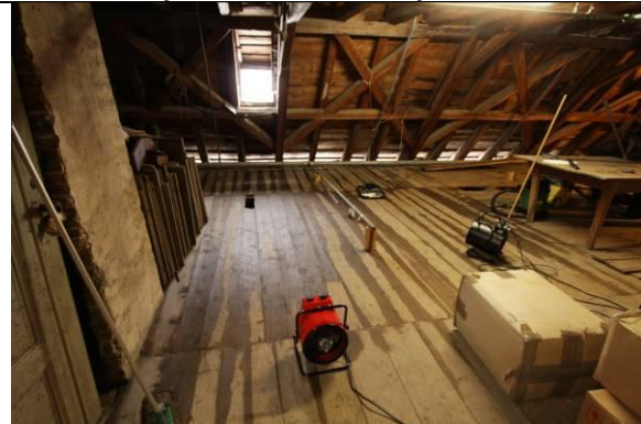
Loftsrommet sett mot vest. De tre sprinklerhodene i den skrå takflaten var det som løste ut. Gulvet er fremdeles helt gjennomfuktet i det området hvor nedfuktingen var størst, over rom 215 Baronens Soverom. På grunn av setninger rant vannet ned mot pipestokken, og fulgte denne nedover i etasjene. Det området som er nedfuktet på bildet hadde stubbloftsfill bestående for det meste av havre og halm. Denne ble fjernet den 4. og 5.1. 2011.
