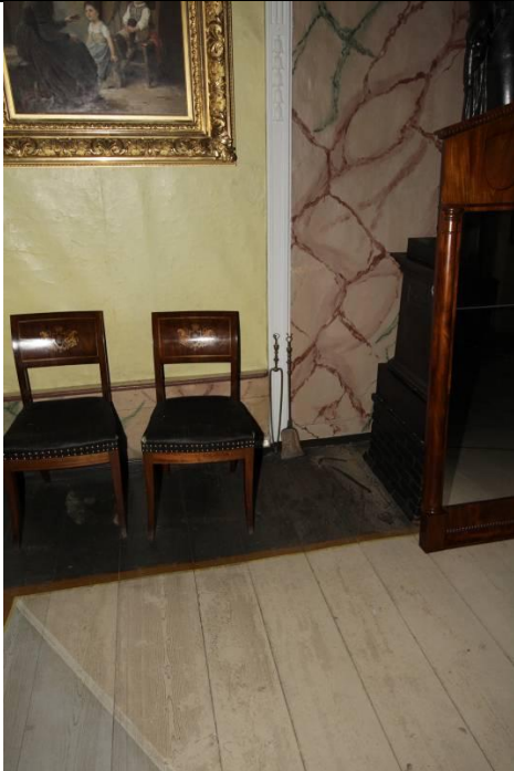
Veggtrekk og brannmur på sydveggen ble nedfuktet ved lekkasjen. Det var fremdeles fuktig i dette området.
