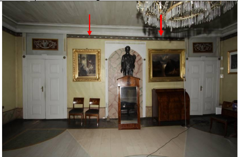
Sydveggen med trukne, malte vegger og malt dekor på undersiden av gesimsen. Det var fremdeles høy fuktighet i området mellom de to røde pilene. Hele rommet ble konservert og restaurert i årene 2002 – 2004. Det er skader i den retusjerte malingen på gesimsen der hvor nedfuktningen var størst, mellom pilene. Videre er det stor sannsynlighet for at det kan bli senskader i den malte dekoren på undersiden av gesimsen. Marmoreringen på brannmuren ble utført som en kopi av den opprinnelige i 2002-2004. Brannmuren var også nedfuktet, men det er usikkert om den har fått skader. Sydveggen må holdes under oppsyn for å kontrollere om det oppstår opp- og avskallinger i malinglag eller malt dekor.
