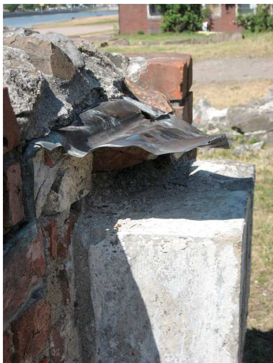
Fig. 10. Toppdekket med beskyttelse av vestre vange i sakristidøren er fjernet og metallplaten ligger løst.
