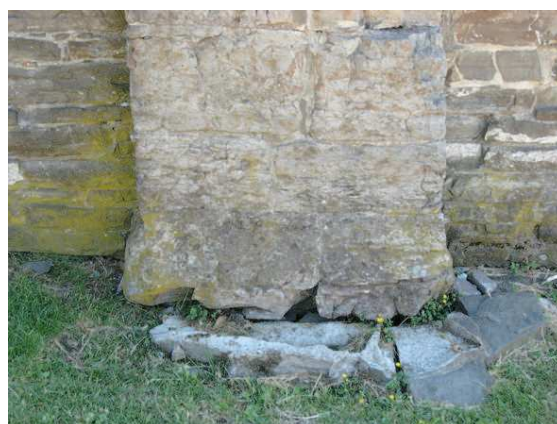
Fig. 2. Lisene i sydmuren. Her er stort mellomrom ned til støpt underlag.
