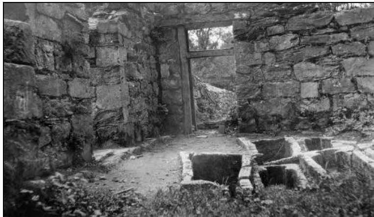
Figur 82: Nordre kapell på 1920-tallet. Fugene i murverket var på dette tidspunktet åpne (kilde: Riksantikvarens arkiv).
