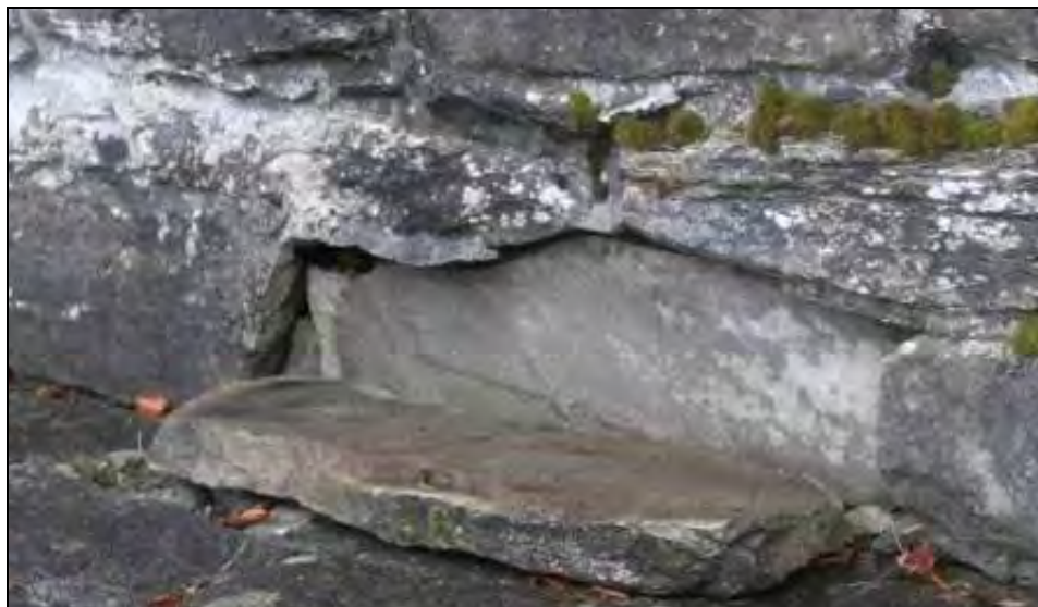
Figur 59: Sprukket stein langs gulvet i innerlivet i østveggen i koret (foto: Byantikvaren 2011).
