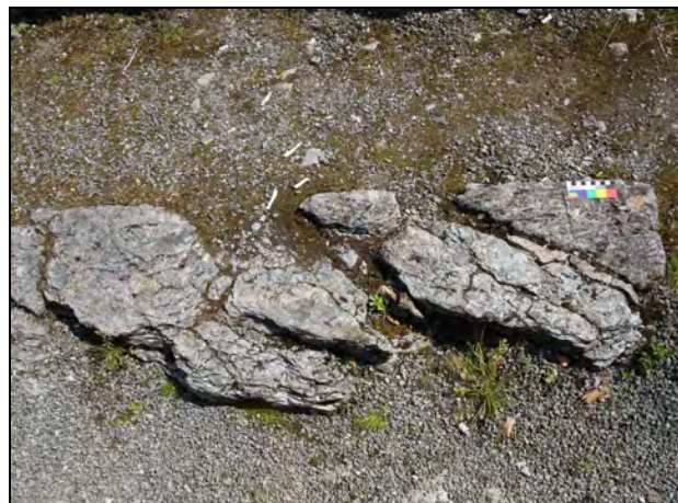
Figur 63: Enkelte av gravplatene som er lagt i gulvet i koret er svært skadet (foto: Byantikvaren 2012).
