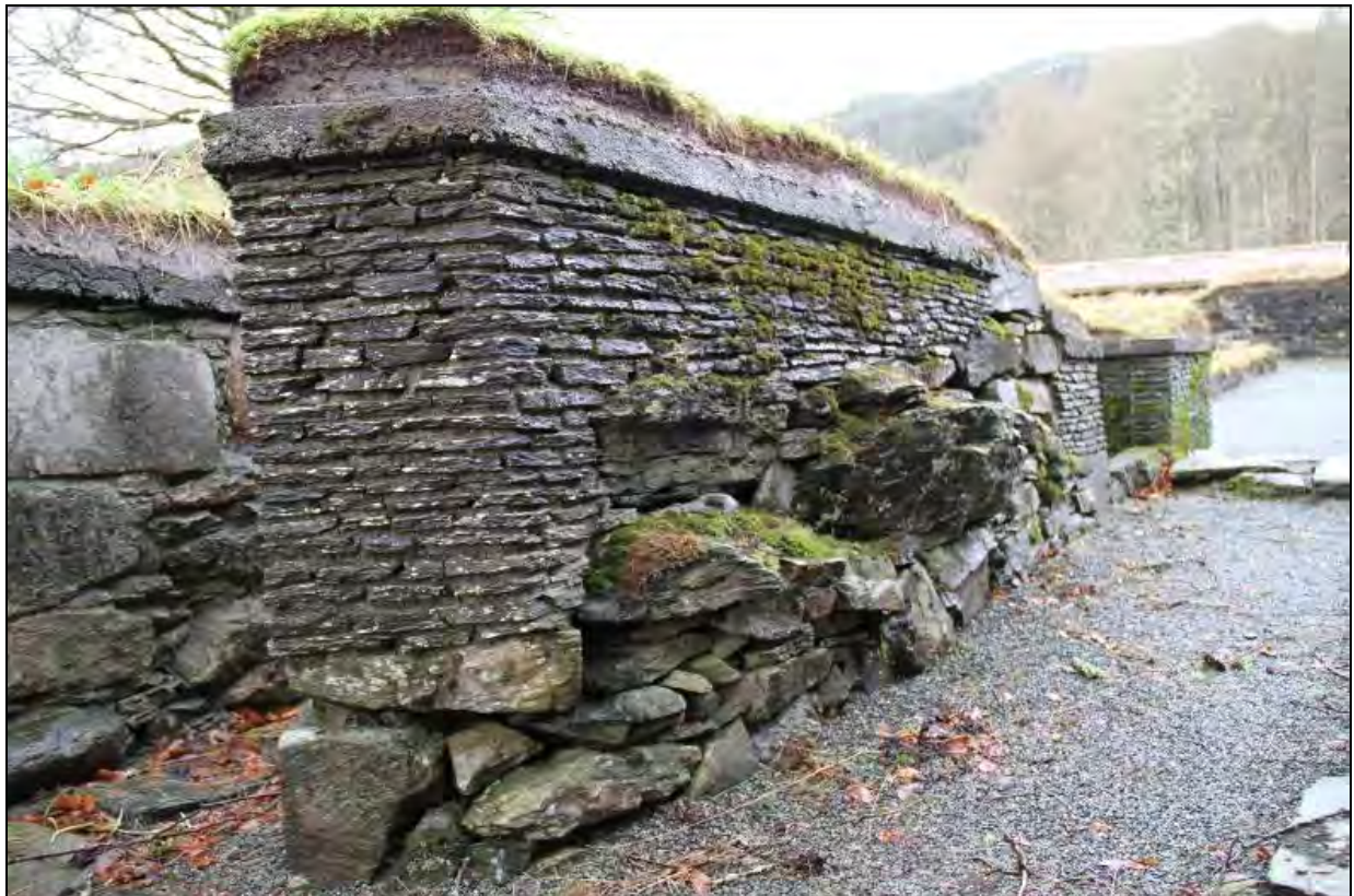
Figur 231: Østlig murliv i murstykket M8. Den nederste delen har hatt forband med en trapp opp til andre etasje, som er arkeologisk påvist, men som er revet. Murverket er i dårlig forfatning (foto: Byantikvaren 2012).
