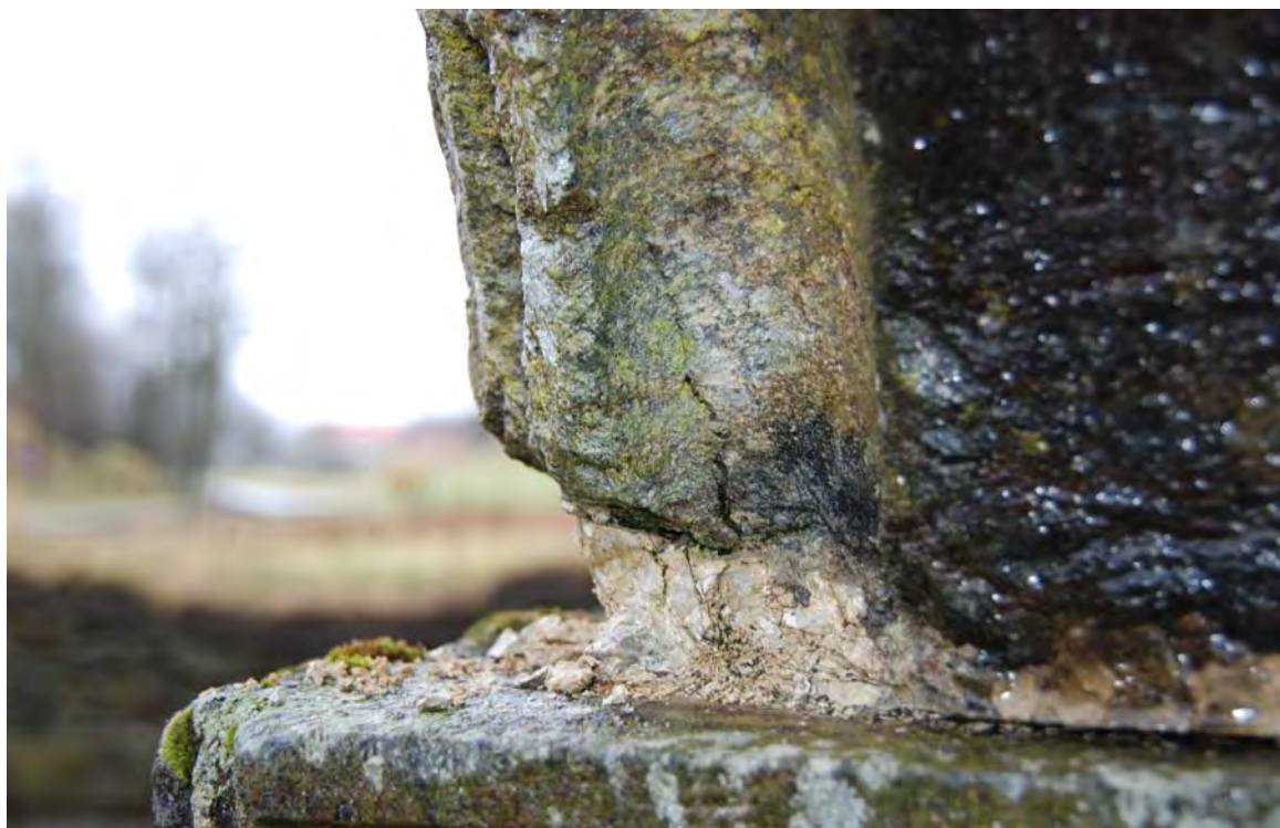
2005/22.04-013: Starten på en skade som er forårsaket av for hard mørtel.
