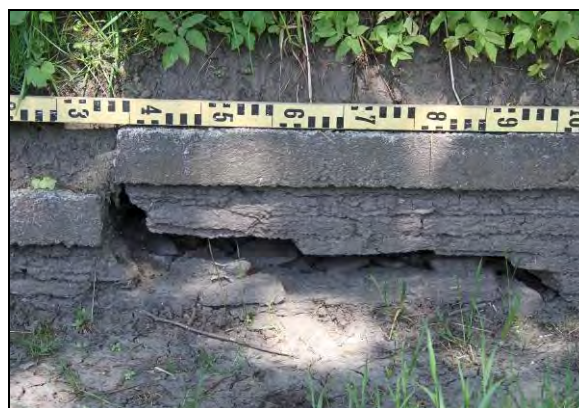
Figur 200: Skade helt vest i sørmurens ytterliv (foto: Byantikvaren 2012).
