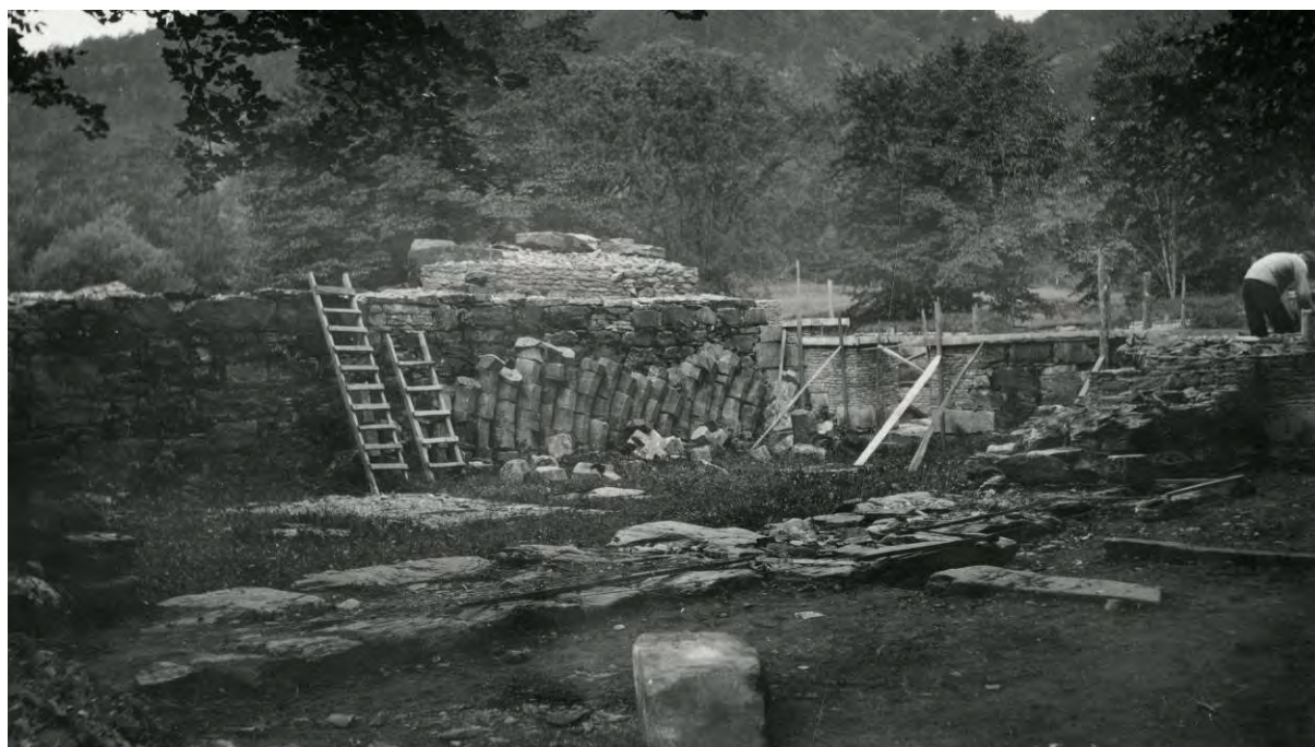
Figur 145. Samme motiv som forrige bilde under istandsettingen på 1920-tallet. I forgrunnen ses fundamentet til østmuren. Foto mot NV (Kilde: Riksantikvarens arkiv).
