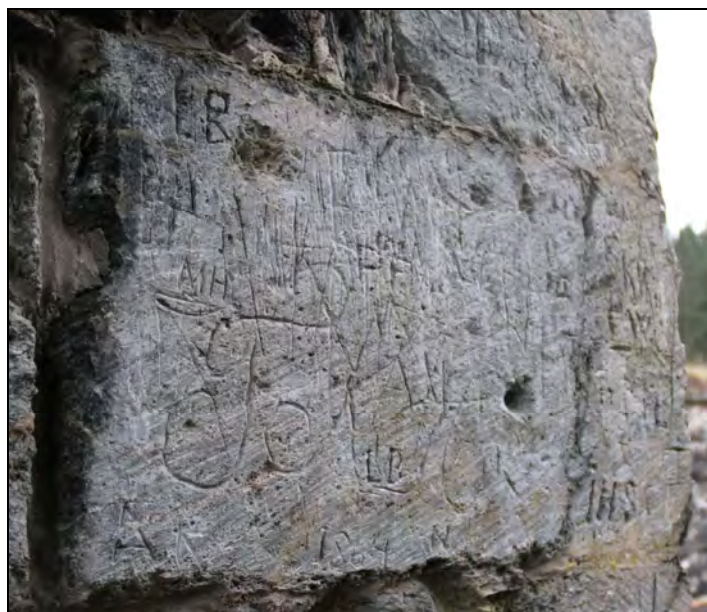
Figur 22. Det er omfattende innrissingskader på mye av klebersteinen i ruinen. Bildet viser en kleberstein i nordre dørvange i vestportalen til nordre kapell (foto: Byantikvaren 2011).
