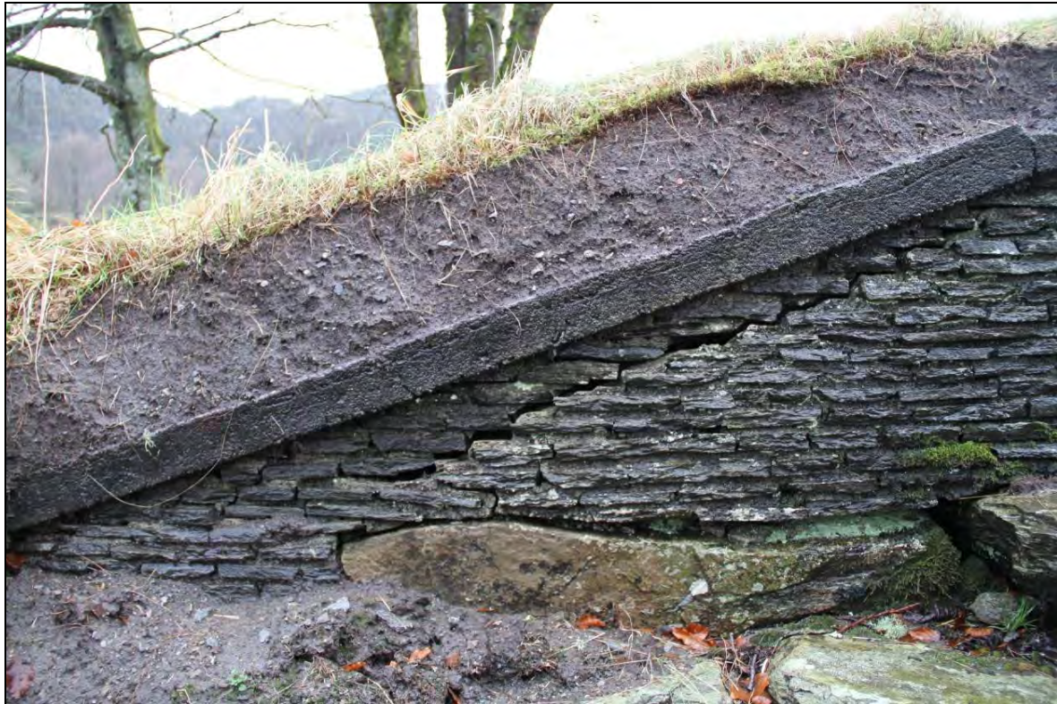
Figur 212: Skade i innerlivet i nordmuren, rom 11. Sprekken er også tydelig i ytterlivet (foto: Byantikvaren 2012).
