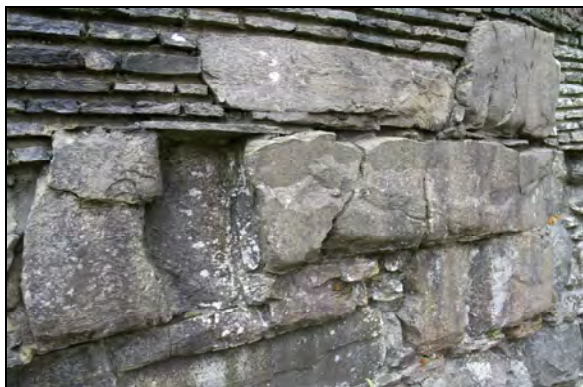
Figur 44: Brannskadet stein i innerlivet i nordmuren i kirken (foto: Byantikvaren 2011).
