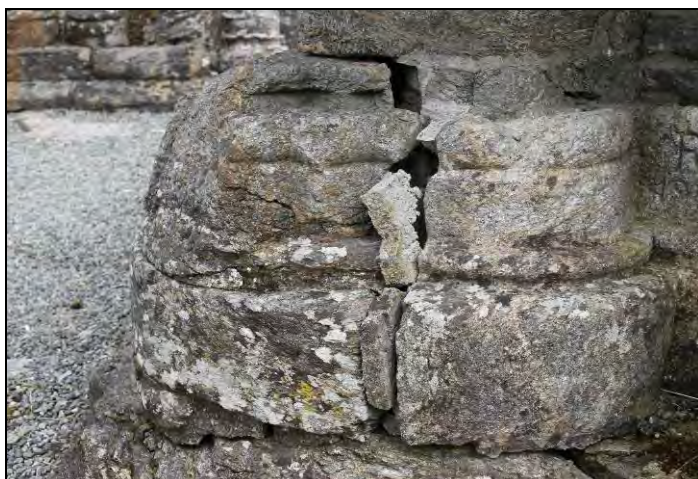
Figur 131. Sprukne sementfuger i baseprofilen i sørlig vange i sørportalen (foto: Byantikvaren 2011).
