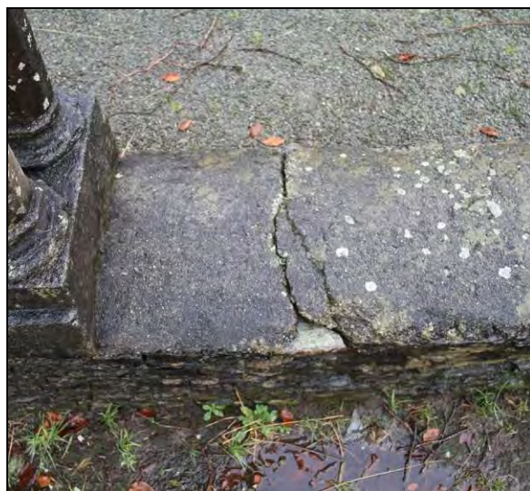
Figur 184. Sprekkdannelse i sementoverdekningen i brystningsmuren ved arkaderekken (foto: Byantikvaren 2011).
