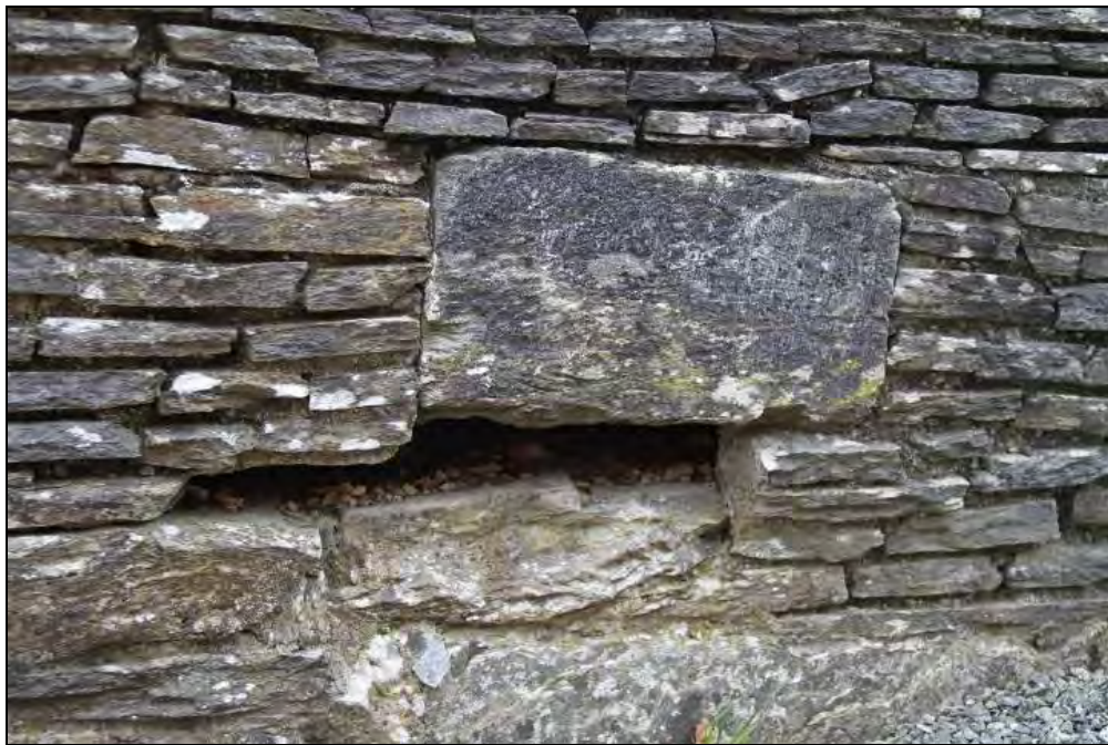
Figur 139. Skade i ytterlivet i sørmuren (foto: Byantikvaren 2011).
