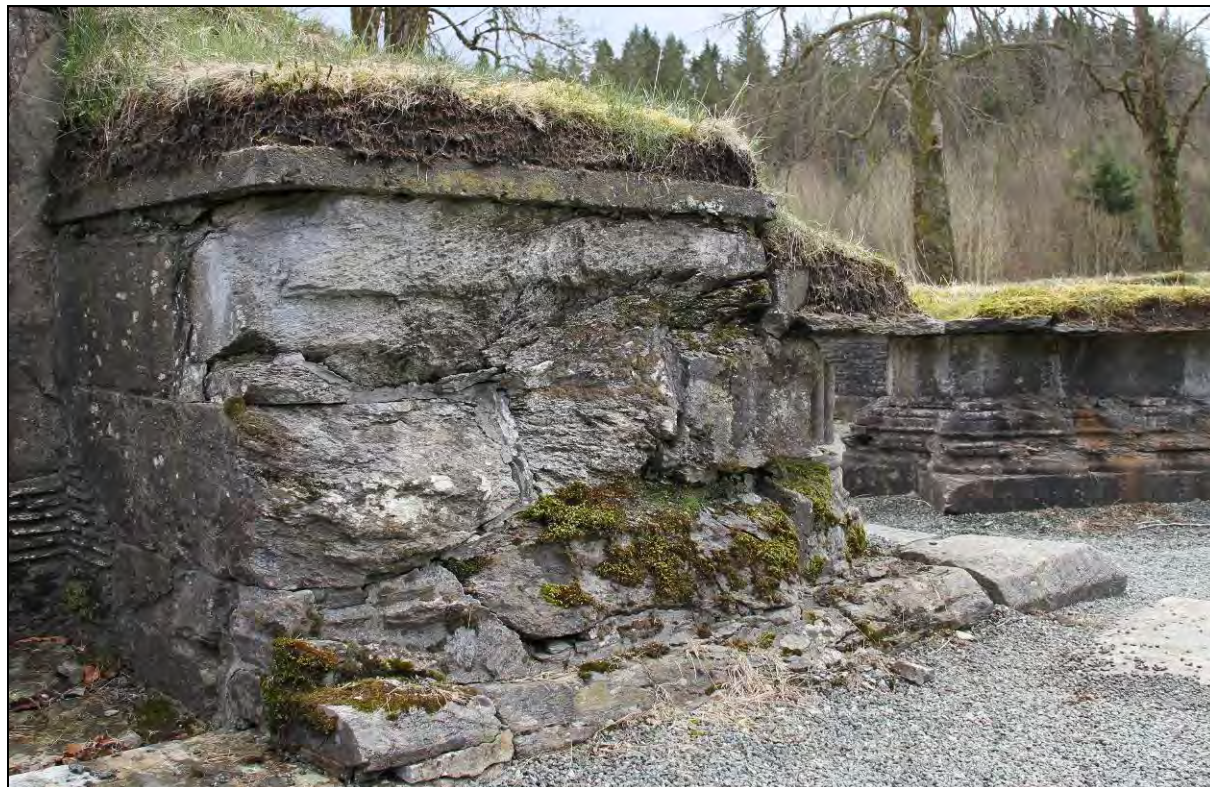
Figur 124. Ytterlivet nord for nordportalen er svært skadet med forvitring i kleberstein og fuger (Foto: Byantikvaren 2012).
