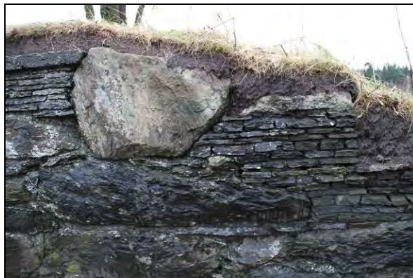
Figur 147. Avtrapping i murkronen i innerlivet på østmuren. foto mot Ø (foto: Byantikvaren 2011).
