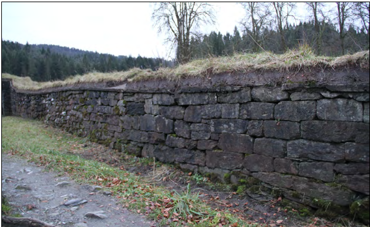
Figur 12. Bildet viser i ytre murliv i langmuren mot nord i kirken. Murlivet ble rekonstruert med stein som lå løst omkring, uten bruk av sementmørtel. Murlivet består hovedsakelig av kleberstein hvorav flere er satt inn feil vei (foto: Byantikvaren 2010).
