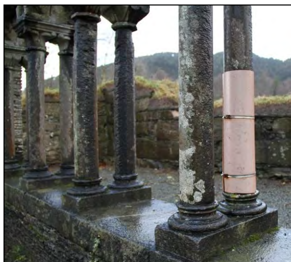
Figur 182. Skaden er midlertidig sikret med plastrør og slangeklemmer (foto: Byantikvaren 2008).
