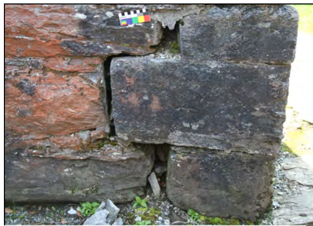
Figur 79: Sprukne fuger i innerlivet ved portalen (foto: Byantikvaren 2012)
