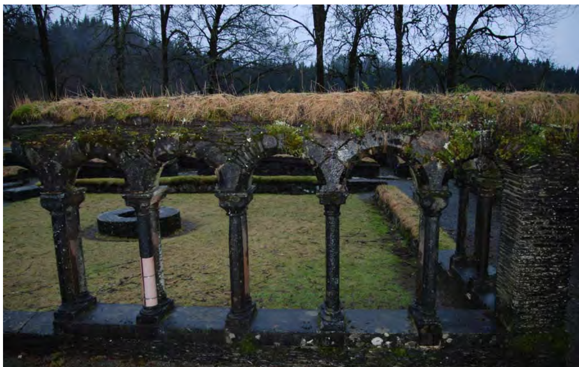
2005/22.04-063 Bildet viser hvordan gresset henger ned over murverket og leder vann inn i muren.
