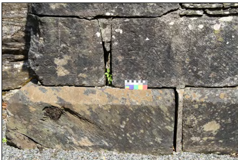
Figur 71: Oppsprukne sementfuger i pilaster ved nordmuren (foto: Byantikvaren 2011).
