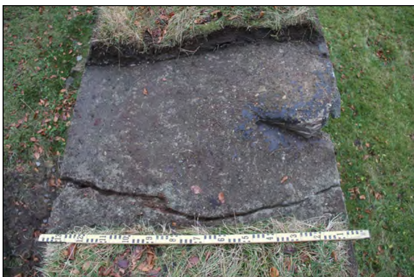
Figur 19. Etter å ha fjernet torvdekket enkelte steder ble tversgående sprekker i sementoverdekningen påvist. Merk restene etter tjære på sementen rundt steinen til høyre. Fra nordre langmur i kirken - Rom 1 (foto: Byantikvaren 2011).
