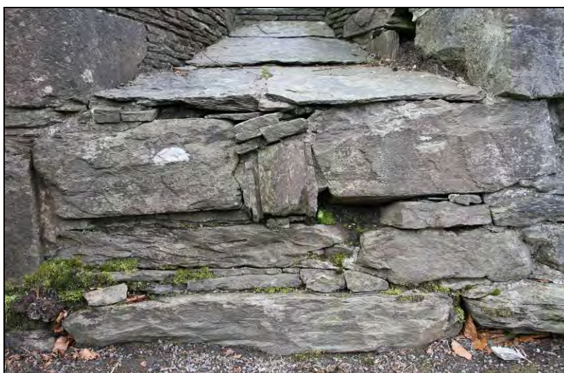
Figur 162. Murverket omkring vindusåpningen har omfattende skader (foto: Byantikvaren 2011).
