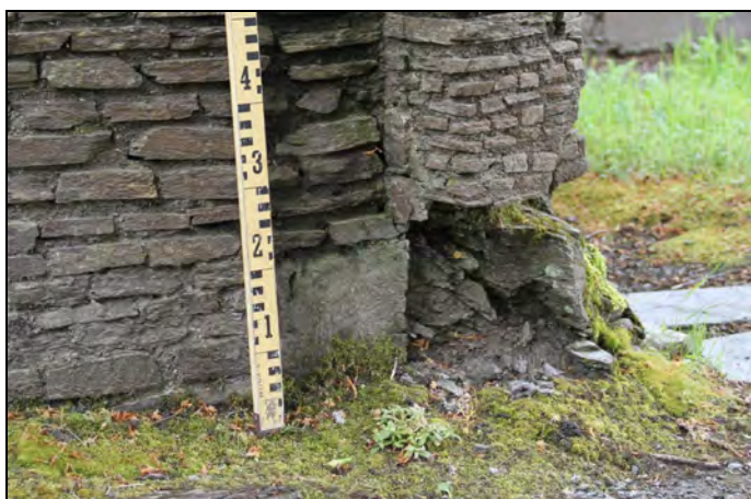
Figur 46: Skadet kleberstein i portalen lengst vest i sørmuren (foto: Byantikvaren 2012).
