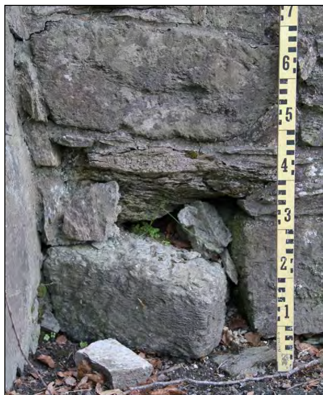
Figur 222: Skader i østlig murliv, helt sør i M5 med sprukne fuger og løs stein (foto: Byantikvaren 2012).
