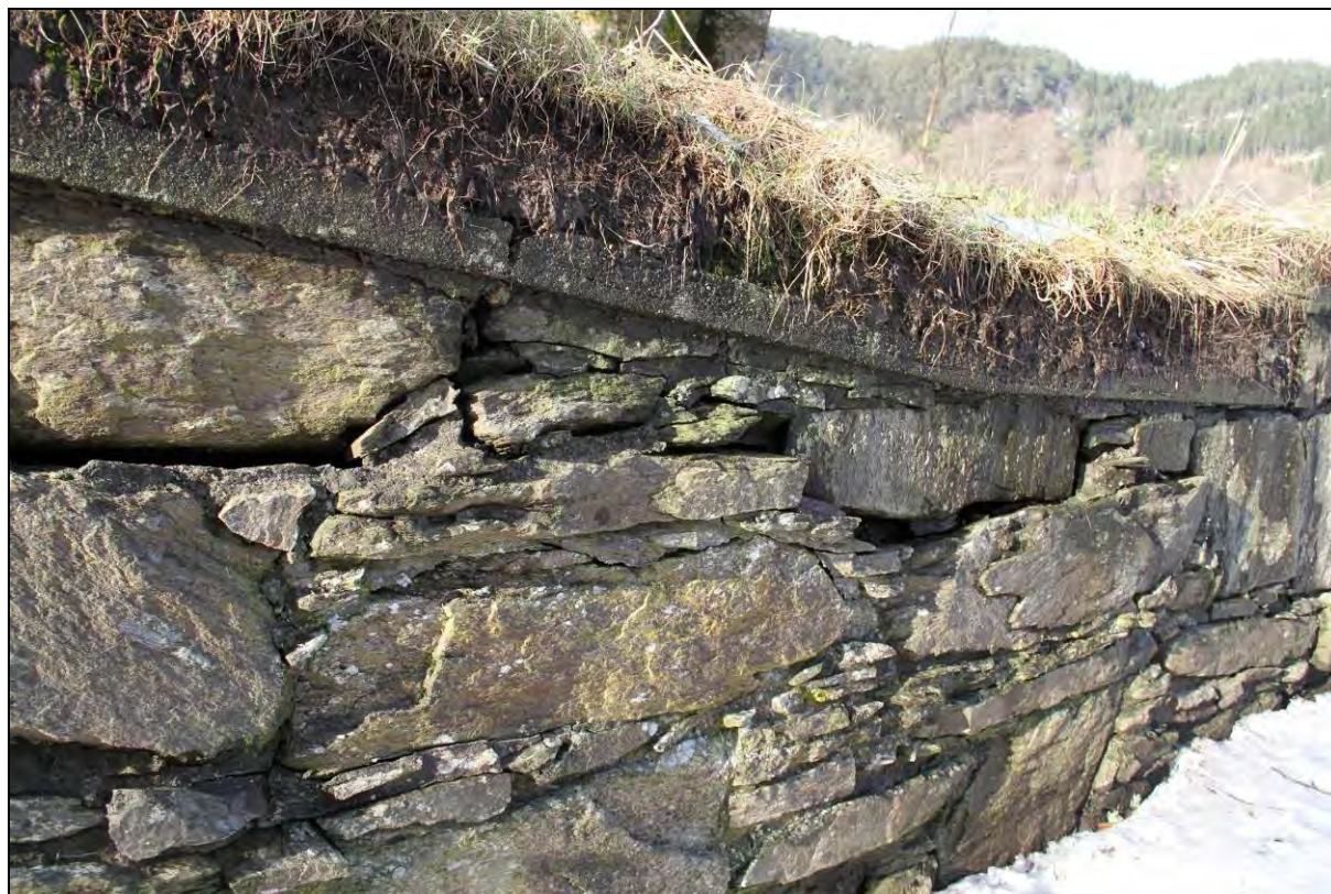
Figur 191. Tilstanden til vestmuren er særlig dårlig på midten, der hvor den er lavest. Her er det mye sprukne murfuger og løse steiner i murlivet (foto: Byantikvaren 2011).
