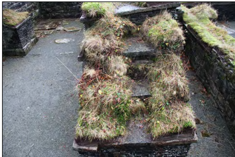
Figur 21. Slitasje etter tråkk på avtrappinger i murkronen. Fra sørmuren i søndre kapell - Rom 3 (foto: Byantikvaren 2011).
