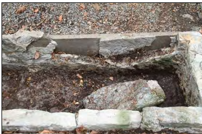
Figur 81: Marktrykk har ført til at sideveggene i en av gravene er ødelagt. Graven er tidligere forsøkt reparert med en helle i bakkant (foto: Byantikvaren 2011).
