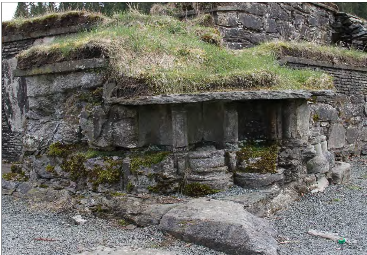
Figur 126. Basen i nordre portalvange er i svært dårlig forfatning. Et murskift er bevart over basenivå (foto: Byantikvaren 2011).
