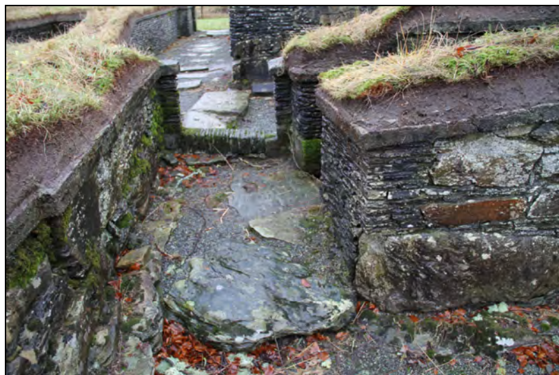
Figur 226: Døråpning helt nord i M7 som har ført inn til trapperommet fra munkenes refektorium (foto: Byantikvaren 2012).
