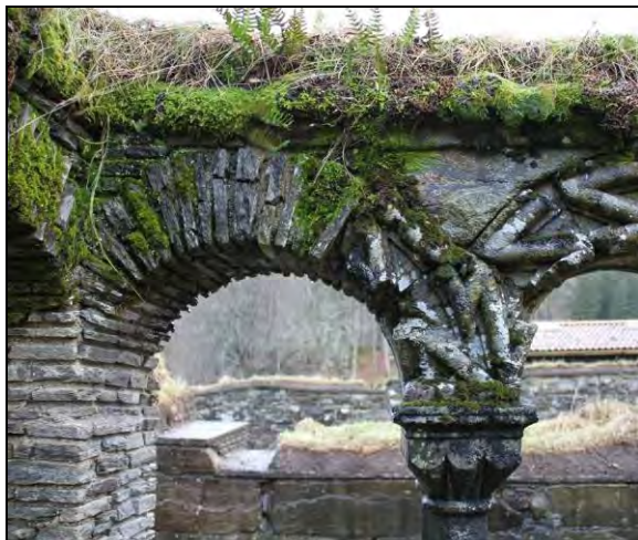
Figur 176. I buene er opprinnelig kleberstein i direkte kontakt med sementmørtel i rekonstruksjonene (foto: Byantikvaren 2008).
