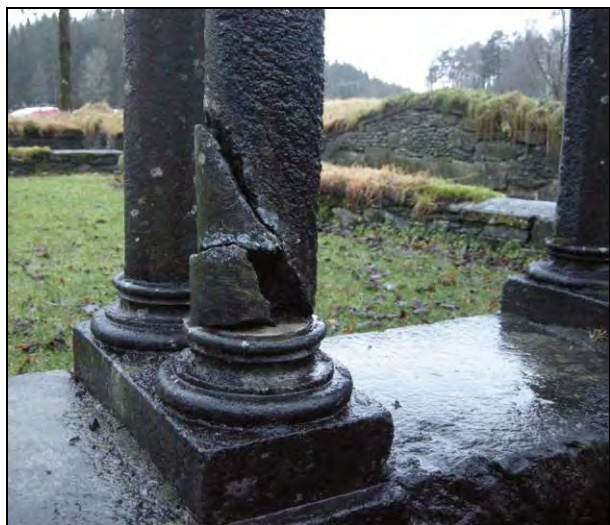
Figur 181. Skadet klebersteinssøyle i arkaderekken (foto: Byantikvaren 2008).
