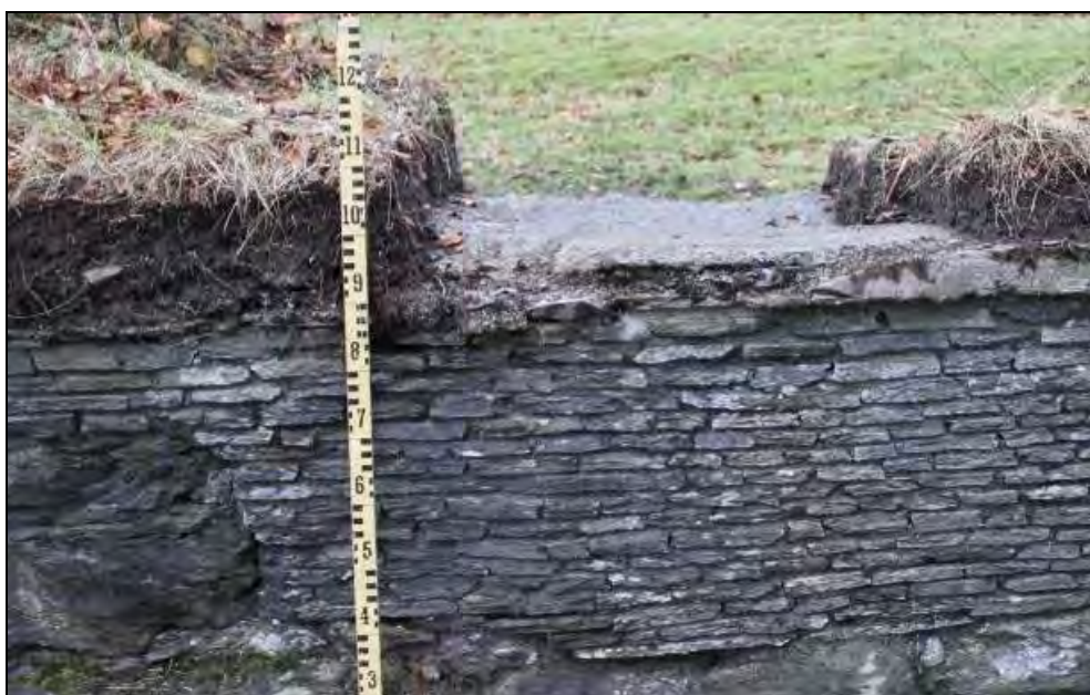
Figur 153. Avdekning av sementkappen på murkronen avslørte sprekker i dekket og oppløsningstendenser i sementen. Bildet er av innelivet i østmuren (foto: Byantikvaren 2011).
