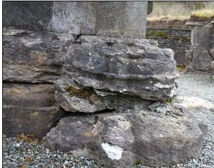
Figur 130. Skadet baseprofil i utspringet til portalene i kapittelsalen (foto: Byantikvaren 2011).
