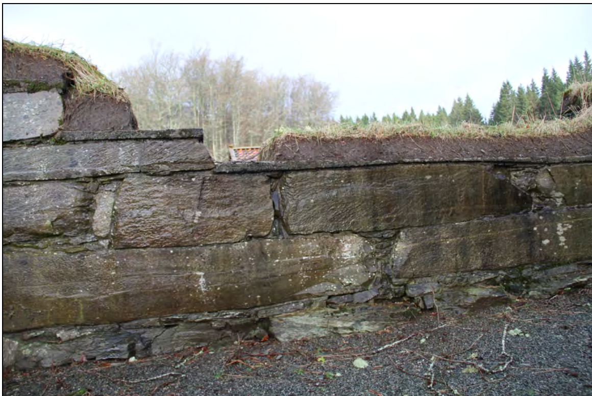
Figur 15. Store bruddstein med glatt vissflate i jevne skift, i ytterlivet i kirkens sørlige langmur mot korsgangen (foto: Byantikvaren 2011).
