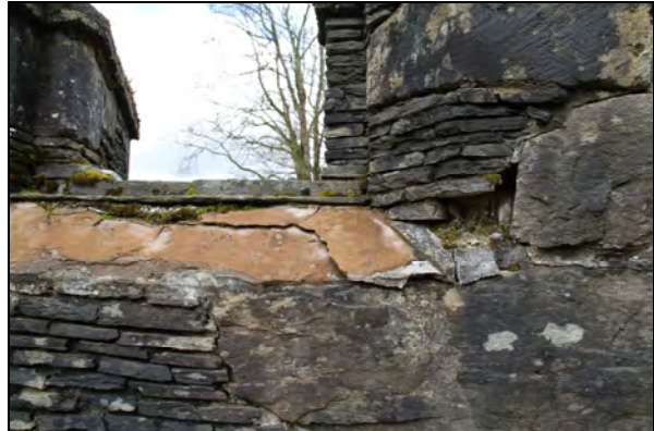
Figur 99: Skader omkring nordlig vindusåpning i ytterlivet i østmuren til sørlig kapell (foto: Byantikvaren 2011).
