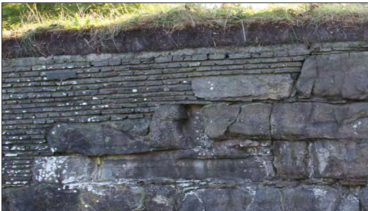
Figur 9. Den restaureringsmetoden som er mest brukt på Lyse er småsteinsteknikken. Her er teknikken benyttet for å avrette innerlivet i vestlig del av sørlig langmur i kirken (foto: Byantikvaren 2010).
