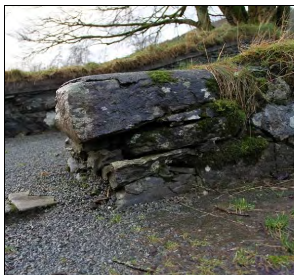
Figur 185. Skader i nordlig vange i åpningen i brystningsmuren mot nord (foto: Byantikvaren 2011).
