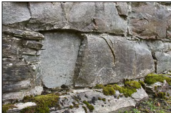
Figur 45: Brannskadet stein i innerlivet i nordmuren i kirken (foto: Byantikvaren 2011).
