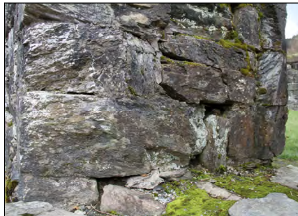
Figur 93: Murverket i vangene i døråpningen mellom søndre kapell og kirken er i dårlig forfatning med løs stein og sprukne sementfuger (foto: Byantikvaren 2012)
