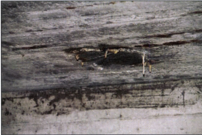
Illustrasjon 31: Lekkasje fra taket som fører til vått gulv i ruinrommet og at murverket absorberer fuktighet (Foto: Byantikvaren 2011)
