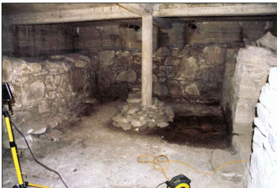
Illustrasjon 30: Oversiktsbilde av ruinen og rommet den står i, mot øst. Det fuktige området på gulvet kommer fra en lekkasje i taket (illustrasjon 31). Steinen som ligger rundt søyla ble stabledt opp i østlig vindu etter utgravningen i 1935 (Foto: Byantikvaren 2011)
