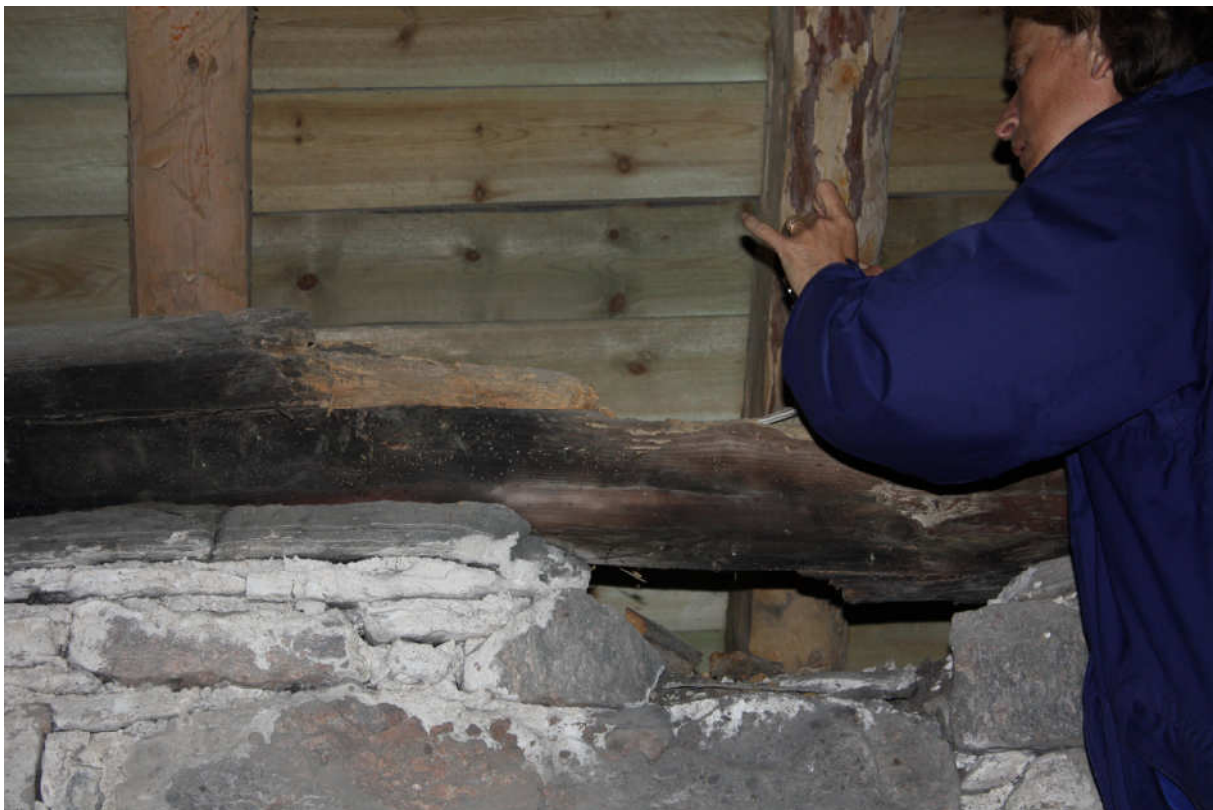
Fig.16 Foto av omtalt bjelke med råteskader på østmuren. Foto RM, 19-20.08.09.
