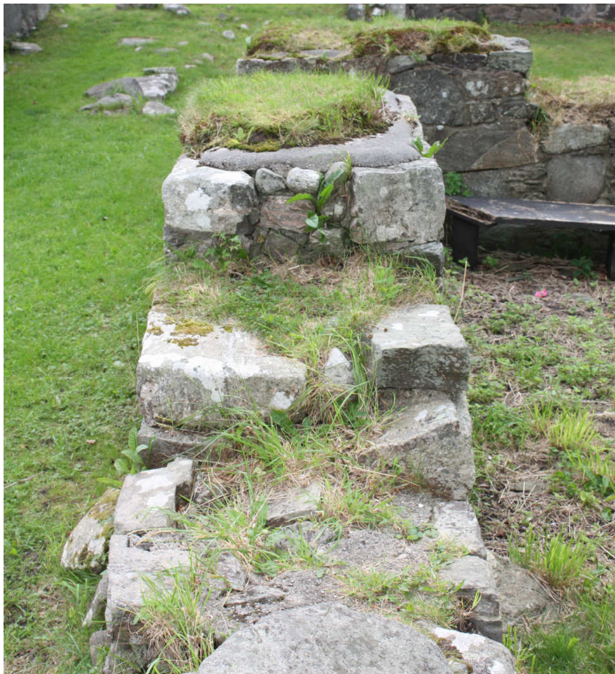
Fig.30 Normuren i S2 hvor man kan se forskjellene i toppavdekningene henholdsvis i vestre halvde (i forgrunnen) og i østre halvdel (i bakgrunnen). I østre halvdel sees de heldekkende tykke sementavdekningene på toppen av murkronen mens i vestre halvdel er avdekningen oppsprukket med vegetasjon som vokser inn i murkjernen. Foto tatt mot øst av RM, 19-20.08.09.
