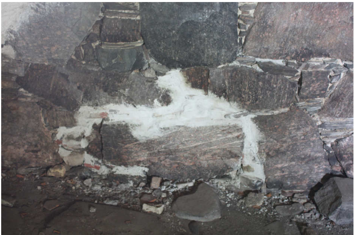
Fig. 18 Nok et tilfelle av skjemmende spekking på østmurens indre murliv like ved gulvoverflaten. Foto RM,19-20.08.09.
