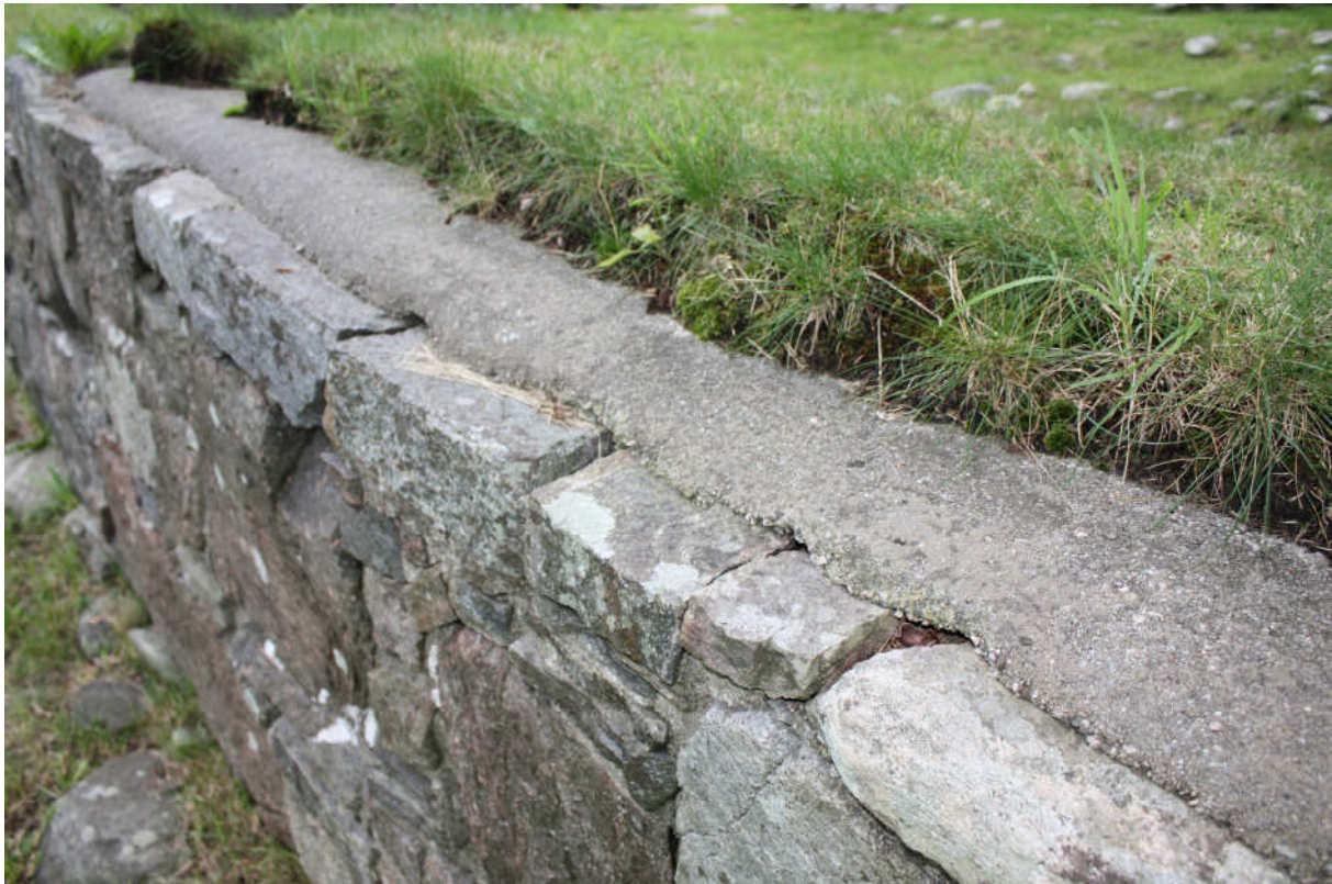
Fig.40 Toppavdekningen på nordmuren i S3. Selv om sementavdekningen på murkronen virker å være intakt så finnes det åpninger i fugene i overgangen mellom murliv og sementavdekning.
