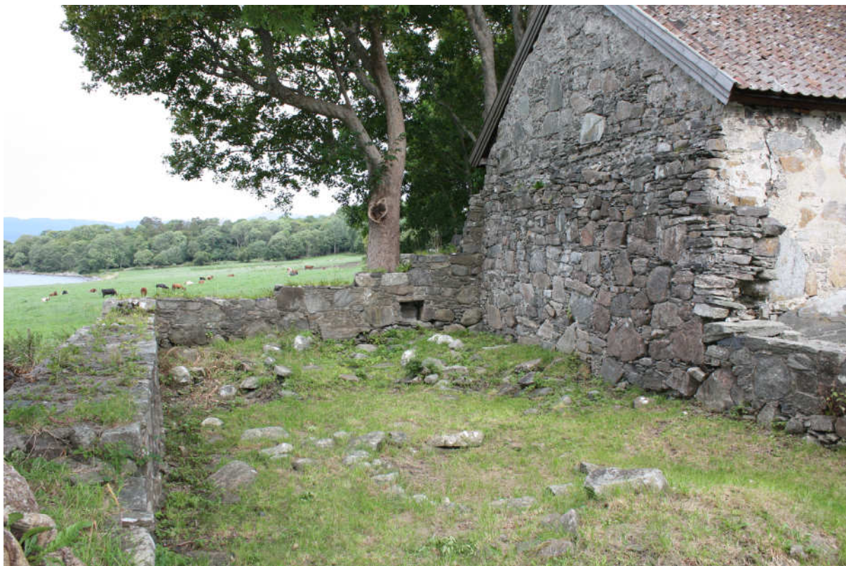
Fig.29 Fotoet viser sørmuren til venstre hvor det vokser gjennom den fullstendig oppsprukne toppavdekningen. I midten sees vestmuren med den omtalte nisjen. Fotoet viser ellers hvor overgrodd og uoversiktlig gulvet er. Foto tatt mot vest av RM.
