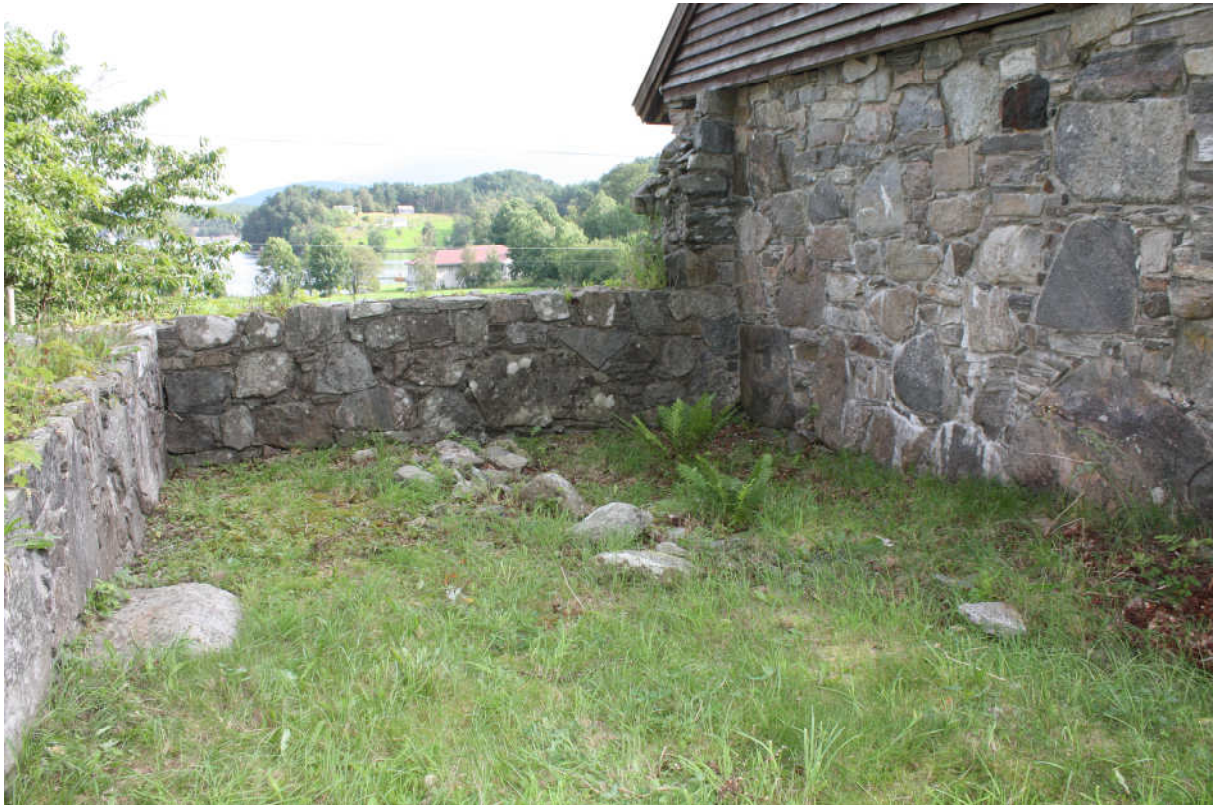
Fig.10 Nordmuren i V1. Til høyre muren mot rom N3. Legg merke til steinen som ligger løst i rommet. Foto RM, 19-20.08.09.
