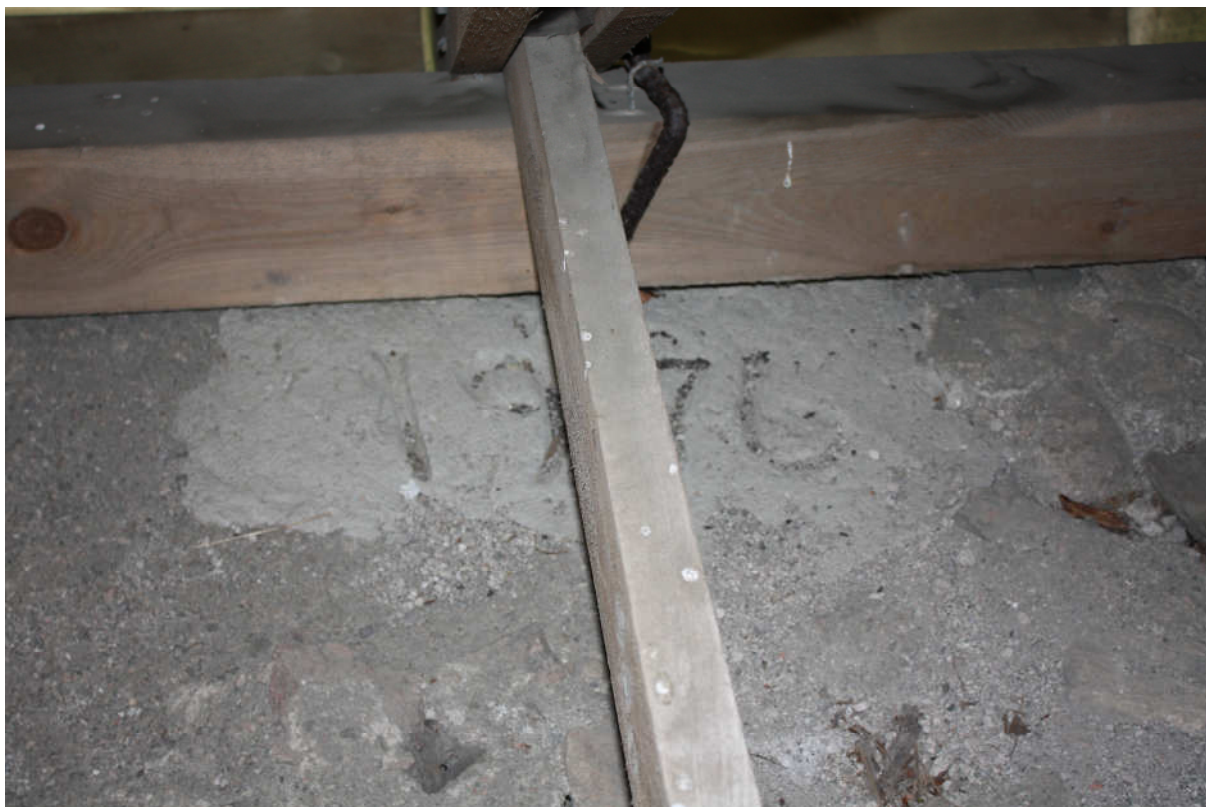
Fig.6 Sydmuren: I toppavdekningen som er murt med sement står det skrevet "1976", noe som trolig må vise til året taket ble lagt og murkronene ble utbedret. Foto RM, 19-20.08.09.
