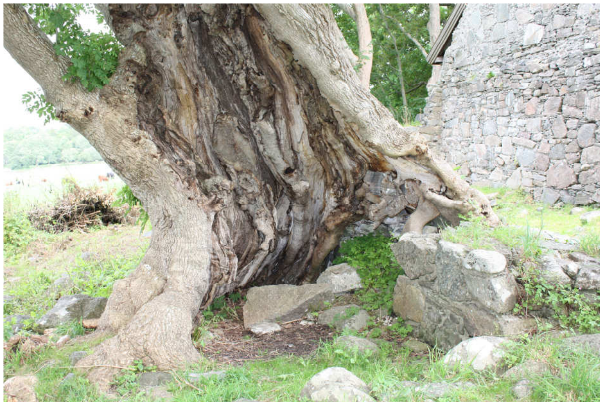
Fig. 28 Det fredede asketreet som vokser inn i sørmuren. I trestammen kan murverksteiner sees som har blitt inkorporert i stammen. Foto tatt mot nordvest av Foto RM, 19-20.08.09.
