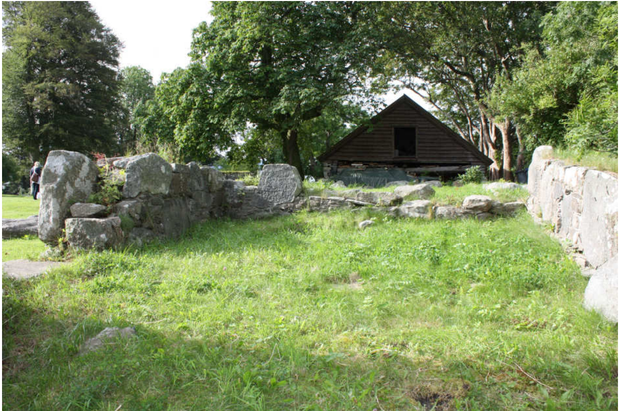
Fig.9 Sørmuren i rom V1. Til venstre sees søndre dørvange hvor det vokser godt med vegetasjon. I høyre kant kan stå stor stein som har løsnet fra murverket. Foto: Foto RM, 19-20.08.09.
