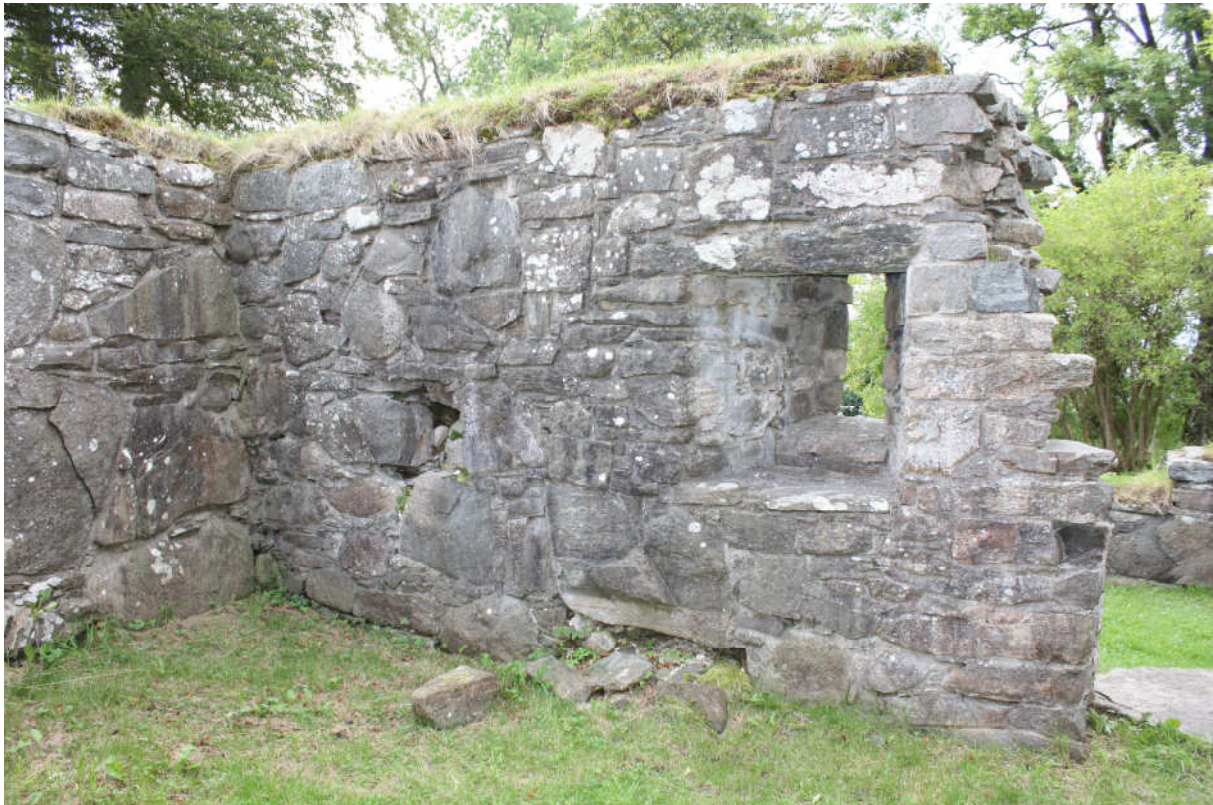
Fig.22 Sørsmurens indre murliv hvor det har rast ut stein to steder og hvor det vokser vegetasjon i dag. Til høyre sees det brutte murverket i østre dørvange. Foto tatt mot sørøst av RM, 19-20.08.09.
