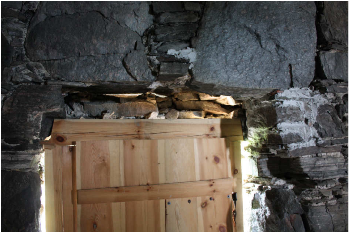
Fig.17 En ikke tilfredsstillende utført konservering med sementmørtel ved dørpartiet i vestmuren. Foto RM,19-20.08.09.
