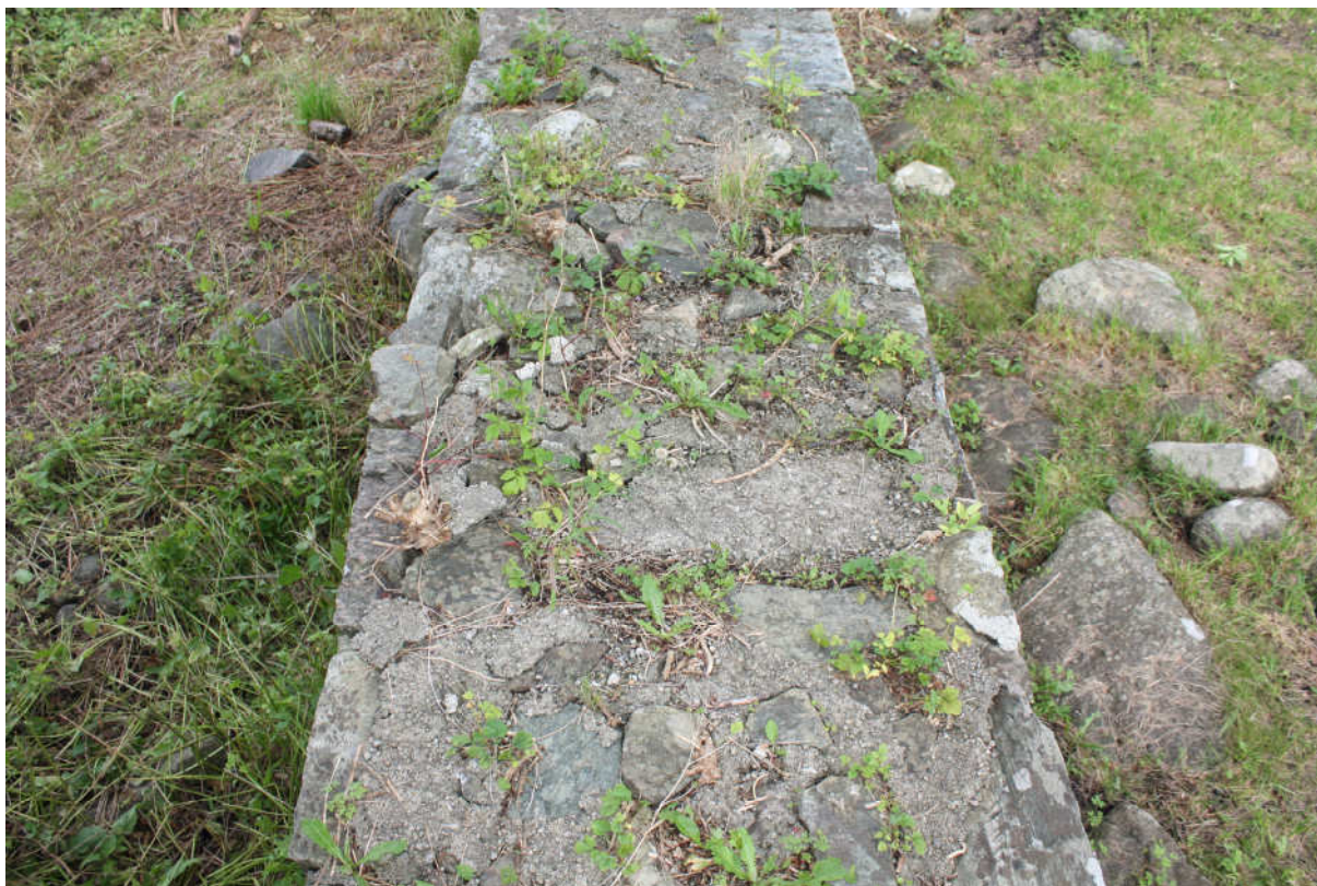
Fig.29 Oppsprukket toppavdekning på sørmuren. Foto RM, 19-20.08.09.
