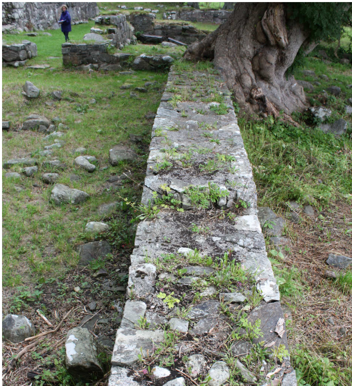
Fig.41 Det er et gjennomgående problem med sprekker i toppavdekningen i murverket på rom S1. På fotoet sees sørmuren med det fredede asketreet i bakgrunnen. Foto tatt mot øst av RM 19-20.11.09.
