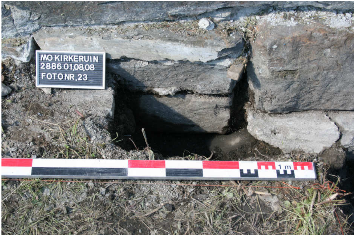
Til venstre to skift i det opprinnelige fundamentet. Til høyre fundamentsålen. Sprekk mellom disse. Foto: NIKU, tatt mot nord.
