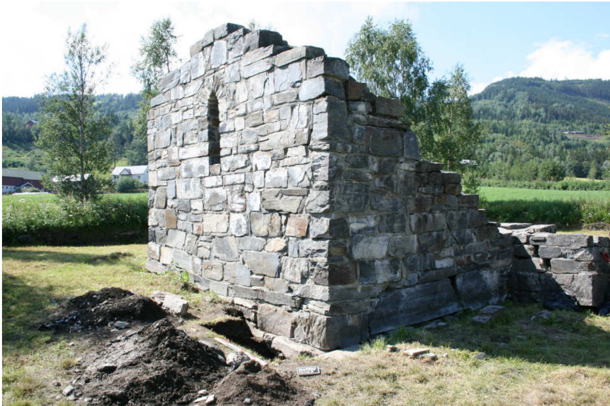
Korets nordøstre hjørne etter endt forundersøkelse. Sjakten ble dekt til med bjelker og planker med en bølgeplikkplate over. Hjørnet og sjakten ble så sperret av. Foto: NIKU, mot SV.
