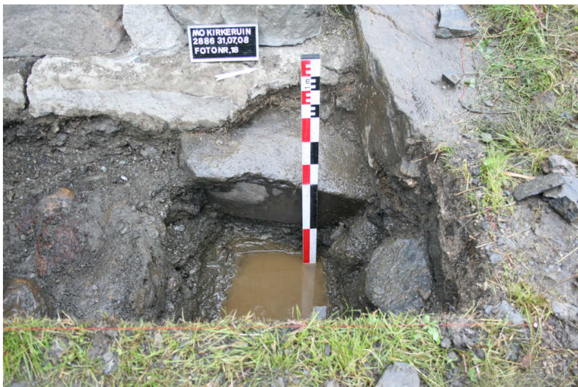
En stor fundamentstein ble avdekket under den støpte fundamentsålen. Den har stor helling nedover og må ha beveget seg ut av sin opprinnelige stilling, trolig på grunn av setninger. Steinen fortsetter inn i nordre profilvegg, under den øst-vestorienterte steinen som er synlig i overflaten øverst til høyre. Foto: NIKU, tatt mot vest.
