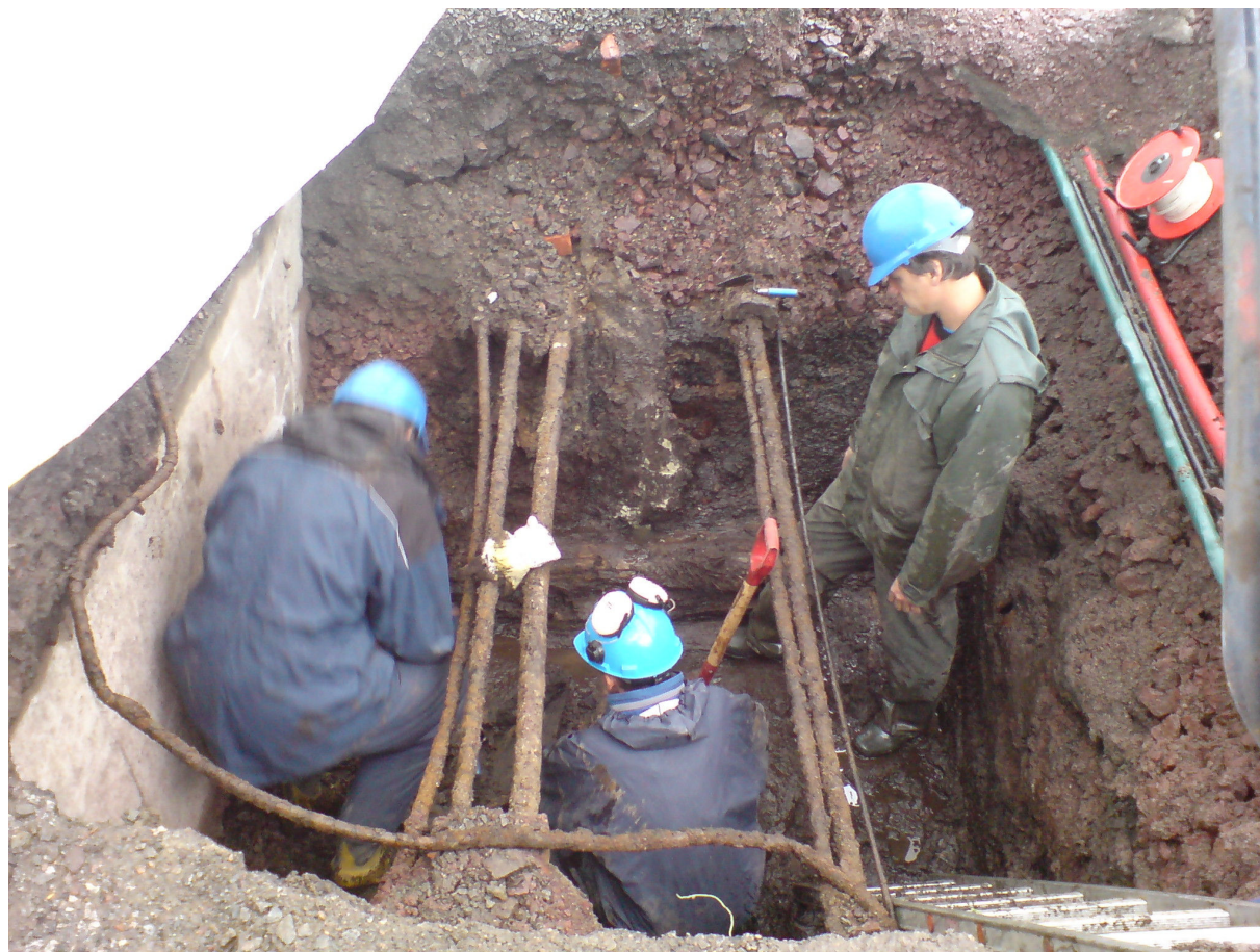
Figur 11. Tollbugaten Tønsberg, nordøstre profil. Feltarbeidet omfattet undersøkelser av eventuelle skader etter pel. Prøveserien viste at det ikke var skader ved pelen, men derimot at fyllmassen etter grøftearbeid til diverse kabler og rør hadde en sterkt drenerende effekt på kulturlagene.
