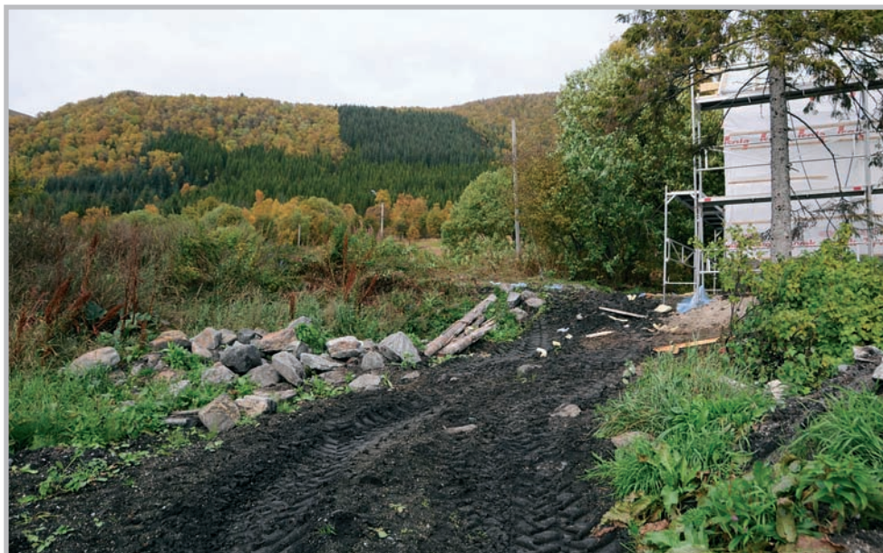
Figur 18. Id 7899-1, gårds- haug som er berørt av byg- gearbeid. Foto: Elin Rose Myrvoll, NIKU 2008.
