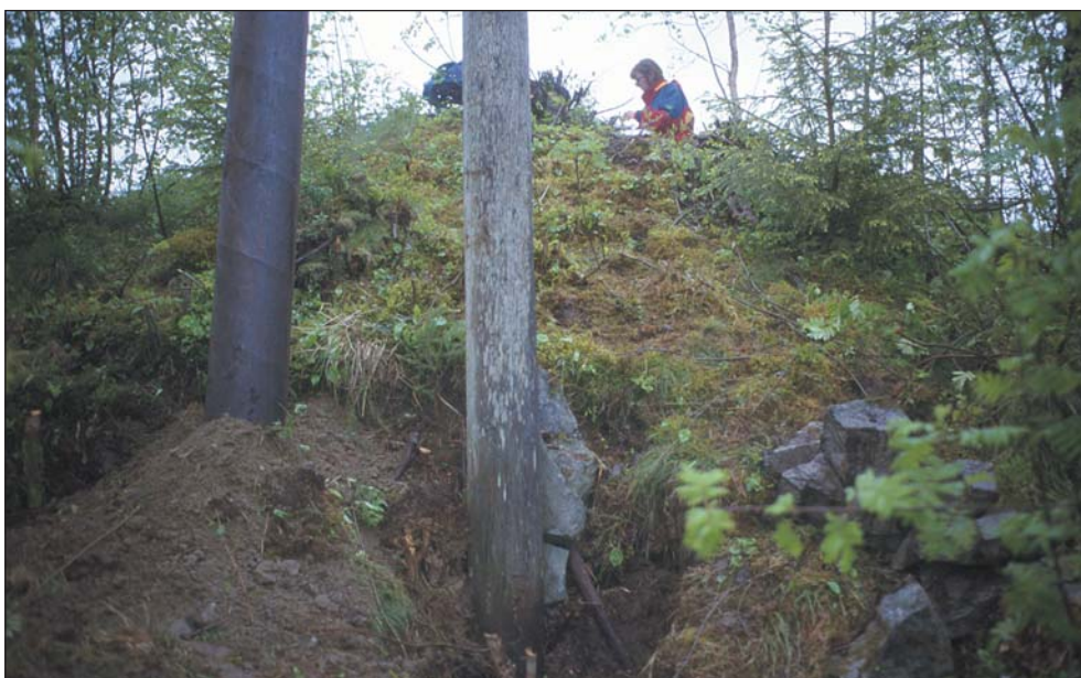
Figur 16. En gammel kraftledningsstolpe er i ferd med å bli erstattet av en ny, noe som krever bedre fundamentering og dermed også ytterligere inngrep i en gravhaug (ID-nr 10365).
