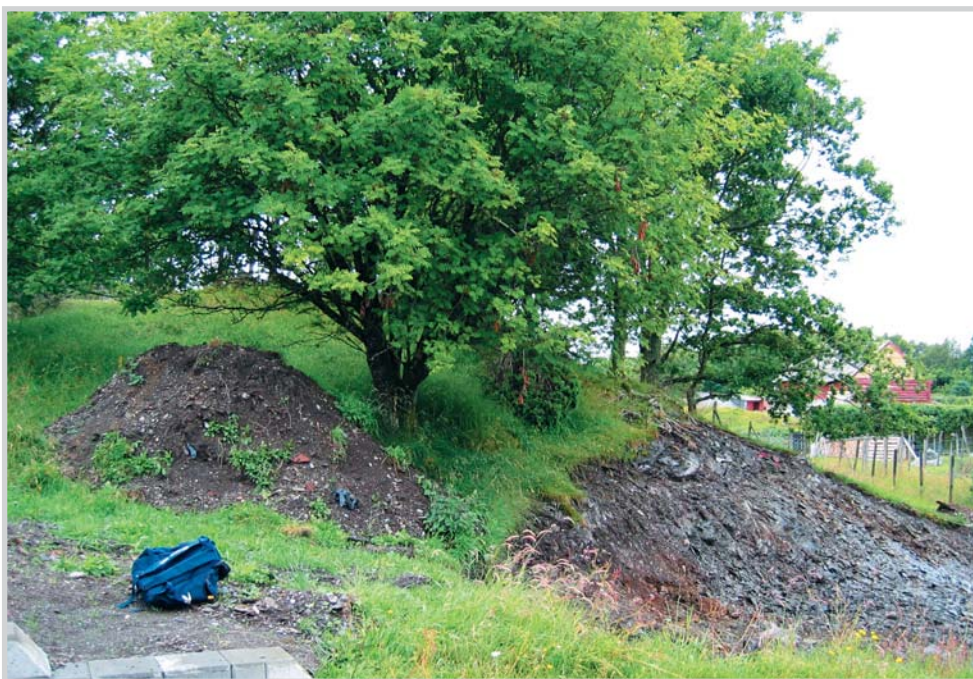
Figur 16. Jord er avskavet opp mot foten av en gravhaug (bak rognetreet i forgrunnen) for å sprengte bort berg til plass for garasje (ID-nr 00350).
