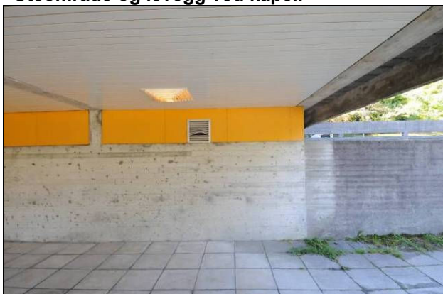
Inngangsparti kapell, forvitringsspor i betong
