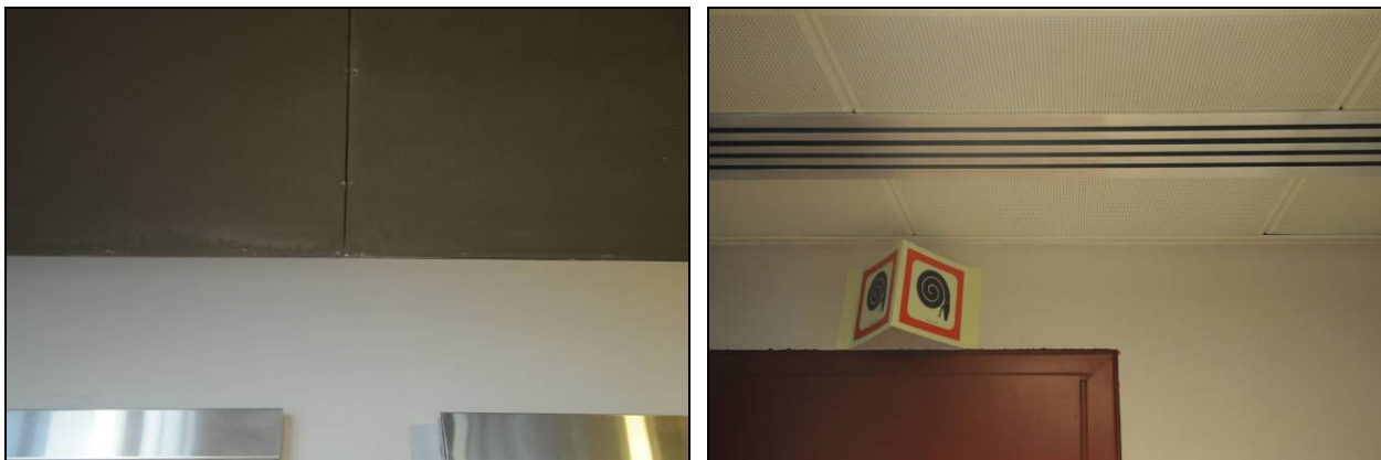
Nedsenket systemhimling i perforert aluminium med og uten ventilasjonsrister
