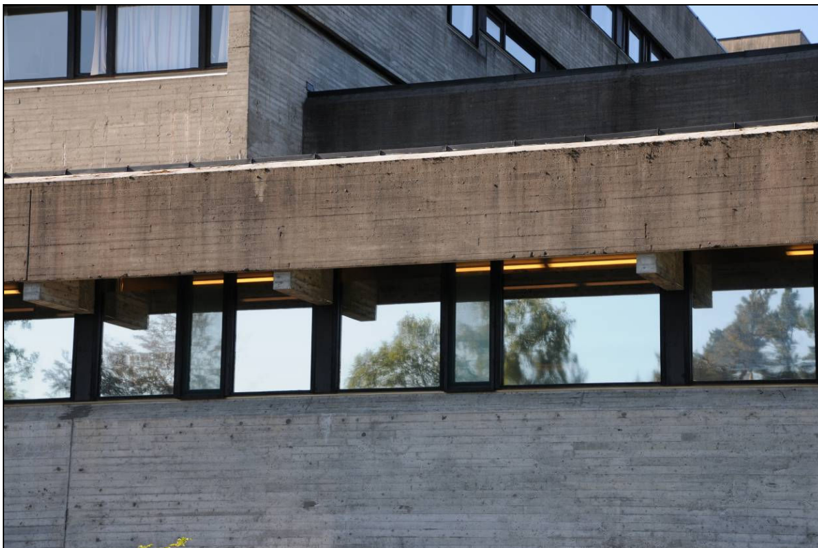
Mosegrodde sykehusfasade i øst
