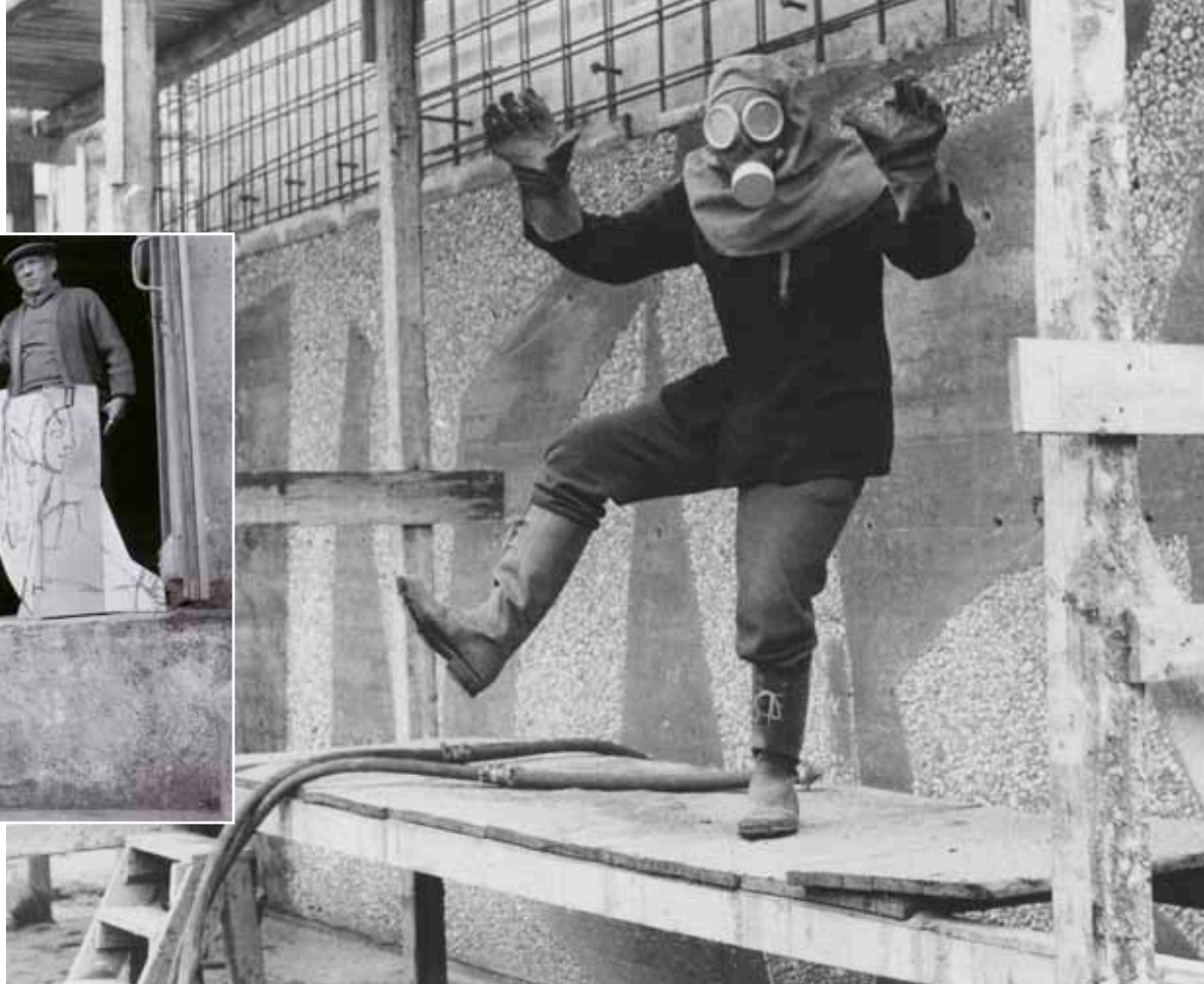
«Arbeidet gikk som en lek». Carl Nesjar i verne drakt – sørveggen i første etasje under arbeid. Fotograf: Trolig Inger Sitter. Foto © Nasjonalmuseet for kunst, arkitektur og design.
