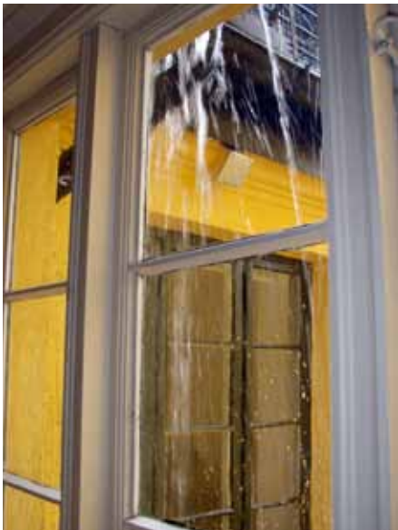
Å holde takrenna i orden vil bli enda viktigere i våtere klima. Foto: Siri Hagen © Riksantikvaren
