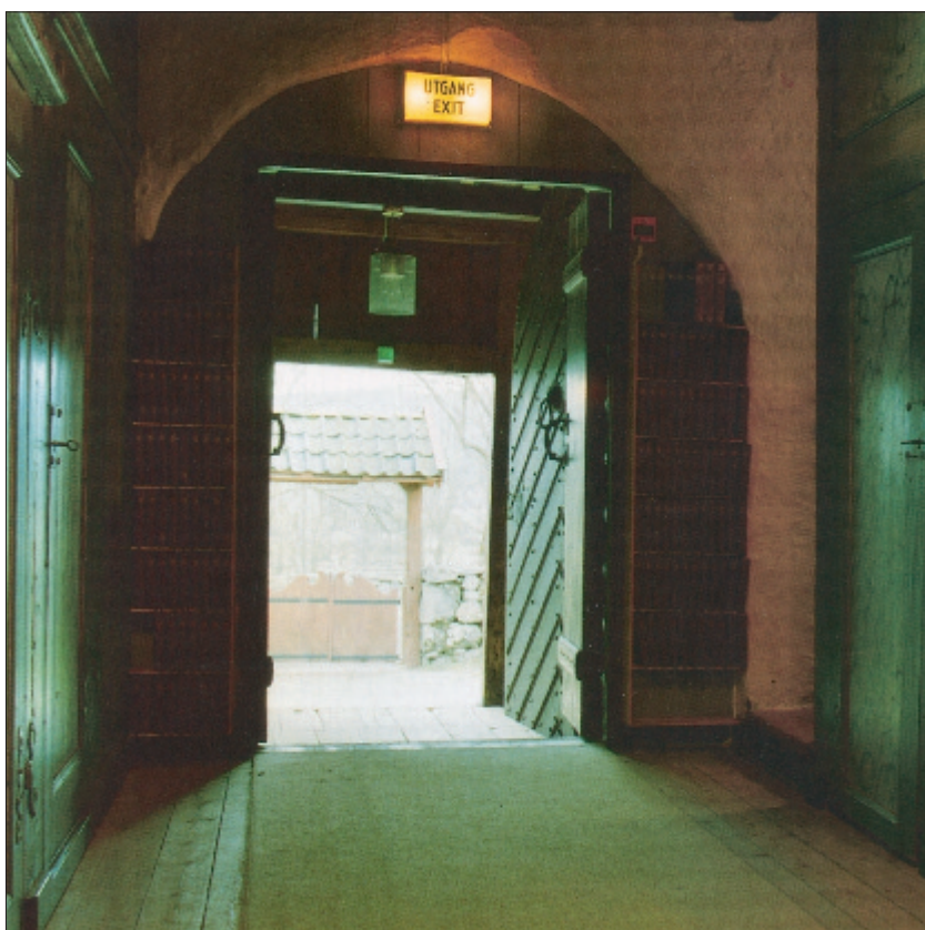
Markeringslys i Tanum kirke, Bærum kommune. Datering ukjent. Eksempel på hvordan markering ikke bør utføres. Dessverre er dette en vanlig løsning i mange kirker.
