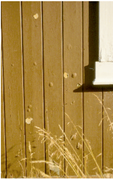
Linoljemalingen har den egenskap at gasser innenfra kan presse opp blærer. Det kan skyldes at grunningen er for «fet», slik tilfellet er her. Det er viktig å påføre malingen etter oppskriften magert – halvfett – fett. Det vil si at både grunningstrøket og et eventuelt mellomstrøk skal tynnes med white spirit, mens toppstrøket påføres uførtynnet. Maling i sol og sterkt varme kan føre til at det hurtig dannes en sterk hinne på malingens overflate, noe som også kan føre til blæring. Unngå derfor å male mens veggene er solbelyst. Foto: Jon Brønne, NIKU.
