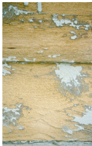
Sandblåsing er ikke en metode vi vil anbefale når alle malinglag skal fjernes. Behandlingen går hardt ut over treverket ved at de bløtere deler av veden forsvinner, mens de harde delene står igjen.
