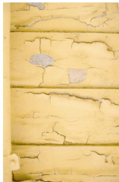
På mange hus er det brukt forskjellige typer maling opp gjennom årene. Eksempelvis kan et hus som opprinnelig ble malt med ren linoljemaling, ha blitt overmalt flere ganger med alkyd- eller akrylmaling. Det kan føre til skader som skyldes at det oppstår spenninger mellom de ulike malingtypene, slik vi ser eksempel på her. Er tilstanden riktig ille, må alle malinglagene fjernes. Foto: Jon Brønne, NIKU.
