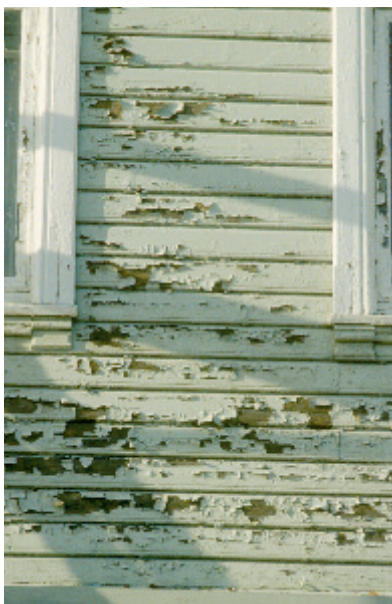
Hvis det males på fuktig treverk, kan resultatet bli som her. Mal ikke på vegger som er fuktige etter regn og dogg. Foto: Jon Brønne, NIKU.
