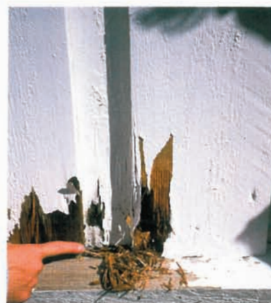
Mange av de moderne malingtypene er tette og sterke. De gir intet varsel om at noe er galt. Bak den «fine» overflaten har det samlet seg fukt og treverket har råtnet. Huset var to år gammelt da bildet ble tatt.
