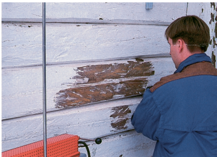
Fjerning av bløtgjort maling med skrapejern. Malingfjerning på tømmervegger er tidkrevende og må utføres med spesialoppsatte jern. Det må skrapes med vedretningen for å unngå skader i overflaten.
