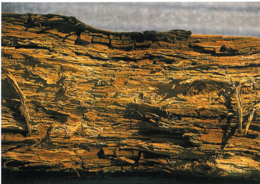
Råte i utskiftet bunnstokk. Foto: Mycoteam a.s.
